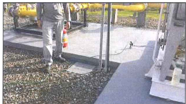
Figura 3: Aterramento do tanque de fornecimento.
