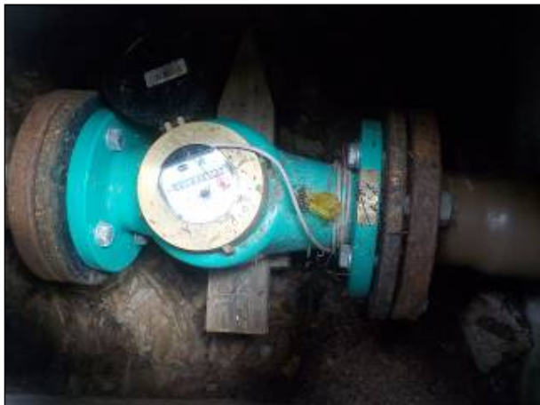
Figura 13: Detalhe do macromedidor localizado na ETA São Martinho, em funcionamento.
