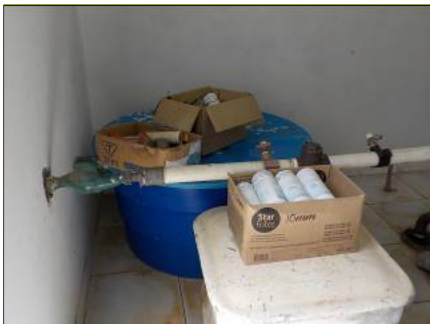
Figura 23: Produtos utilizados para o tratamento da água bruta na ETA Rio Gabiroba, devem estar em paletes e isolados
