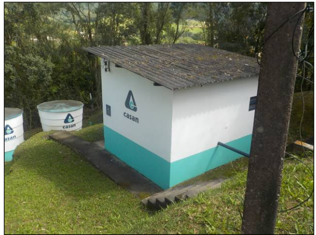
Figura 6: Vista da estrutura onde é feito o tratamento da água bruta, ao fundo parte dos reservatórios de fibra.
