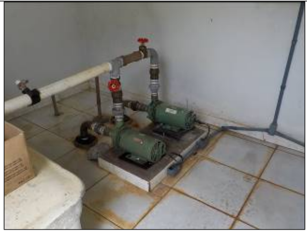
Figura 22: Detalhes das bombas que captam do poço na localidade Rio Gabiroba de 10 a 15 m 3 /dia de água bruta.
