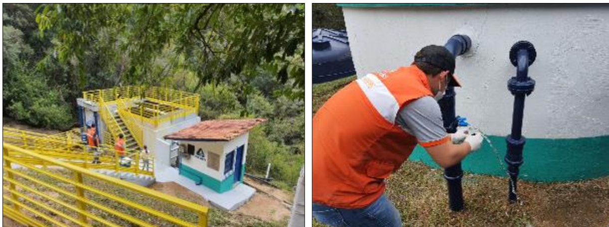
Figura 2: Visão geral da ETA São Bonifácio e coleta no reservatório - pós tanque de contato (31/08/2021).
