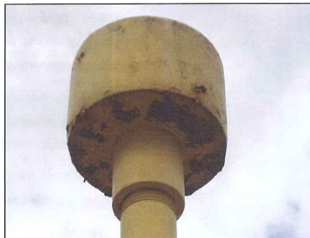
Figura 9: Detalhe da ponteira com corrosão
