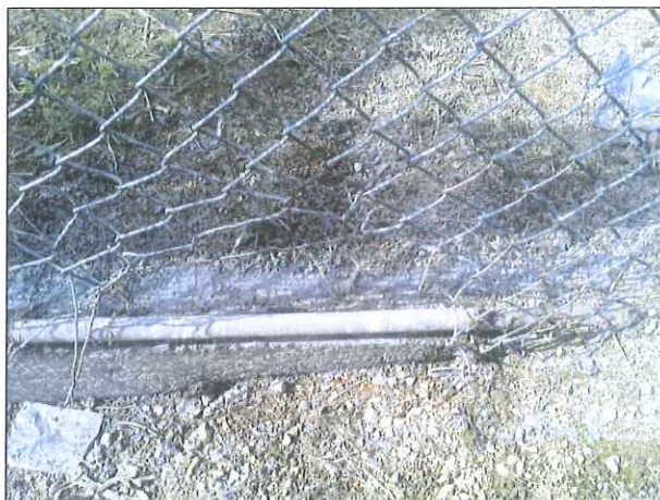
Figura 5: Tela oxidada e rompida em vários pontos
