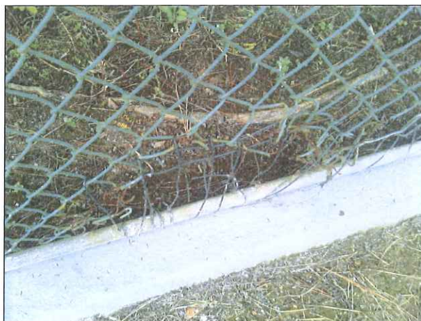
Figura 6: Tela oxidada e rompida em vários pontos
