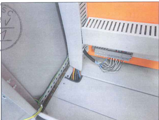
Figura 11: Entrada de cabos sem vedação
