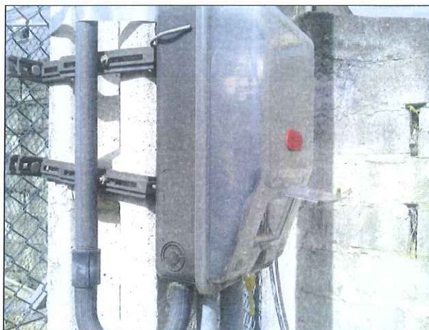
Figura 10: Medidor de energia sem cadeado
