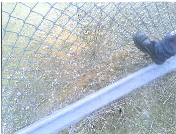
Figura 2: Falta de fixação na parte inferior da tela
