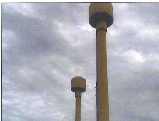
Figura 8: Ponteira com corrosão
