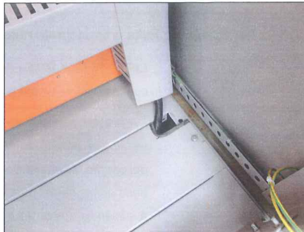
Figura 12: Entrada de cabos sem vedação
