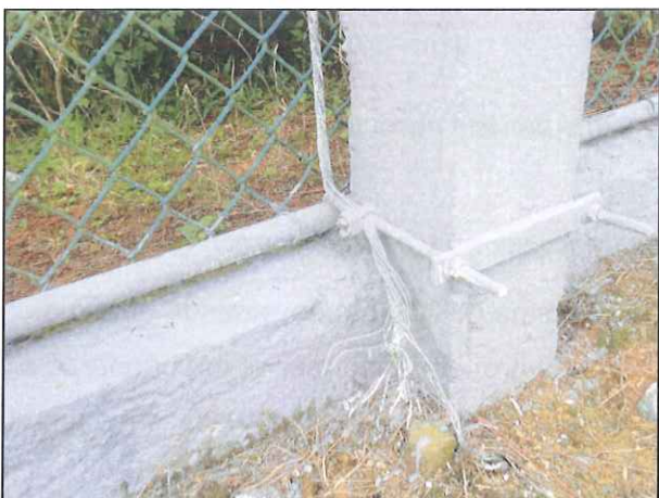
Figura 4: Cordoalha de aterramento rompida.
