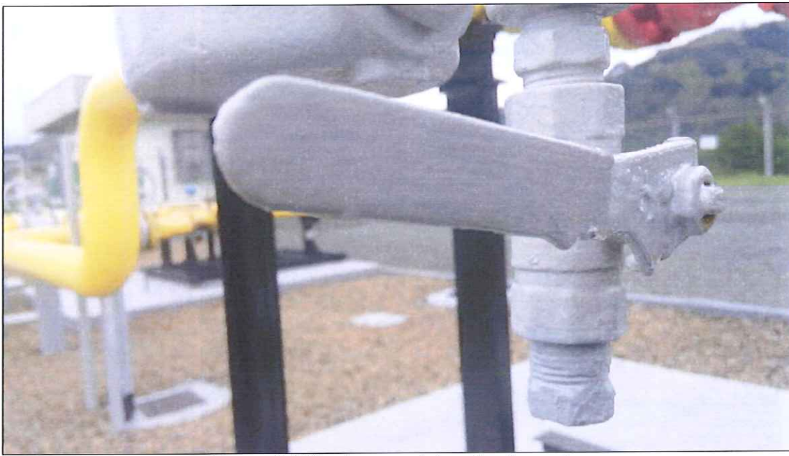
Figura 6: Válvula com pintura inadequada.
