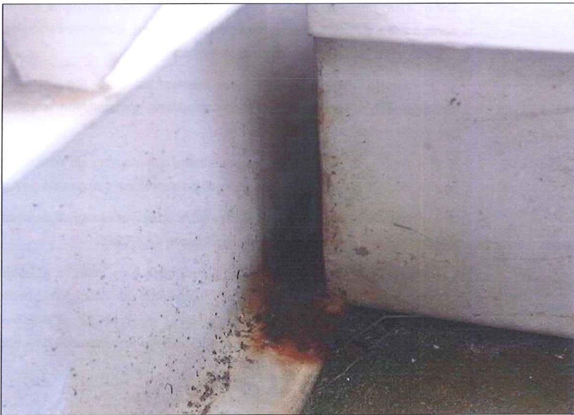
Figura 3: Corrosão na estrutura do SDO.
