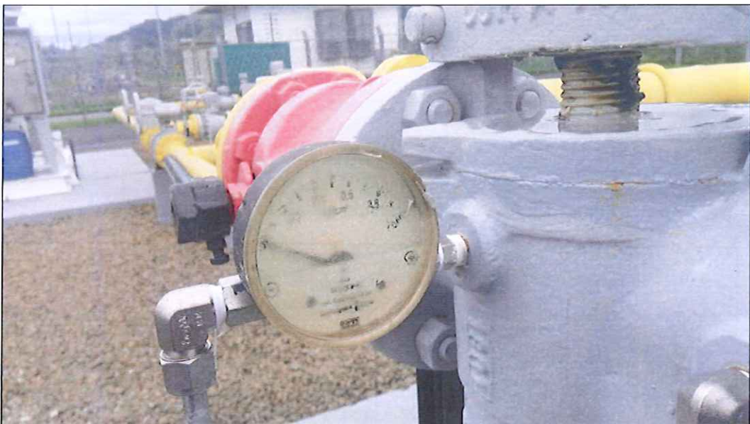
Figura 11: Manômetro com infiltração de água, dificultando a leitura.
