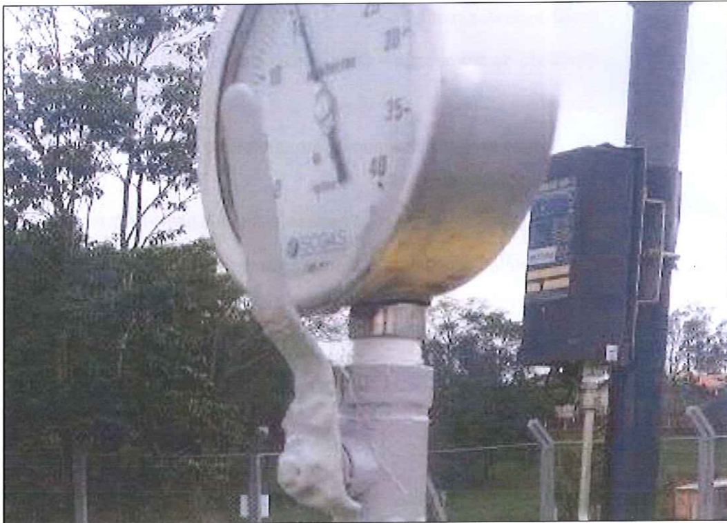
Figura 13: Alavanca de válvula instalada incorretamente.
