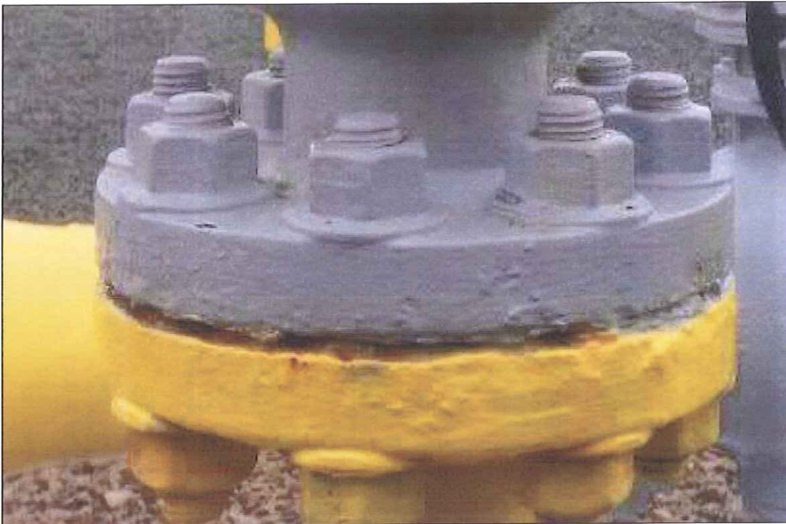
Figura 7: Conexão com pintura inadequada e com pontos de corrosão.
