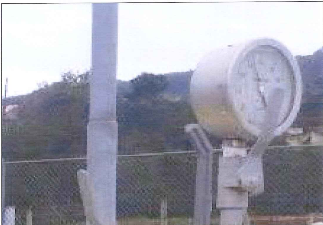
Figura 14: Alavanca de válvula instalada incorretamente.
