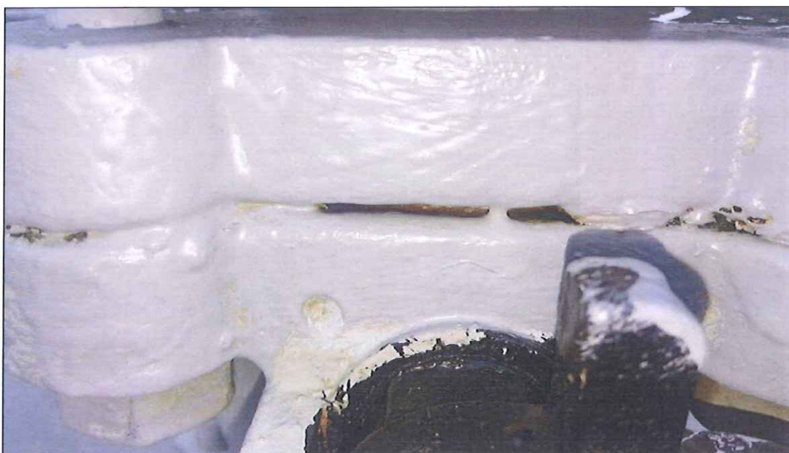
Figura 8: Conexão com pintura inadequada e com pontos de corrosão.
