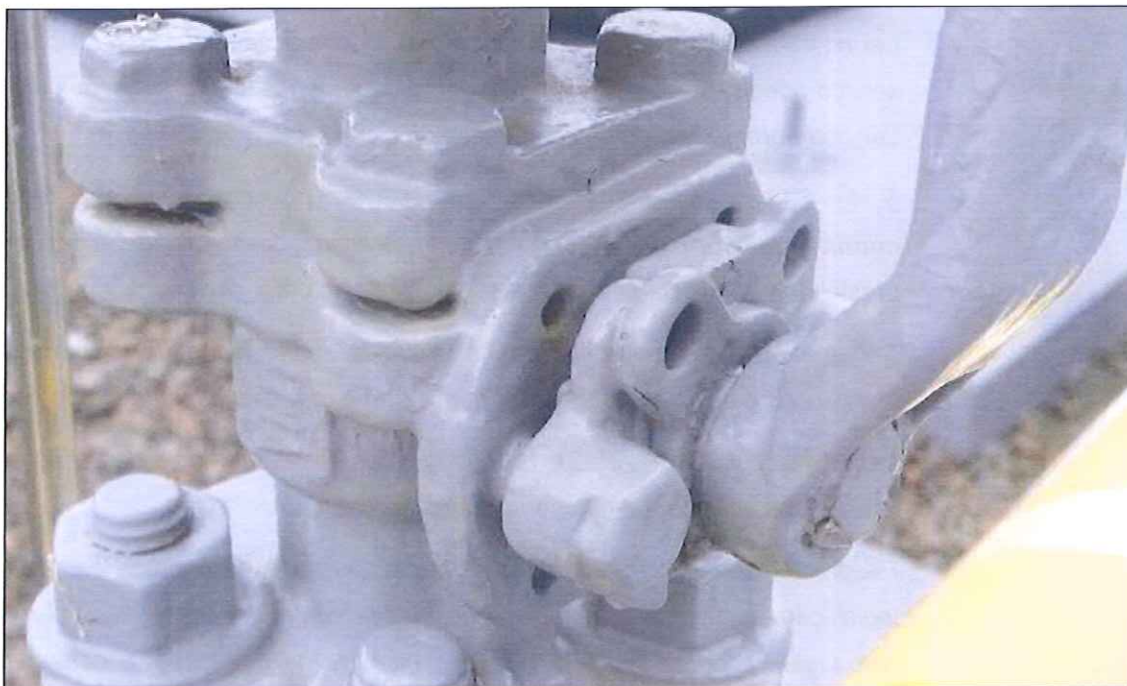
Figura 4: Válvula com pintura inadequada.
