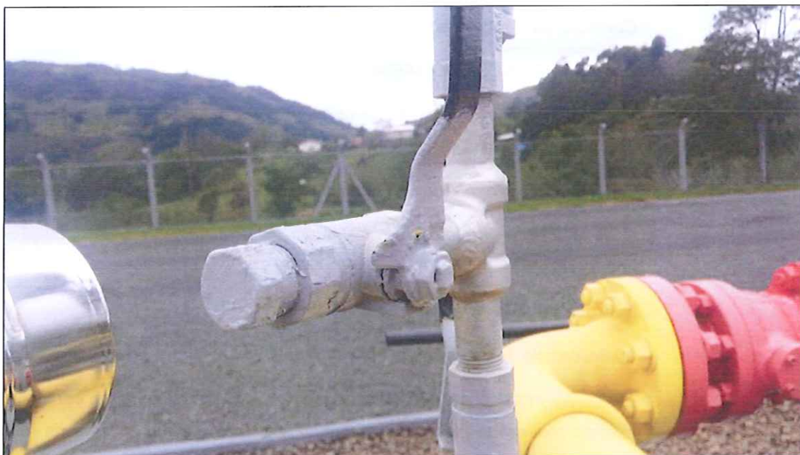
Figura 5: Válvula com pintura inadequada.
