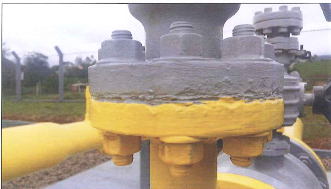
Figura 9: Conexão com pintura inadequada e com pontos de corrosão.
