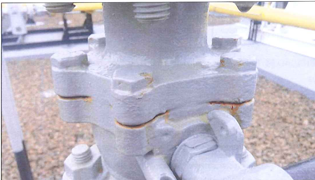
Figura 10: Conexão com pintura inadequada e com pontos de corrosão.
