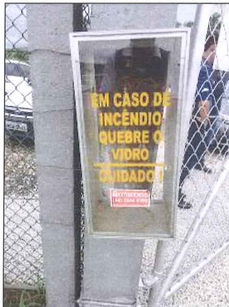
Figura 13: Falta de extintor de incêndio
