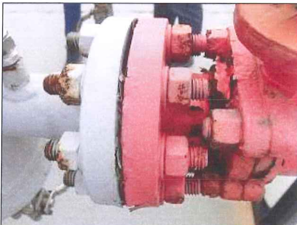
Figura 16: Conexão com corrosão
