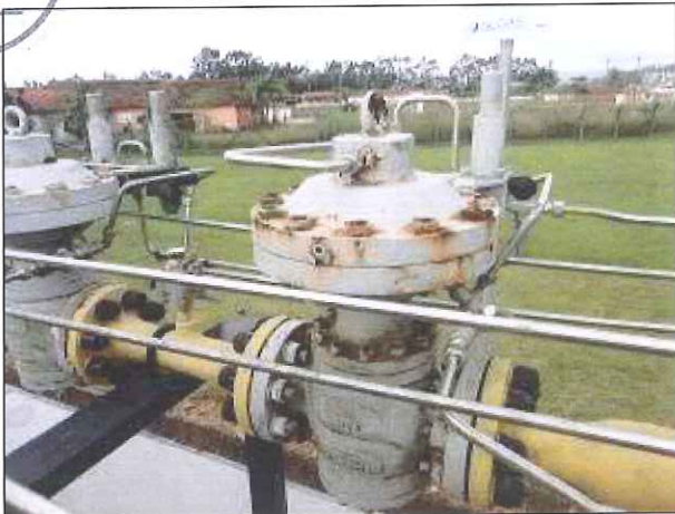
Figura 20: Válvulas com corrosão
