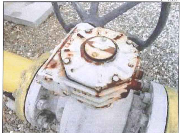
Figura 17: Válvula com corrosão
