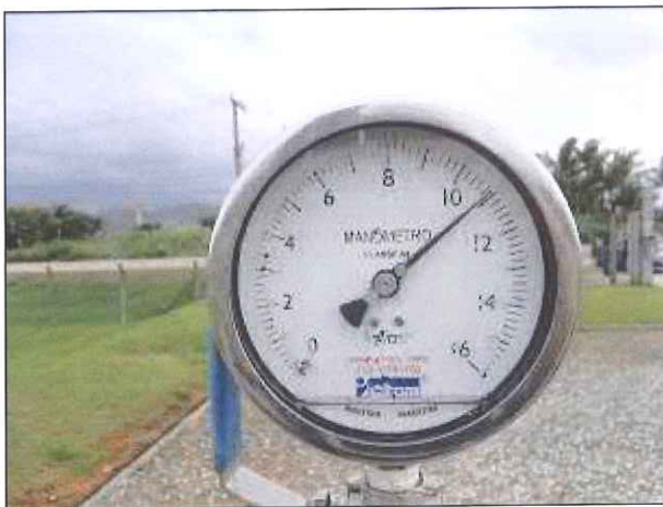
Figura 21: Manômetro com infiltração de água
