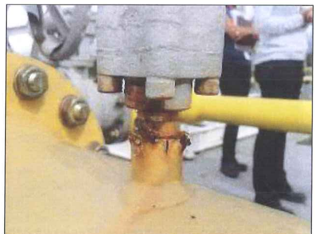
Figura 18: Conexão com corrosão
