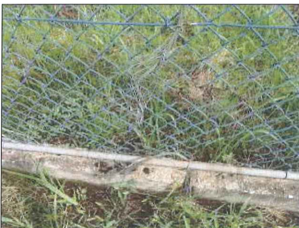
Figura 4 - Cordoalha aterramento rompida
