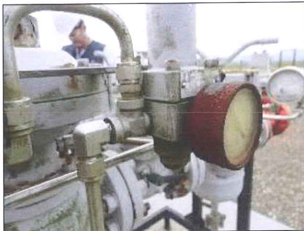
Figura 22: Manômetro com corrosão
