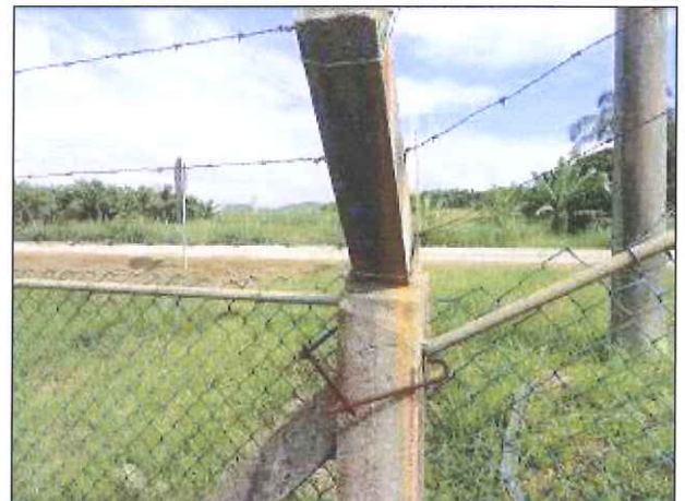
Figura 6: Abraçadeira solta e arames farpados superiores oxidados
