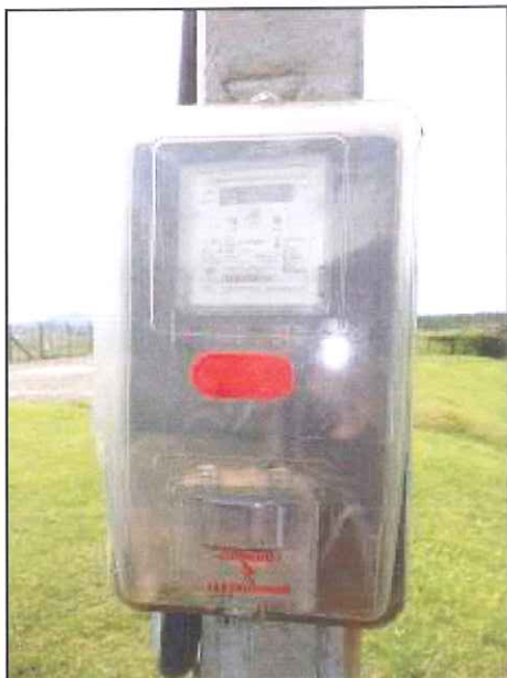
Figura 30: Medidor de energia sem cadeado
