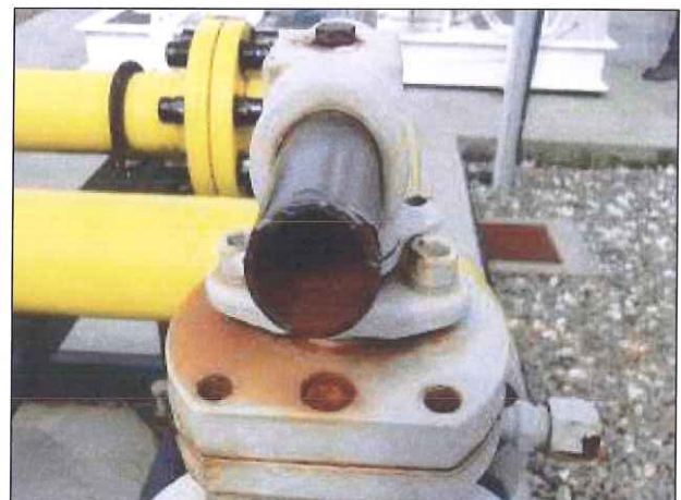
Figura 19 – Válvula e alavanca com corrosão
