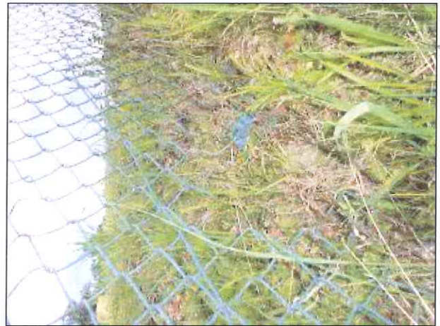
Figura 5: Tela oxidada e rompida em vários pontos
