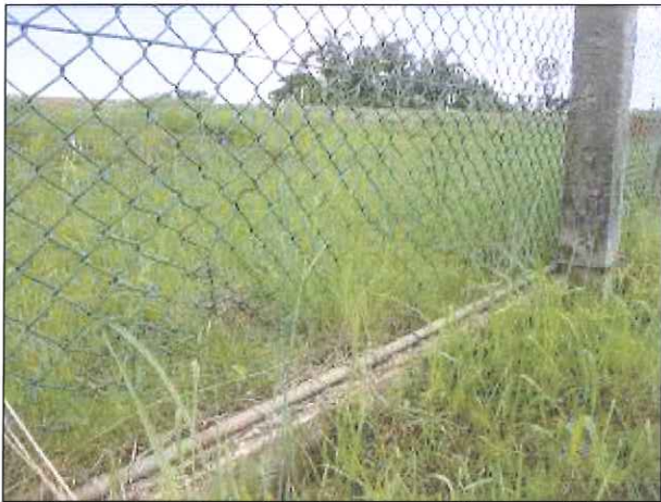
Figura 2: Tela oxidada e rompida em vários pontos
