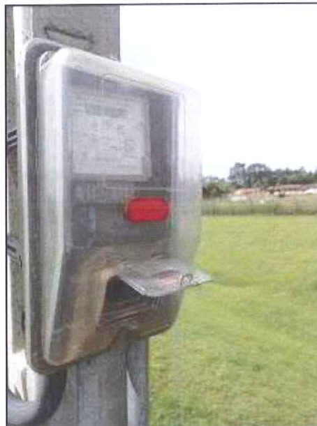
Figura 31: Medidor de energia sem cadeado
