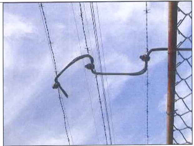
Figura 9: Conexão da cordoalha de terra aos arames da cerca está inadequada
