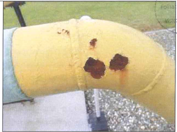
Figura 27: Tubulação com corrosão
