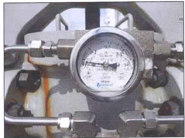
Figura 24: Manômetro com infiltração de água
