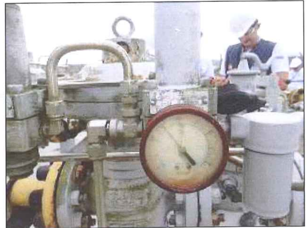
Figura 23: Manômetro com corrosão
