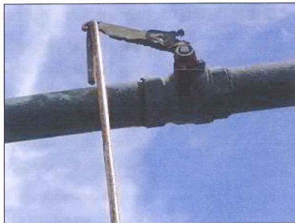
Figura 12: Válvula do lava-olhos com corrosão
