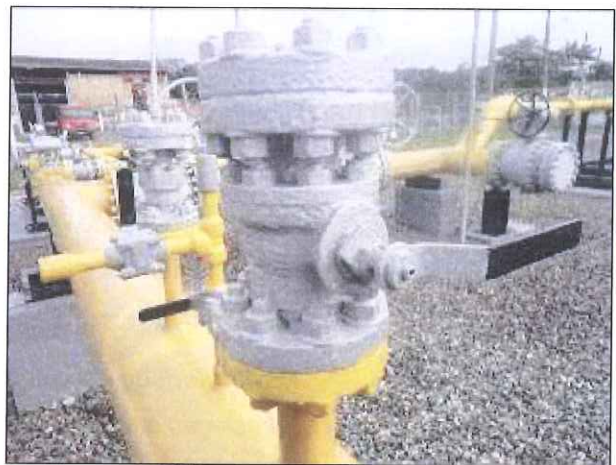
Figura 8: Válvula com pintura inadequada
