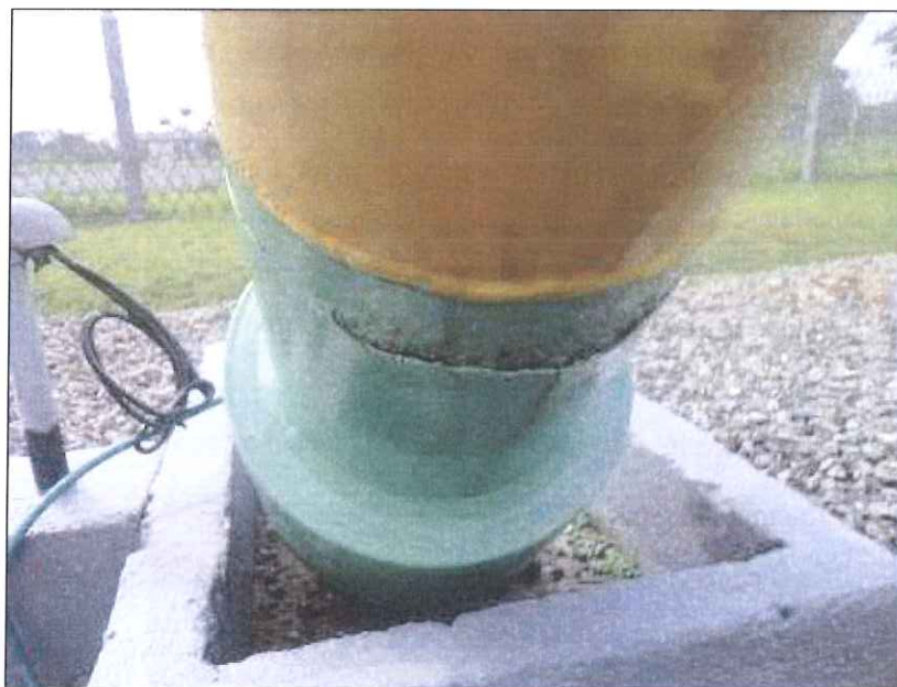
Figura 13: Tubulação com corrosão e trinca
