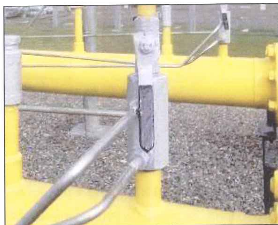
Figura 12: Válvulas com pinturas inadequadas
