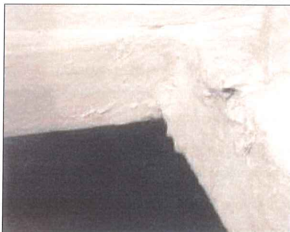
Figura 5: Pintura feita inadequadamente
