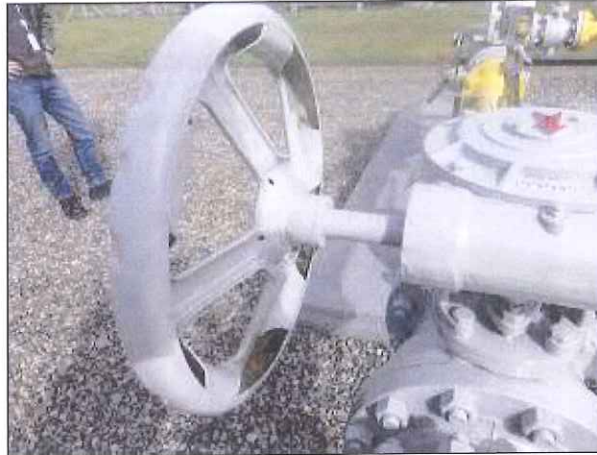
Figura 6: Volante de válvula com ferrugem interna.
