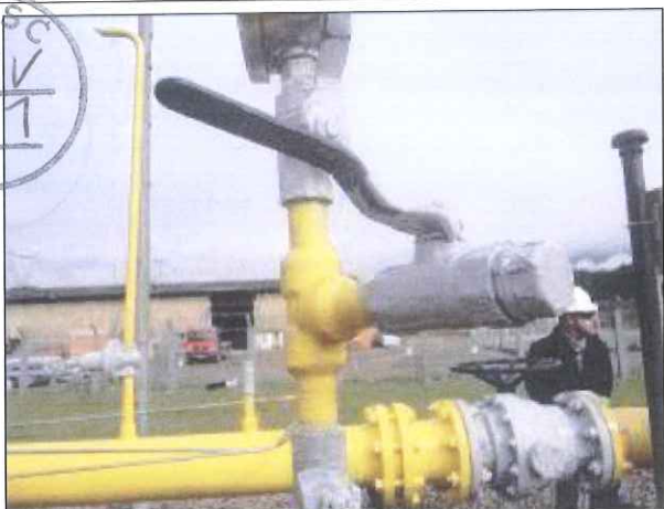
Figura 9: Válvulas com pinturas inadequadas
