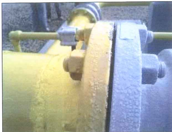
Figura 10: Conexão de válvula com oxidação interna e pintura inadequada
