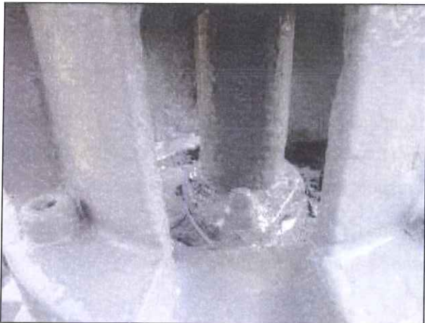
Figura 7: Válvula com pintura inadequada
