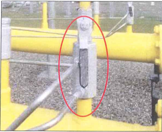
Figura 15: Alavanca instalada incorretamente
