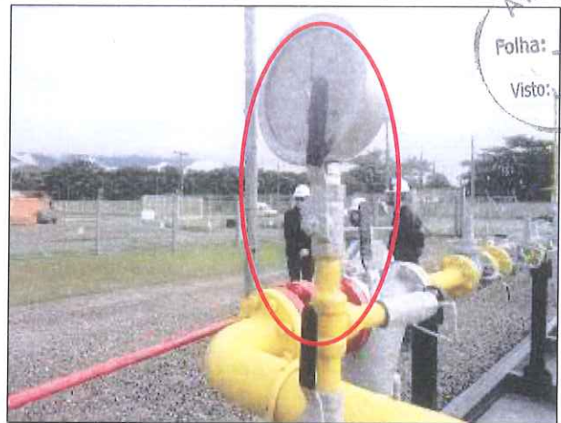
Figura 16: Alavanca instalada incorretamente
