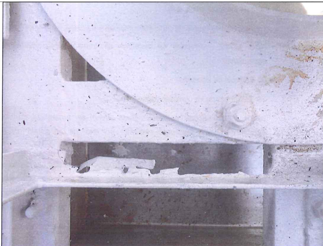
Figura 3: Corrosão na estrutura do SDO
