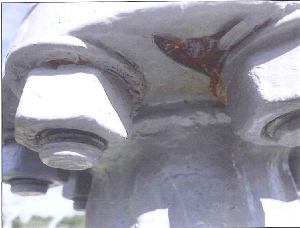
Figura 7: Conexão com pintura inadequada e com pontos de corrosão.
