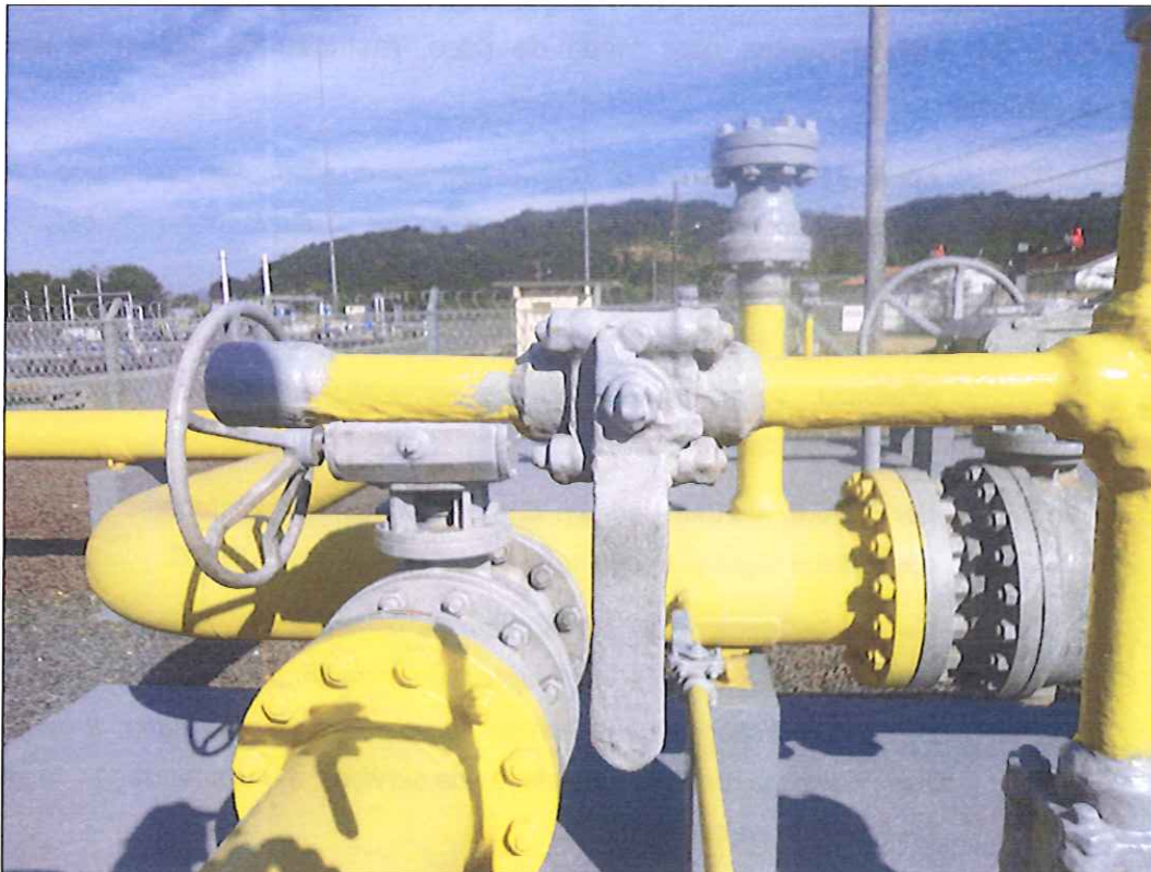
Figura 6: Válvula com pintura inadequada.
