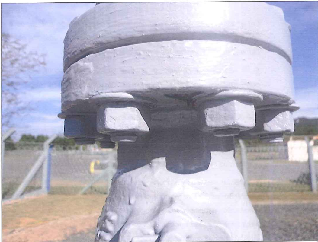
Figura 4: Junção com pintura inadequada.
