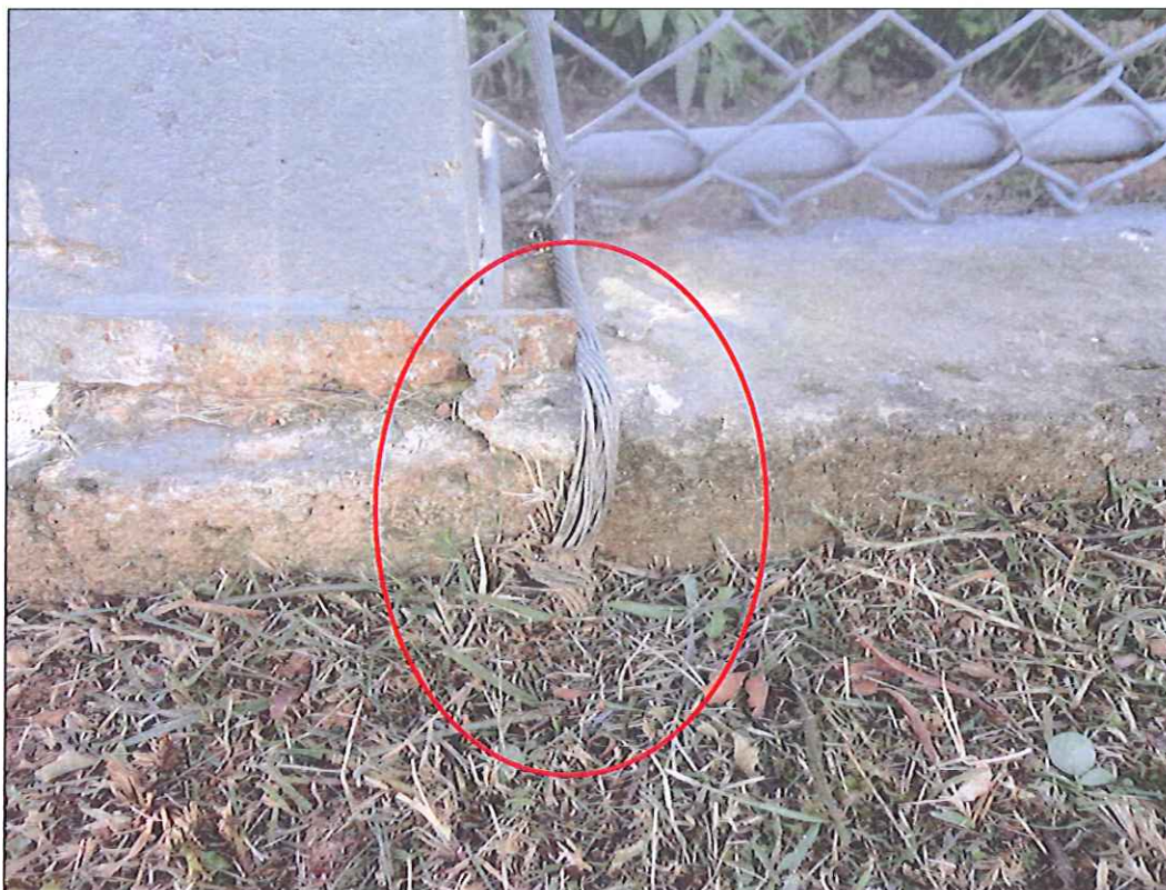
Figura 9: Cabo de aterramento parcialmente cortado.
