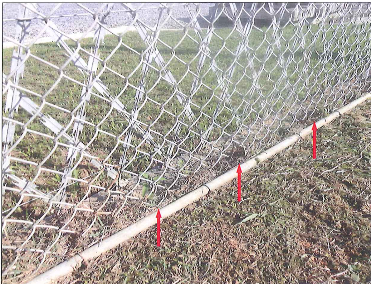
Figura 2: Parte inferior da tela deteriorada pela corrosão.
