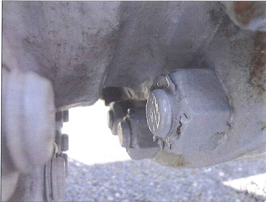
Figura 5: Junção com pintura inadequada.
