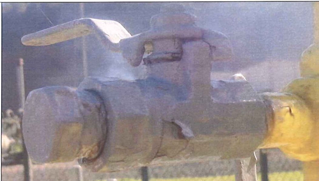
Figura 9: Válvula com pintura inadequada e com pontos de corrosão.
