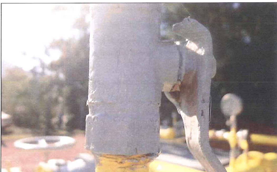
Figura 10: Válvula com pintura inadequada.
