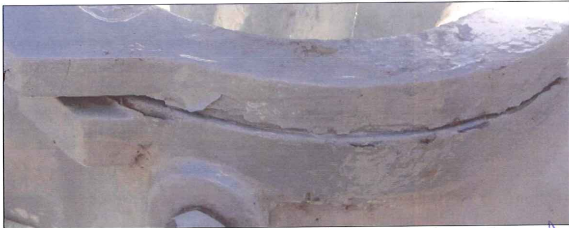
Figura 8: Conexão com pintura inadequada e com pontos de corrosão.
