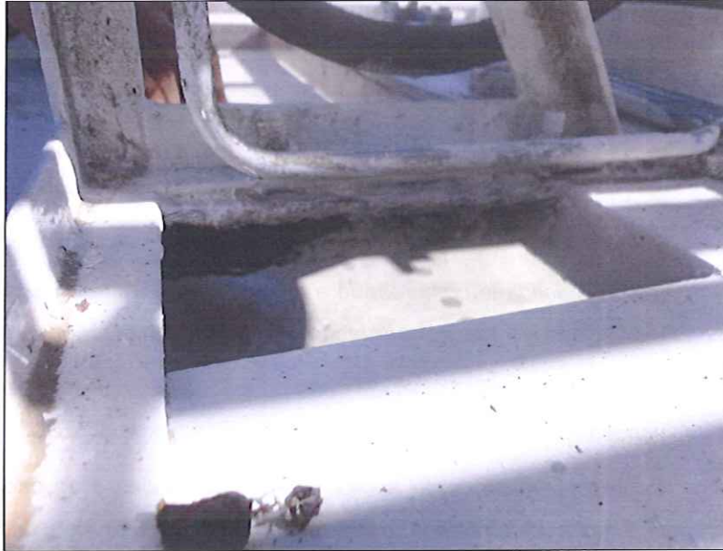
Figura 4: Corrosão na estrutura do SDO.
