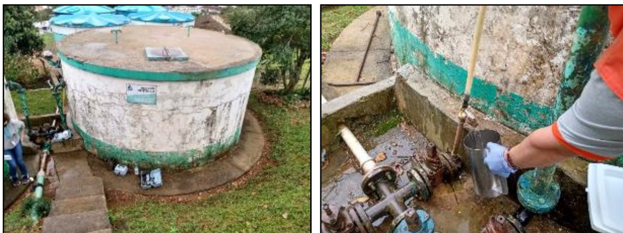
Figura 3: Visão geral do Reservatório R1 e coleta de amostras de água tratada (30/08/2021).
