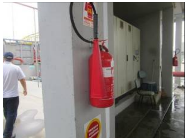
Figura 90: Vista do recipiente extintor de incêndio e ao fundo o painel de controle da ETE Braço do Norte, ambos em boas condições.
