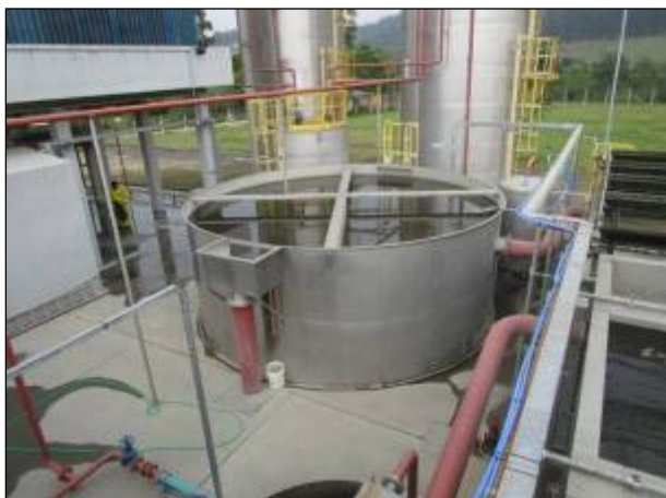
Figura 83: Vista do tanque de contato da ETE, em boas condições de operação.
