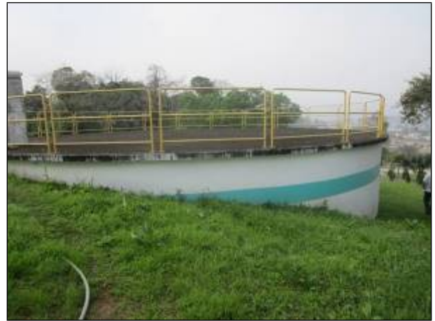
Figura 70: Vista do reservatório R 001, semienterrado e em condições satisfatórias, possui monitoramento remoto.
