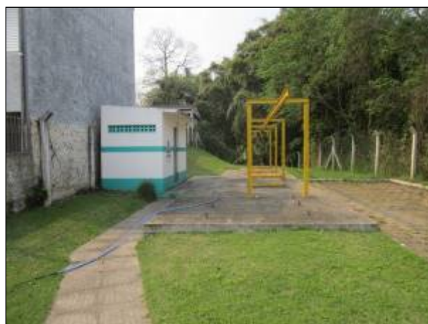
Figura 104: Vista da edificação onde estão localizados os painéis elétrico e de comando da EEE C1.
