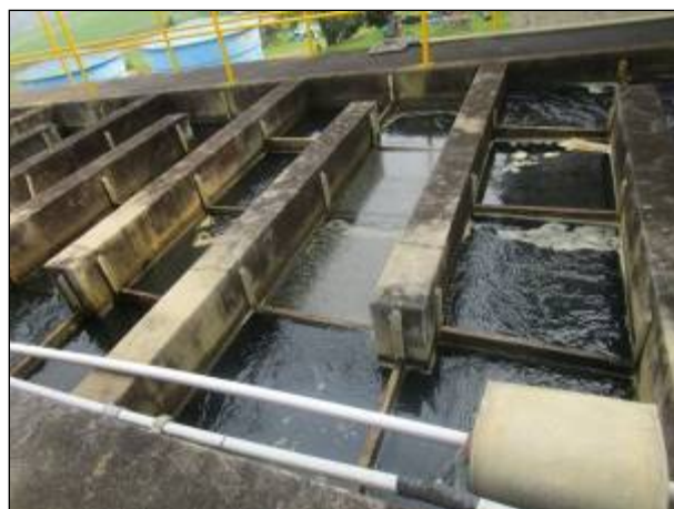
Figura 38: Unidades para tratamento de água na ETA Braço do Norte.
