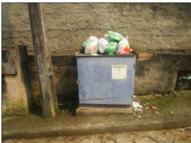
Figura 59: Vista do Booster 03 , placa apagada e indicando erroneamente a unidade, assim como o não isolamento da unidade permite que resíduos sejam depositados no topo da estrutura.
