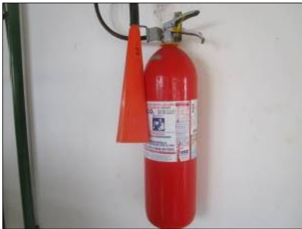
Figura 33: Cilindro contendo pó químico extintor de incêndio em boas condições de uso (pressão, lacre e casco).
