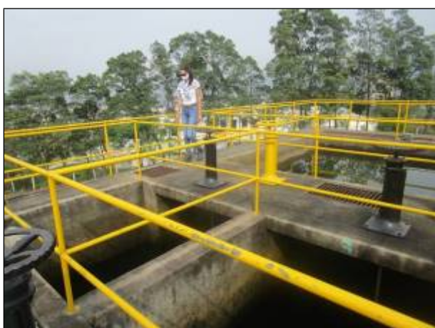
Figura 39: Unidade para tratamento de água na ETA Braço do Norte.
