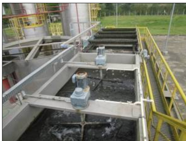
Figura 82: Vista dos tanques de floclação mecânica da ETE Braço do Norte, em boas condições.
