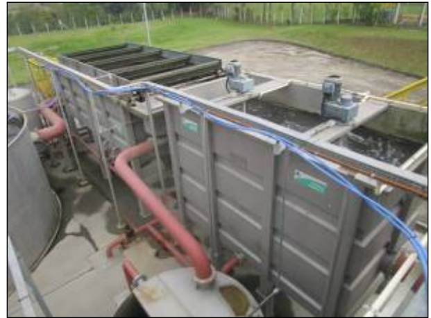
Figura 86: Vista dos tanques de floculação mecânica da ETE Braço do Norte, a partir do gradeamento de entrada.
