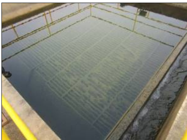
Figura 37: Unidade para tratamento de água na ETA Braço do Norte.
