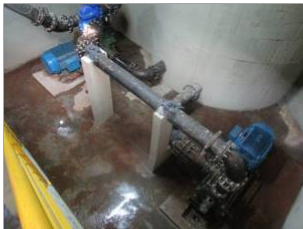
Figura 22: Bombas disponíveis para o recalque de água bruta no local, uma reserva, funcionamento intercalado.
