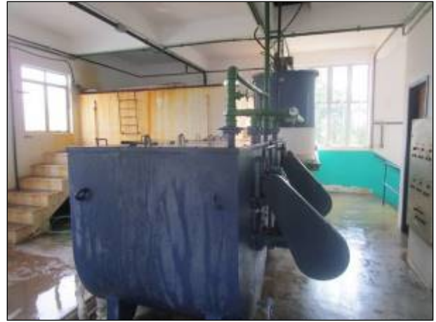
Figura 32: Vista dos equipamentos disponíveis na ETA Braço do Norte.
