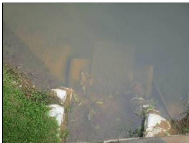
Figura 20: Vista do local onde se capta a água, detalha-se o gradeamento para impedir que objetos impróprios sejam levados para a ETA por adução.
