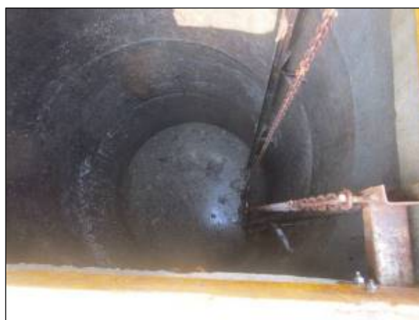
Figura 106: Vista do interior da EEE C1, gradeamento em boas condições de limpeza e conservação.
