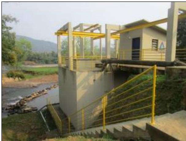
Figura 15: Vista da unidade, abaixo a barragem de captação e acima o local onde está a estrutura para captação, reforma adequada.
