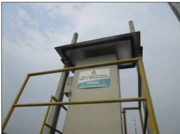
Figura 97: Vista da EEE C2, em boas condições, incluindo a placa de identificação e alerta de perigo. Há monitoramento remoto.
