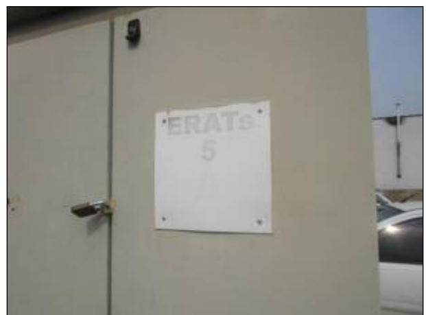
Figura 66: Vista da placa da unidade em condições insatisfatórias.
