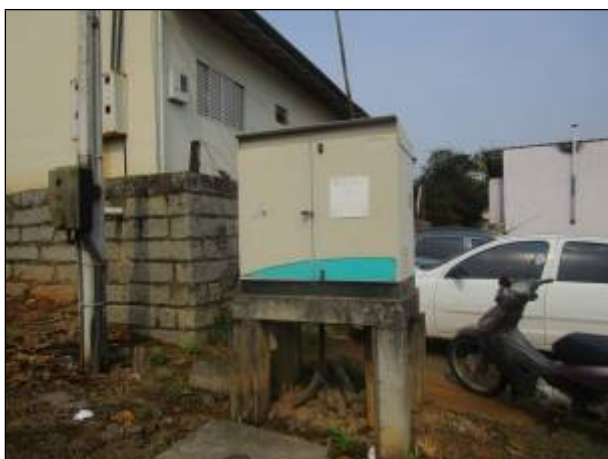
Figura 65: Vista do Booster 05 e painel elétrico, local sem isolamento e identificação adequados.
