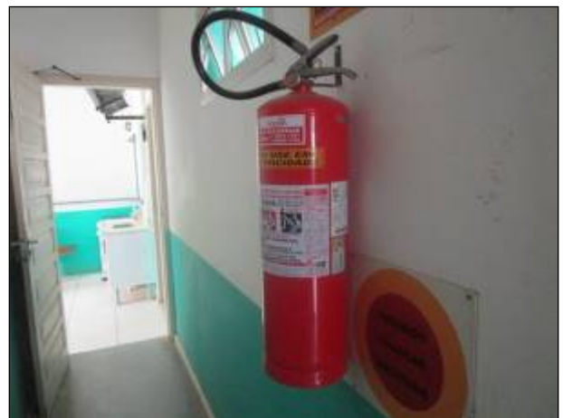
Figura 8: Vista de um dos recipientes contendo pó químico extintor de incêndio em boas condições de uso (pressão, lacre e casco).
