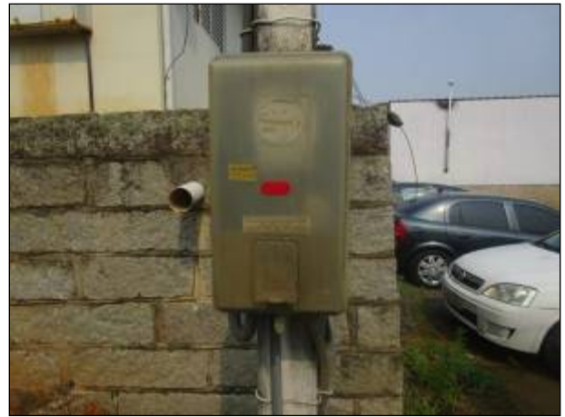
Figura 68: Vista do painel de energia do Booster 05, sem isolamento (cadeado).
