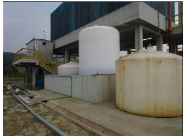
Figura 88: Vista dos locais onde ficam armazenados e são misturados os produtos químicos utilizados no tratamento do efluente.
