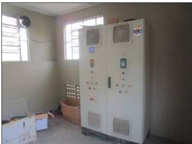
Figura 21: Vista do Painel de Controle da ERAB, local sem identificação e aviso de eletricidade.
