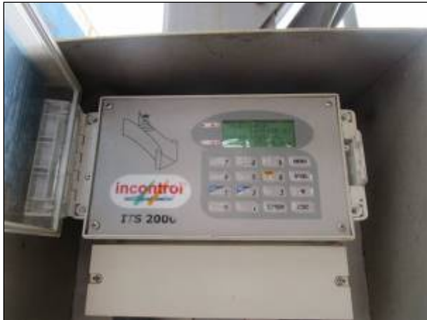
Figura 91: Vista do equipamento de controle da entrada de esgoto na ETE Braço do Norte.
