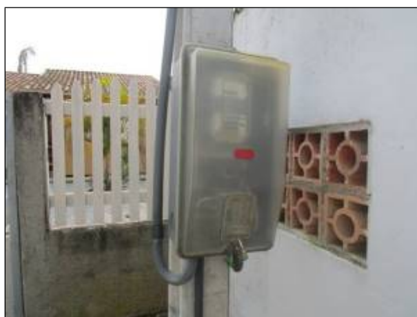
Figura 58: Vista do painel elétrico junto ao Booster 02 , revitalizado e em boas condições.
