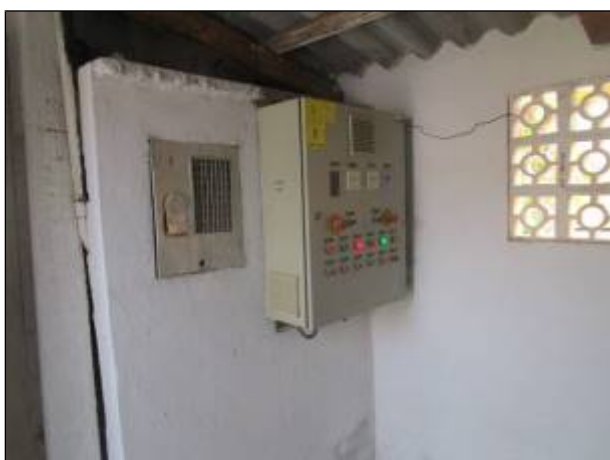
Figura 57: Vista do Painel de Controle do Booster 02 , protegido
