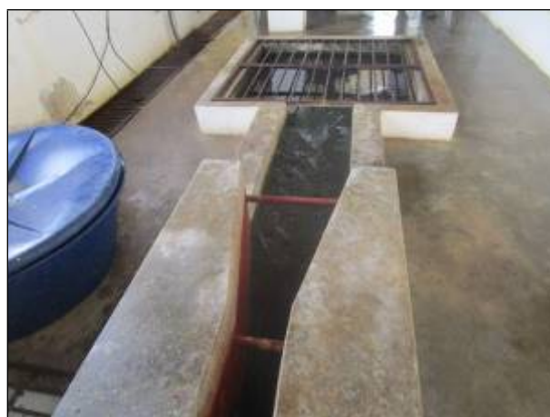
Figura 30: Vista da Calha Parshall. SAA possui macromedidores porém estão indisponíveis para visualização. Há acompanhamento por telemetria.
