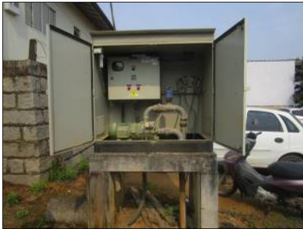
Figura 67: Vista da área interna do Booster 05, boas condições, com cadeado e acompanhamento remoto.
