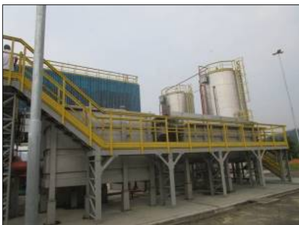
Figura 81: Vista de parte da ETE Braço do Norte, em primeiro plano os flocladores e flotor e a passarela de acesso.
