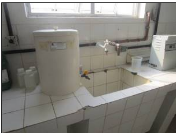
Figura 41: Vista de parte do laboratório disponível na ETA Braço do Norte.
