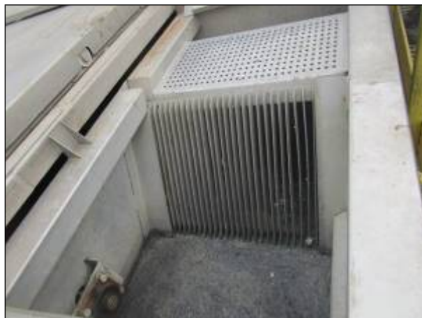
Figura 80: Vista do local de entrada de esgoto bruto no gradeamento
