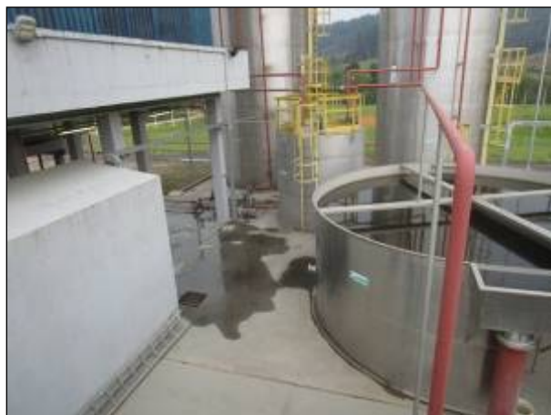
Figura 84: Local estava sendo higienizado no momento da visita. Ao fundo, vista dos digestores.
