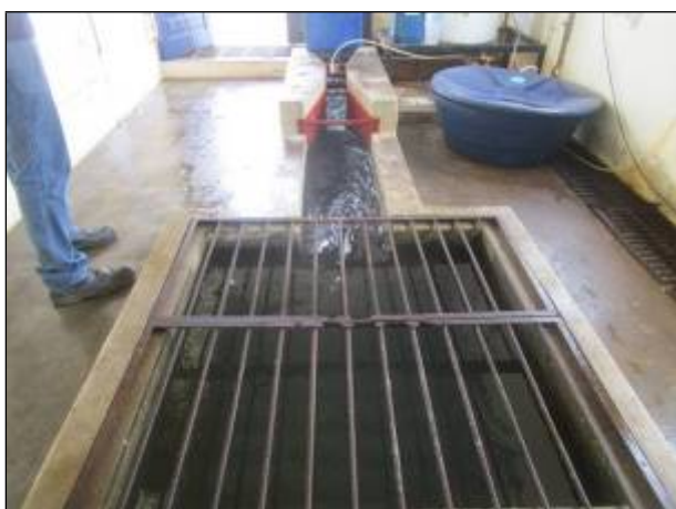
Figura 29: Entrada de água bruta proveniente do rio Braço do Norte.
