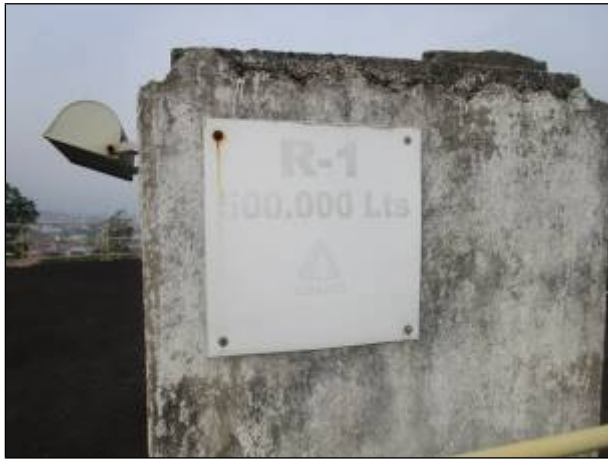
Figura 69: Vista da placa indicando o reservatório R 001 em condições insatisfatórias.
