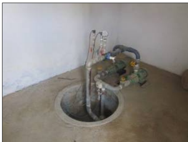
Figura 56: Vista da bomba disponível no local, protegida.
