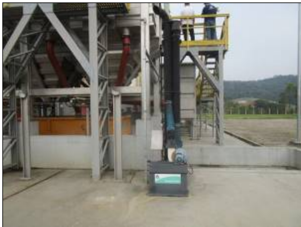
Figura 87: Vista dos equipamentos disponíveis na ETE Braço do Norte em boas condições.
