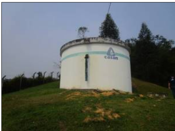
Figura 77: Vista do reservatório R 003, condições satisfatórias, incluindo o monitoramento remoto.
