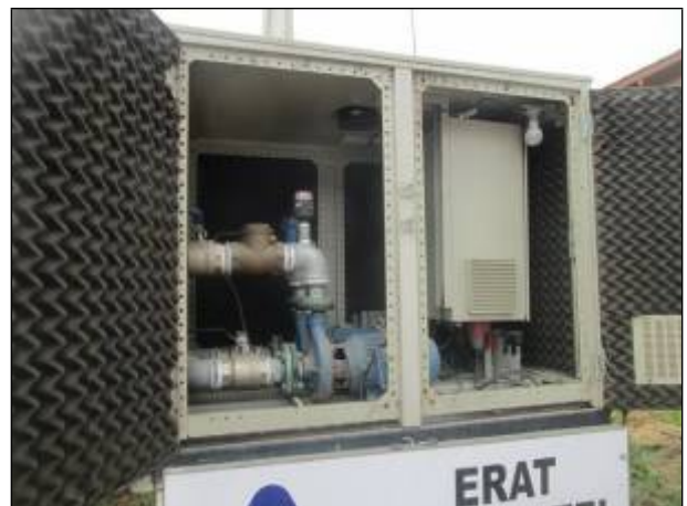
Figura 54: Vista da área interna da ERAT do Capitel, boas condições, incluindo o painel elétrico (poste novo ao fundo).
