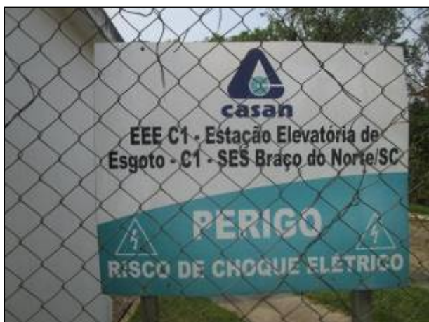
Figura 103: Vista em detalhe da placa indicativa da EEE C1.
