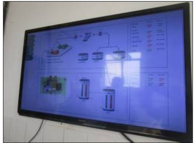
Figura 44: Vista do sistema informatizado (telemetria via sistema Scada), incluindo boa parte das unidades do SAA, dentre estas a ETA Braço do Norte.
