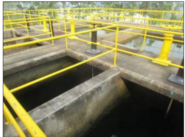
Figura 36: Unidades para tratamento de água na ETA Braço do Norte.
