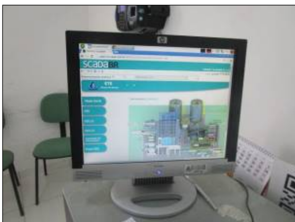
Figura 95: Vista do sistema de monitoramento da concessionária (Scada) para o SES, disponível para os operadores no local. Deve-se verificar a possibilidade de haver uma tela maior para o monitoramento.
