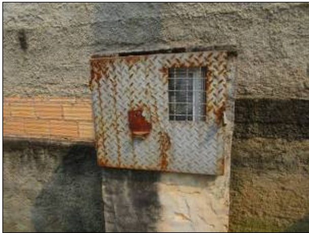
Figura 61: Vista do painel elétrico em condições precárias, próximo ao Booster 03 . Deve-se planejar a mudança de local da unidade por questões de segurança.
