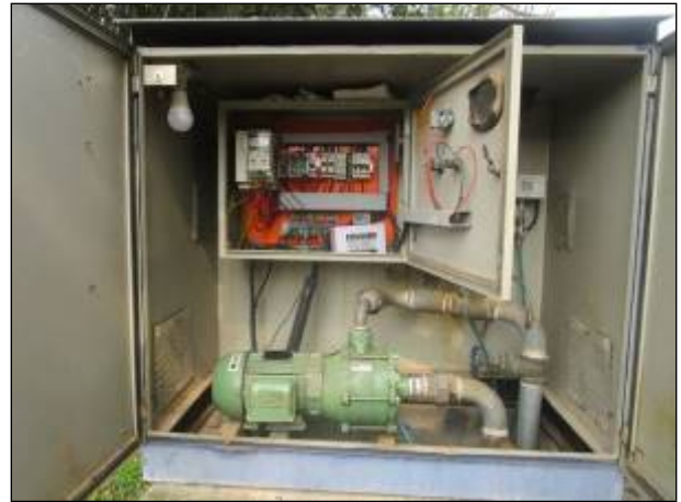
Figura 64: Vista do interior do Booster 04 , em boas condições.
