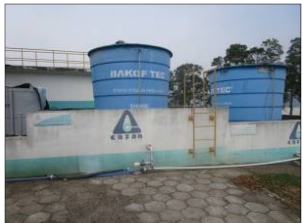
Figura 48: Vista do local em boas condições, tampas e acesso.
