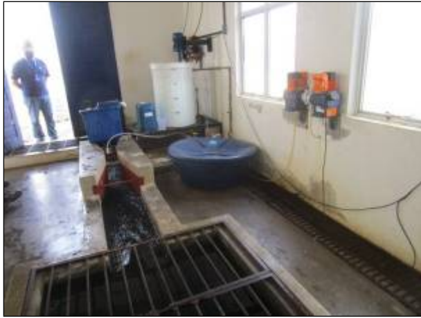
Figura 31: Vista da entrada de água bruta proveniente do rio Braço do Norte.
