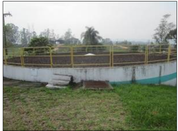
Figura 74: Vista do reservatório R 002, conectado com o R 001.
