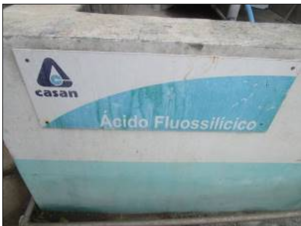
Figura 47: Vista da placa, em condição satisfatória, indicando o produto que ali está armazenado para uso imediato.
