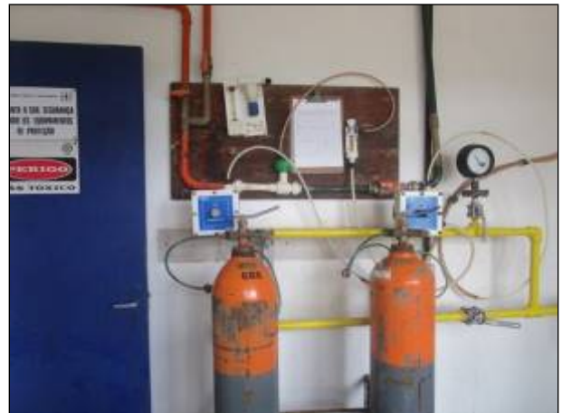
Figura 46: Vista dos cilindros de cloro (clorogás) instalados para a desinfecção da água bruta na ETA Braço do Norte.
