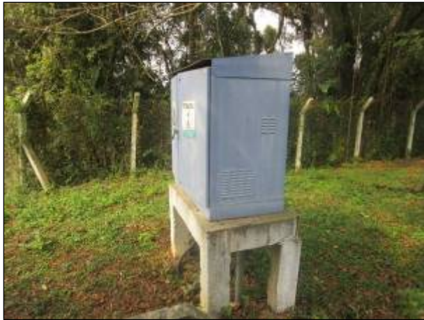
Figura 63: Vista da unidade Booster 04 em local isolado, ou seja, dentro do local onde está a ETA Braço do Norte.
