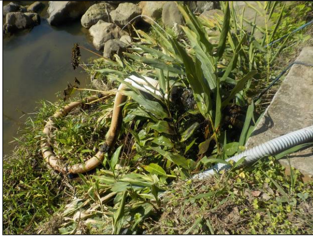
Figura 11: Vista da parte estrutural da captação, sem isolamento e vazamento no mangote que faz o transporte da água bruta até a ETA Caeté, cerca de 30 metros.
