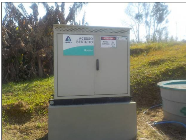
Figura 45: Booster 5 contendo na parte externa as placas de restrição e informativa da unidade.
