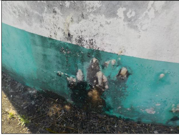
Figura 35: Reservatório R3 com infiltrações na parte externa.
