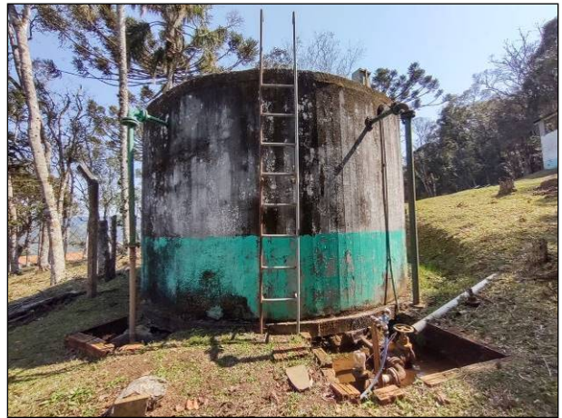
Figura 38: Vista do Reservatório R4 e de sua área externa, acúmulo de objetos indevidos e pintura insatisfatória.
