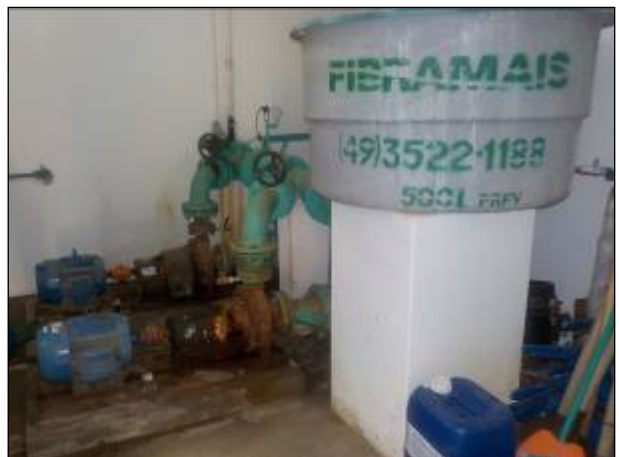
Figura 22: Detalhe do local onde está localizada a ERAT, dentro da ETA.
