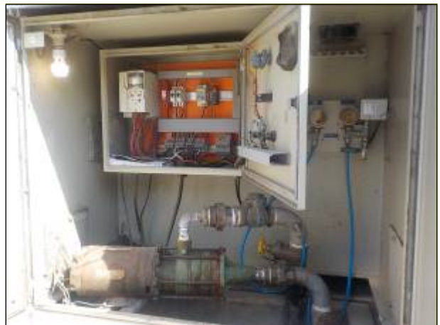
Figura 28: Vista do interior do Booster localizado junto a ETA, não possui monitoramento remoto.
