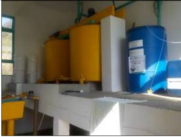
Figura 17: Detalhe dos equipamentos disponíveis para o Tratamento da Água Bruta na ETA Caeté.
