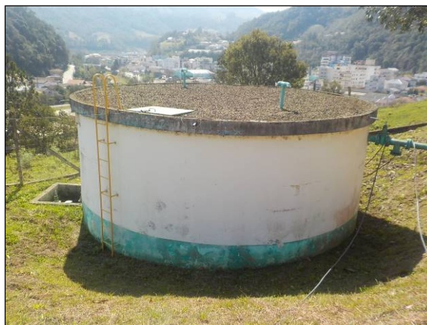
Figura 32: Vista do reservatório R1, escada de acesso sem guarda-corpo, estrutura satisfatória, porém pintura insatisfatória.
