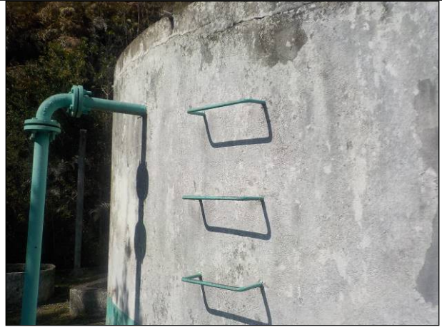
Figura 36: Reservatório R3 e sua escada de acesso à parte superior, sem guarda-corpo.
