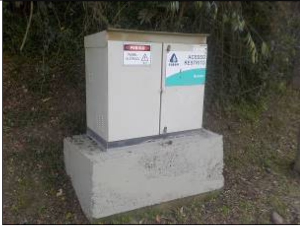
Figura 41: Vista Booster Barracão , com placas de acordo com a identificação e informe de perigo.
