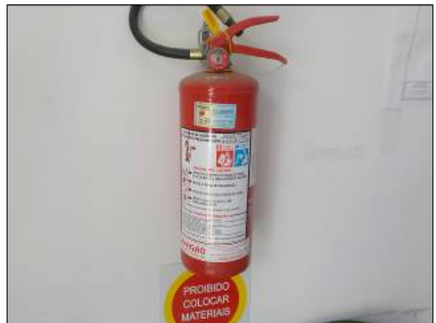
Figura 6: Cilindro contendo pó químico extintor de incêndio em boas condições de uso (pressão, lacre e casco).
