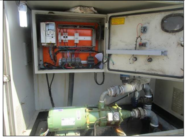
Figura 48: Vista da parte interna do Booster do Cemitério .
