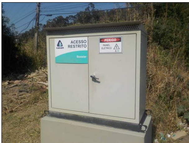
Figura 43: Vista do Booster 4 , às margens da rodovia SC-350.
