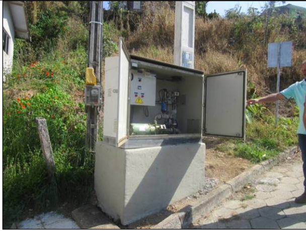
Figura 47: Booster do Cemitério , em boas condições, embora ocupe quase a totalidade da caçada para pedestres.
