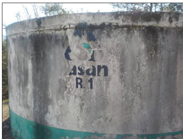
Figura 34: Reservatório R3 com problemas na estrutura e pintura. Sem monitoramento remoto.
