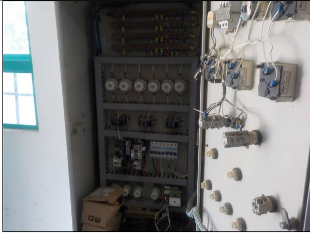
Figura 23: Detalhe do quadro de comandos da ETA, em boas condições.
