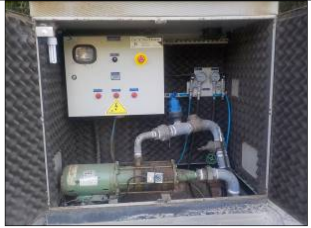
Figura 42: Parte interna do Booster Barracão , em condições satisfatórias.
