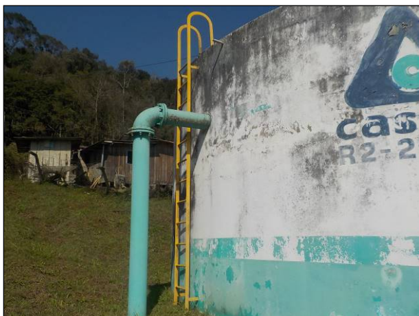
Figura 31: Vista do reservatório R2, escada de acesso sem guarda-corpo, estrutura satisfatória, porém pintura insatisfatória.
