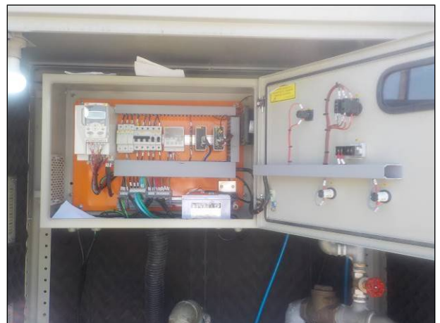
Figura 46: Vista do Booster 5 em sua parte interna, boas condições.
