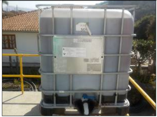
Figura 18: Tanque contendo o sulfato alumínio trocado por PAC utilizado no tratamento da água para auxiliar na coagulação dos sólidos.
