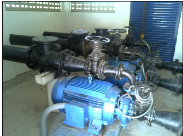
Figura 3: ERAT e seu conjunto de motobombas, no momento da visita sem grupo gerador de energia para apoio.
