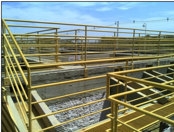
Figura 4: Vista geral da ETA em funcionamento.
