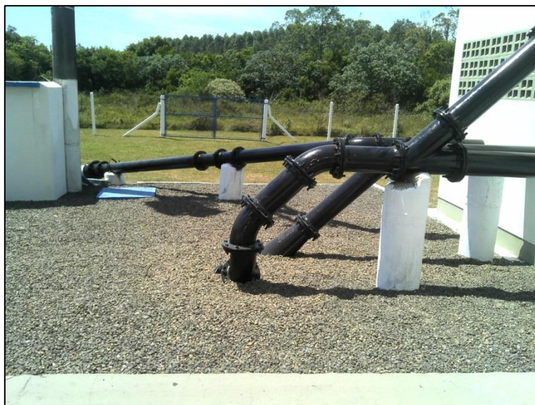
Figura 1: Adutora readequada para atendimento da porção sul municipal (ao fundo).
