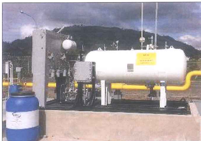
Figura 02: Nova estrutura do sistema de odoração.
