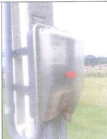
Figura 17: Medidor de energia com cadeado.
