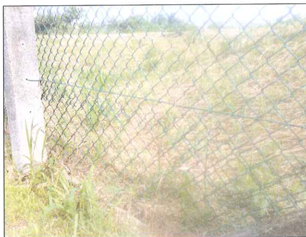
Figura 01: Emenda na tela de proteção.
