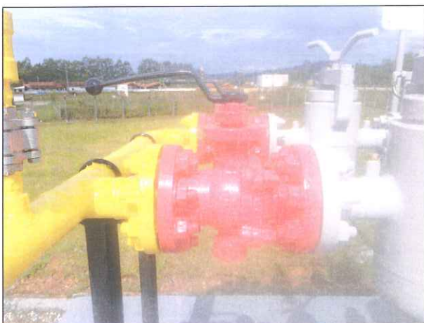
Figura 111: Válvula com pintura adequada.
