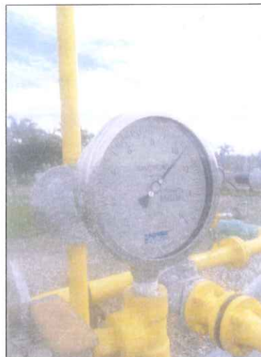
Figura 13: Substituição do manômetro.
