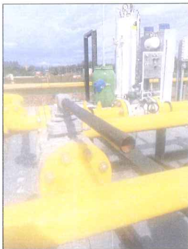
Figura 12: Equipamento com pintura adequada.
