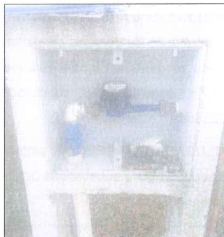
Figura 07: Medidor de água.
