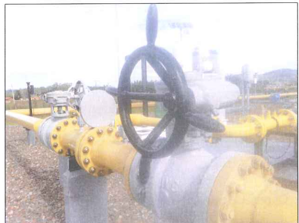
Figura 10: Equipamento com pintura adequada.
