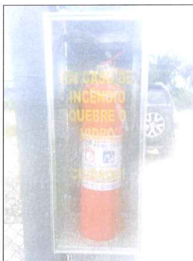
Figura 08: Extintor de incêndio.
