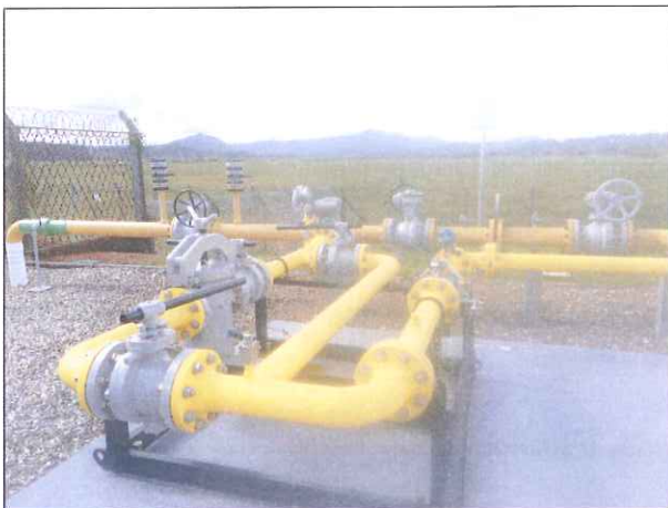
Figura 09: Equipamento com pintura adequada.
