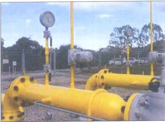
Figura 03: Estação de Recebimento após a manutenção.
