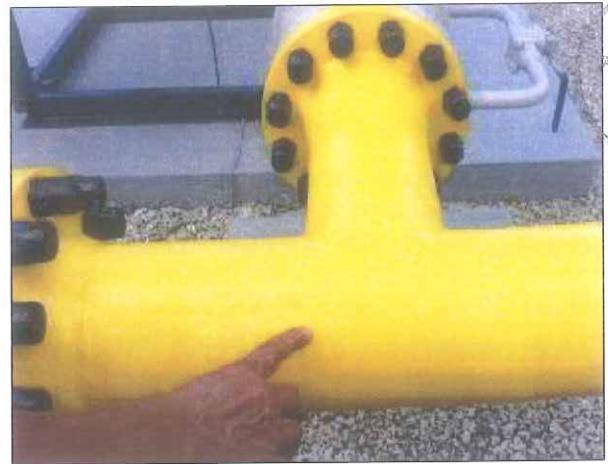
Figura 04: Ponto de oxidação após a manutenção.
