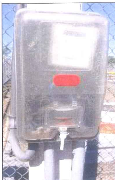
Figura 06: Medidor de energia com lacre de segurança.
