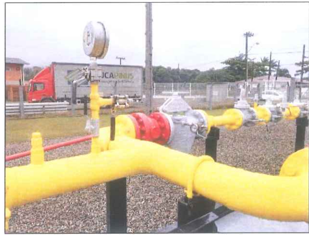
Figura 08: Válvulas novas de inox.
