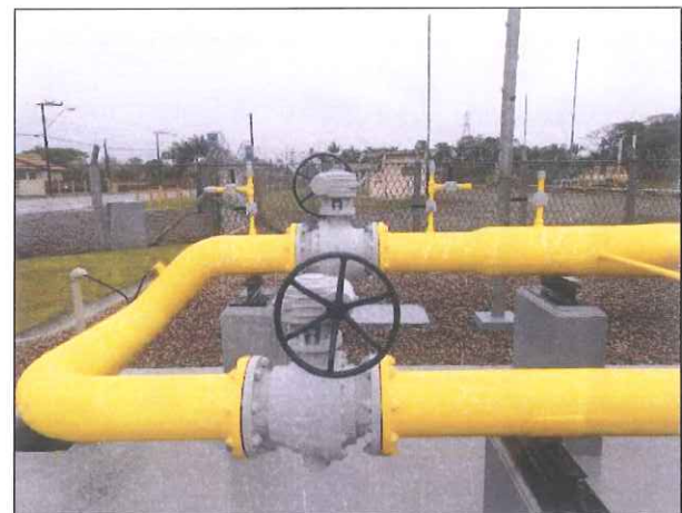
Figura 09: Válvulas com pintura adequada.
