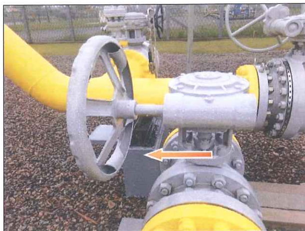
Figura 05: Volante de válvula sem ferrugem interna.
