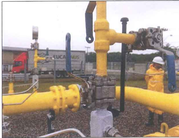
Figura 12: Registros Novos e alavancas adequadamente posicionadas.
