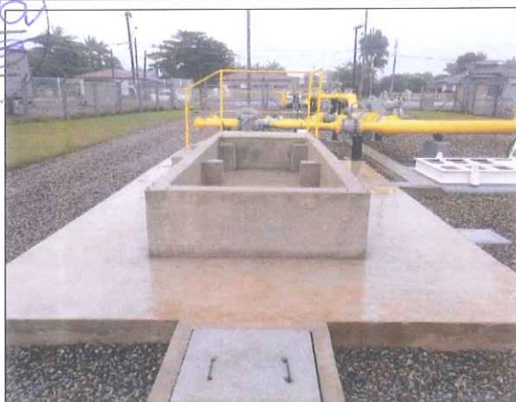
Figura 03: Nova Bacia de contenção.
