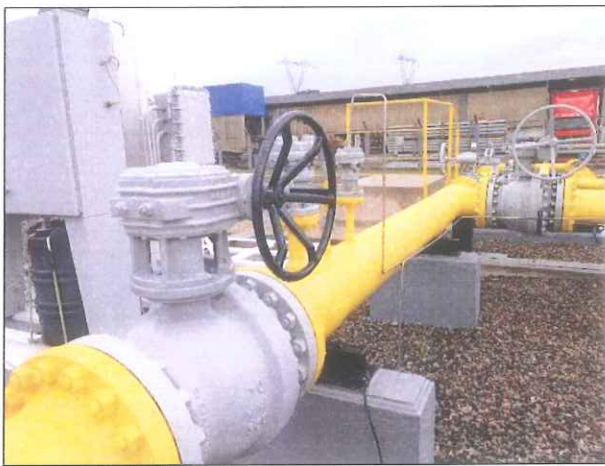
Figura 06: Válvula com pintura adequada.
