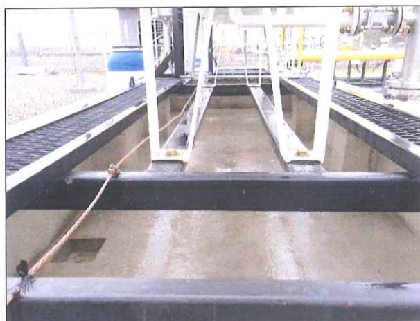
Figura 07: Base do Sistema de Odoração novo.
