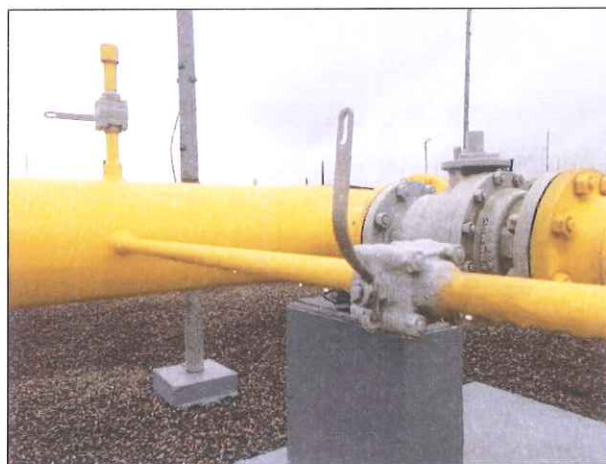
Figura 11: Registros e válvulas bem pintadas.
