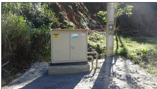
Figura 19: Booster 01 , instalação nova.
