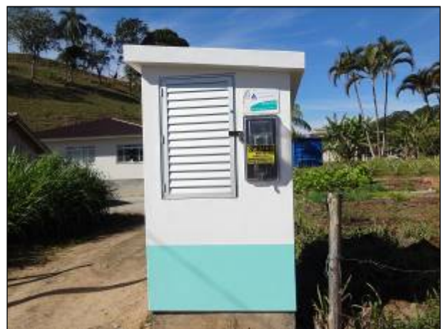
Figura 12: Recomendação 27, vista do medidor de energia no booster 15 de novembro.
