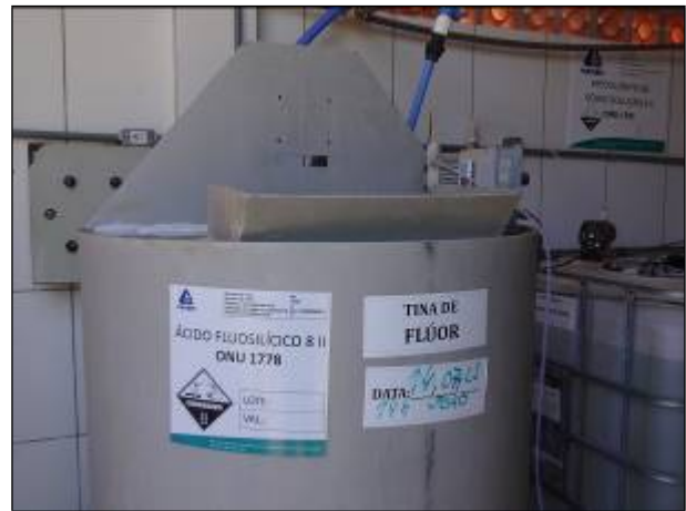
Figura 10: Recomendação 17, foi disposto um local adequado para armazenamento e acondicionamento dos produtos químicos e materiais utilizados na ETA Compacta.
