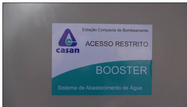
Figura 22: Booster 02 , instalação nova.
