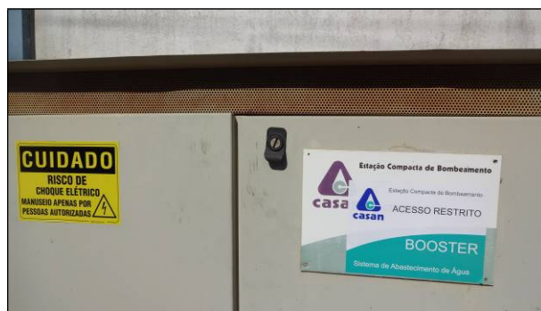
Figura 24: Booster 03 , instalação nova.
