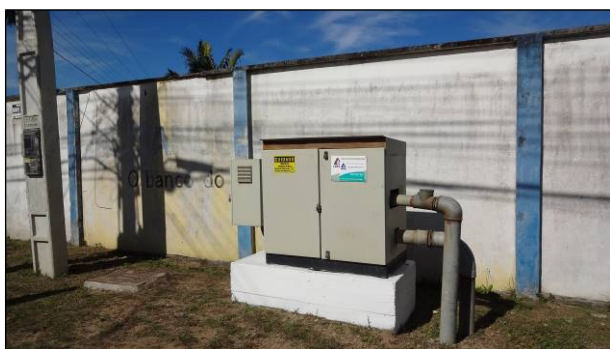
Figura 23: Booster 03 , instalação nova.
