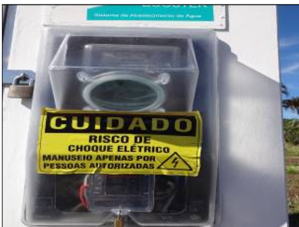
Figura 11: Recomendação 27, foi providenciado o isolamento total do medidor de energia por meio da instalação de cadeado no booster 15 de novembro.
