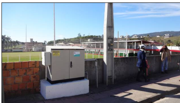
Figura 21: Booster 02 , instalação nova.
