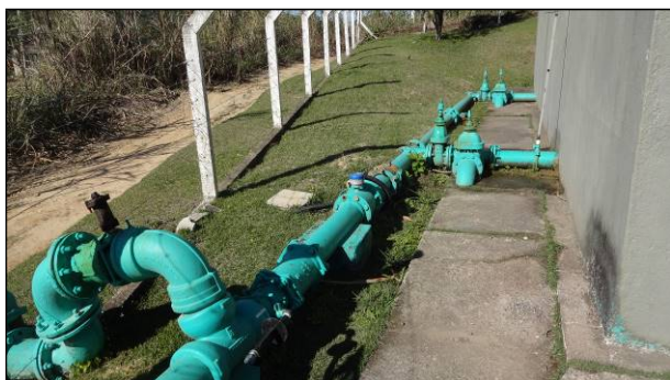
Figura 17: Recomendação 14, foi instalado macromedidor de vazão de água bruta.
