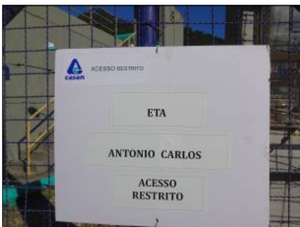
Figura 5: Recomendação 11, instalação da placa de identificação e restrição de acesso da ETA Compacta Antônio Carlos.
