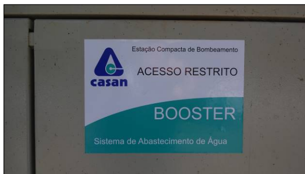
Figura 20: Booster 01 , instalação nova.
