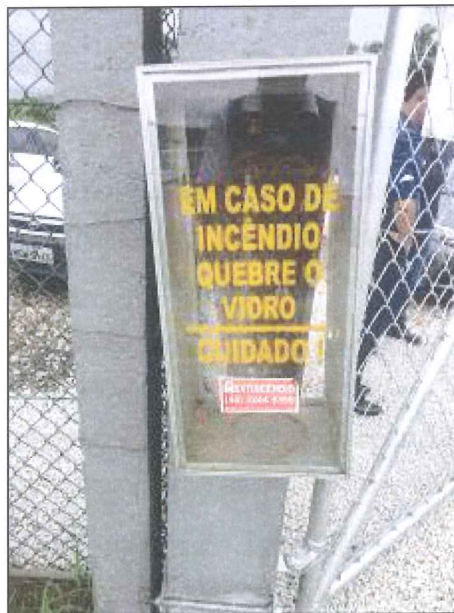
Figura 13: Falta de extintor de incêndio
