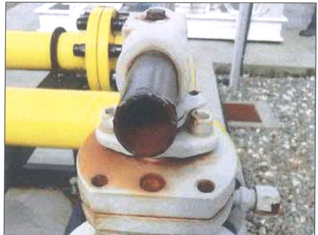
Figura 19 – Válvula e alavanca com corrosão
