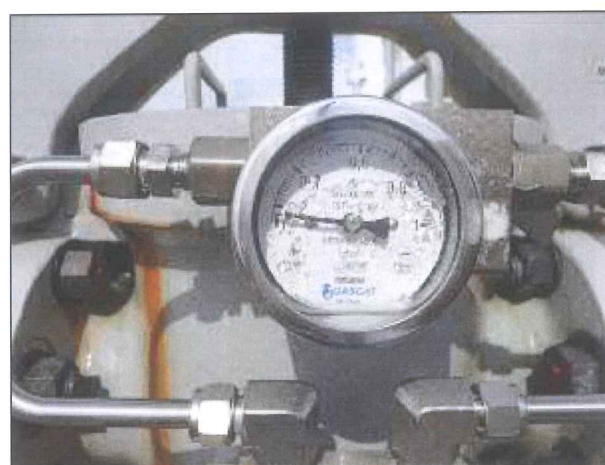
Figura 24: Manômetro com infiltração de água
