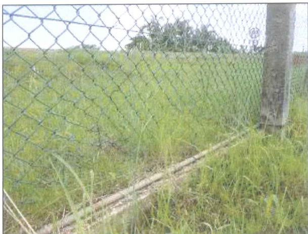
Figura 2: Tela oxidada e rompida em vários pontos
