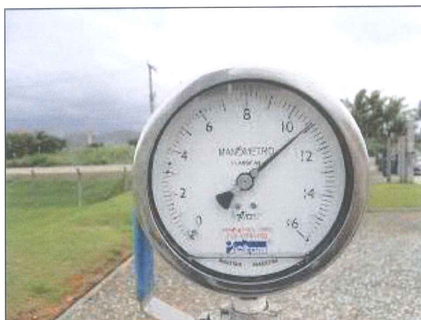
Figura 21: Manômetro com infiltração de água
