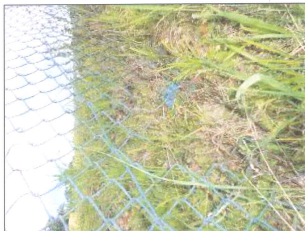
Figura 5: Tela oxidada e rompida em vários pontos
