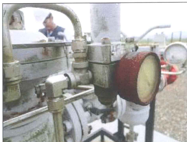
Figura 22: Manômetro com corrosão
