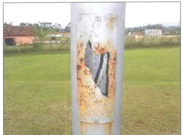
Figura 29 - Postes do SPDA com pontos com corrosão
