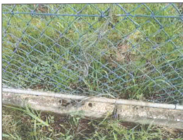
Figura 4 - Cordoalha aterramento rompida
