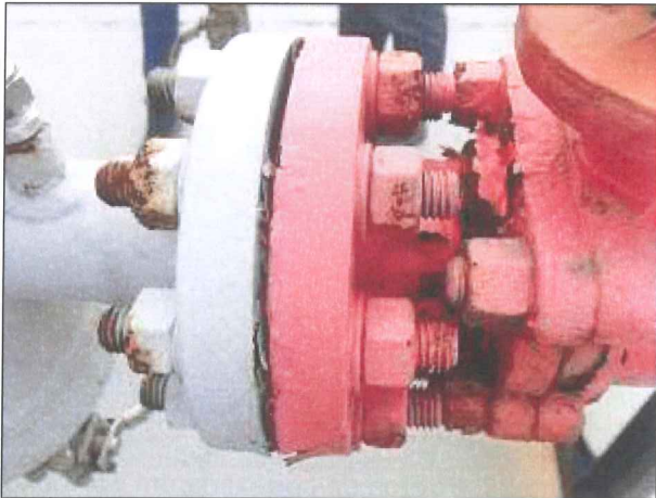
Figura 16: Conexão com corrosão
