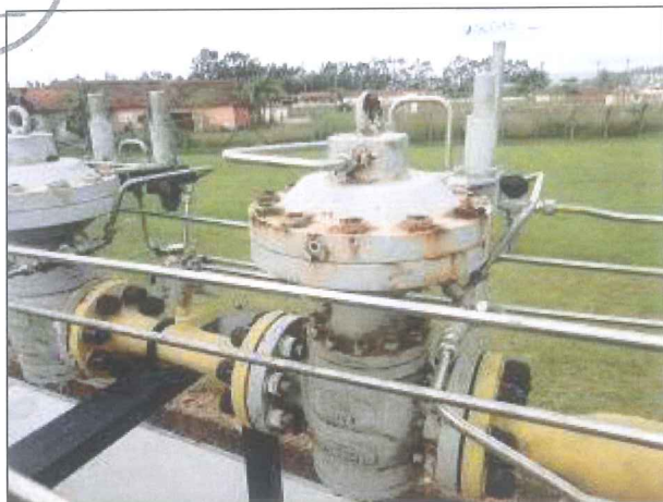
Figura 20: Válvulas com corrosão
