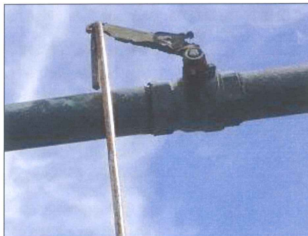
Figura 12: Válvula do lava-olhos com corrosão
