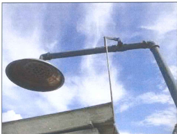
Figura 11 Lava-olhos não está funcionando
