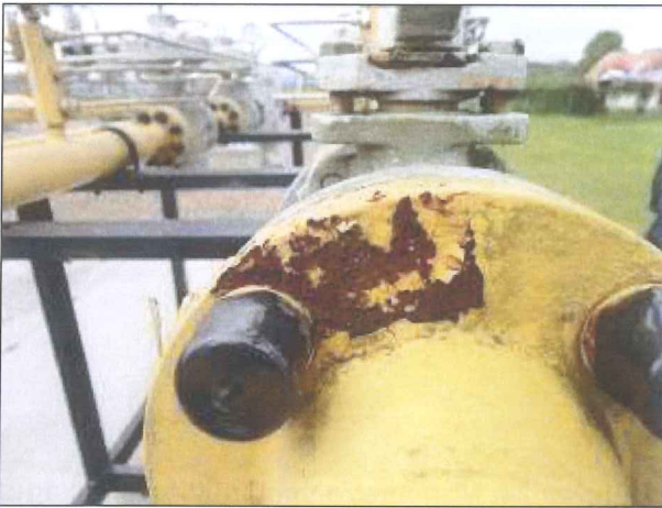
Figura 15: Conexão com corrosão
