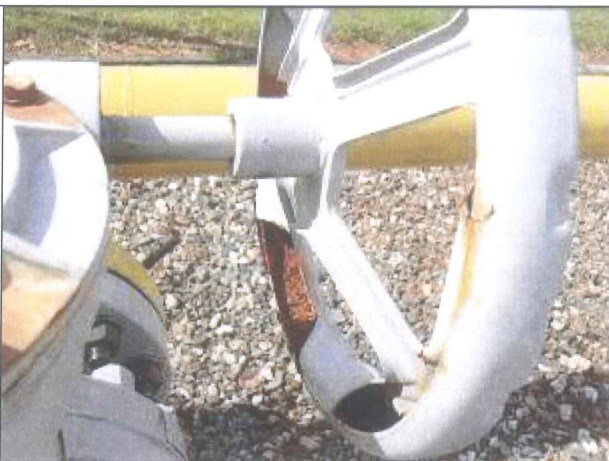
Figura 26: Volante com corrosão
