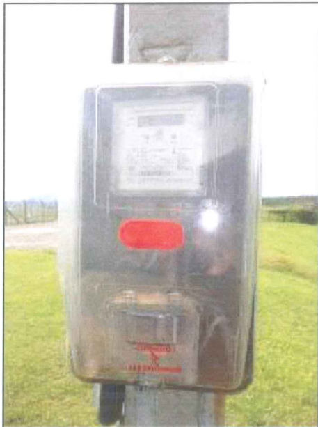
Figura 30: Medidor de energia sem cadeado
