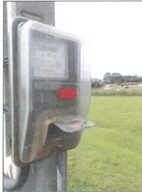
Figura 31: Medidor de energia sem cadeado
