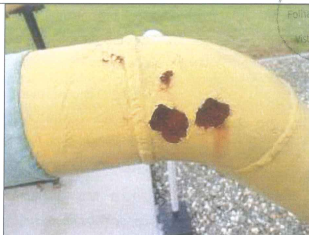
Figura 27: Tubulação com corrosão
