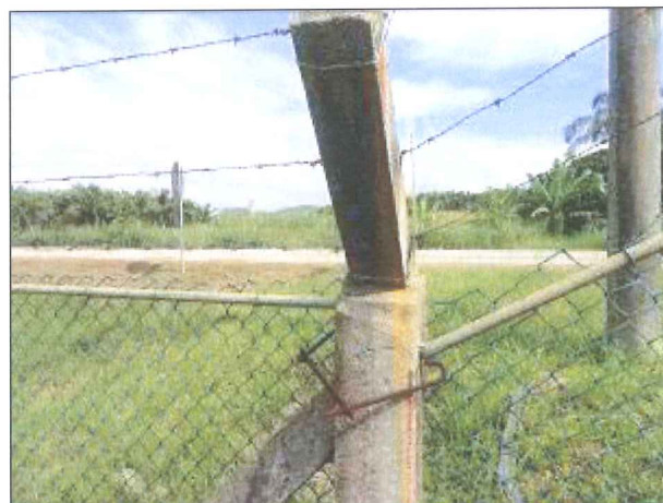
Figura 6: Abraçadeira solta e arames farpados superiores oxidados
