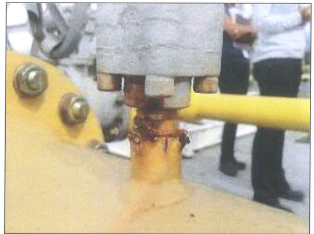
Figura 18: Conexão com corrosão
