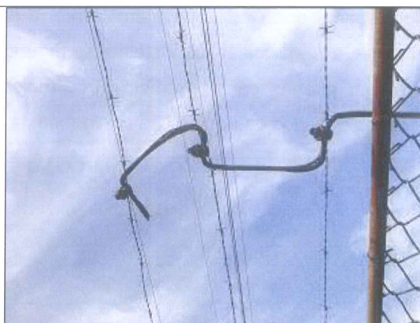
Figura 9: Conexão da cordoalha de terra aos arames da cerca está inadequada
