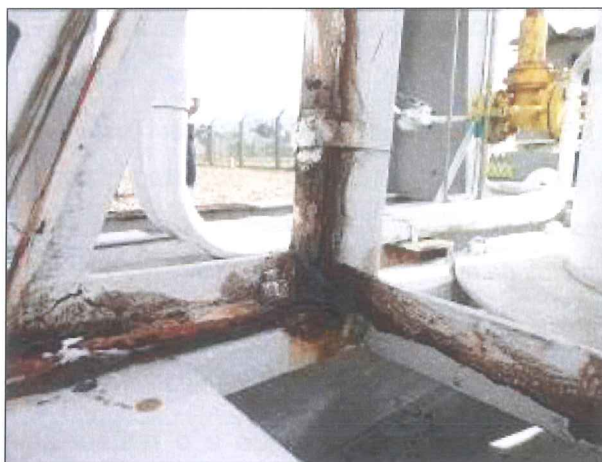
Figura 10: Corrosão na estrutura do SDO
