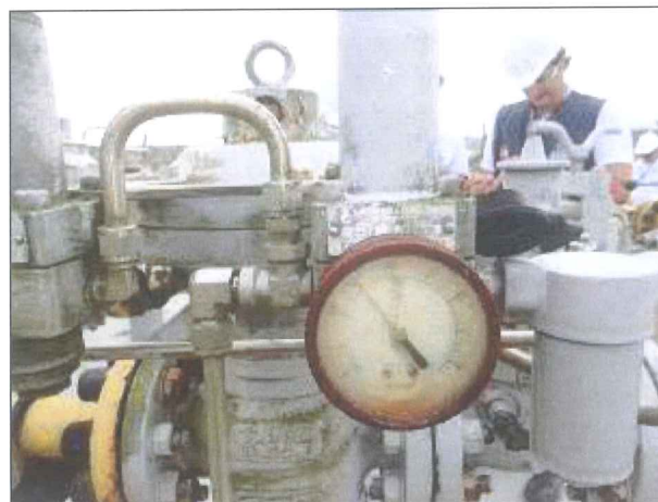
Figura 23: Manômetro com corrosão
