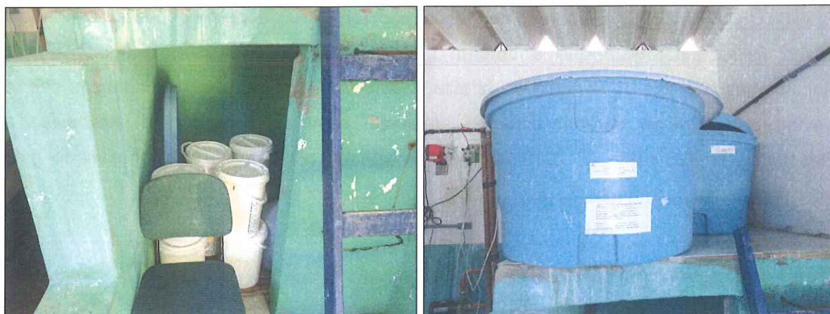
Figura 7: Acondicionamento inadequado de produtos químicos
