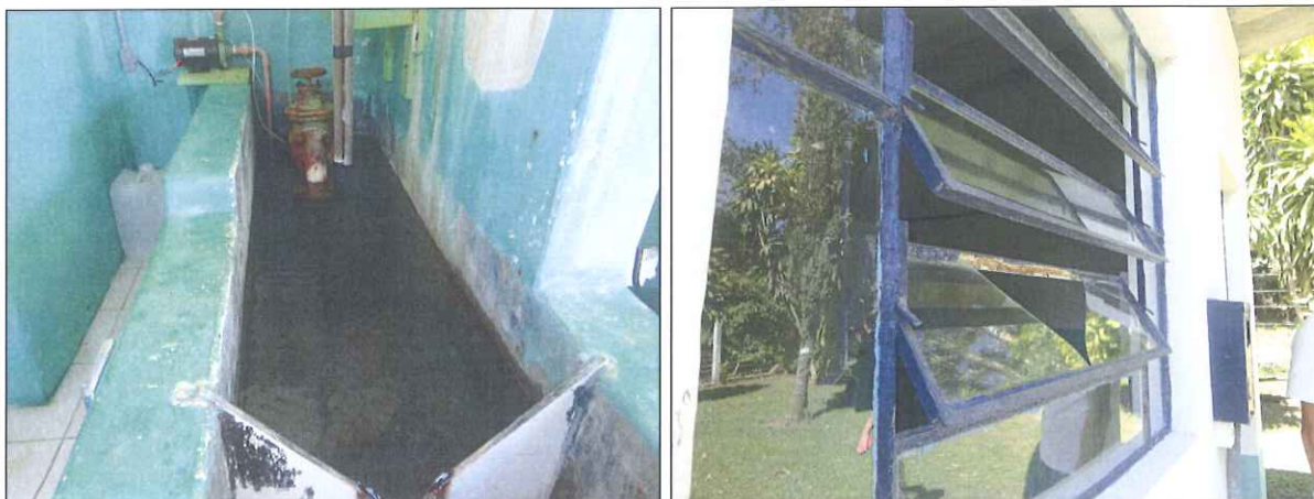
Figura 8: Condições da casa de química com vidraças quebradas
