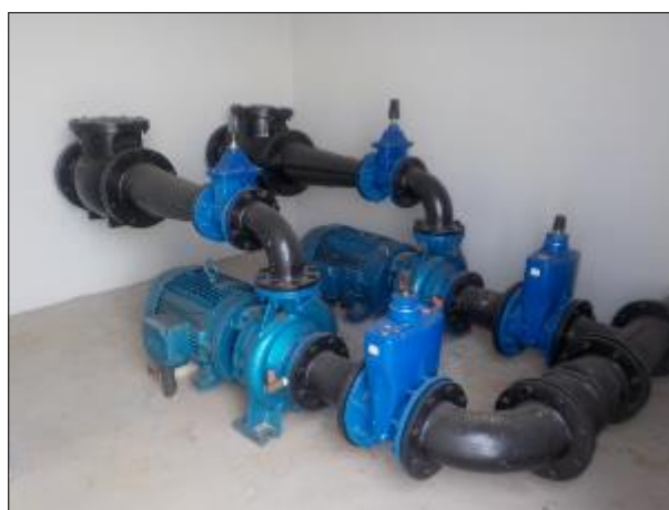
Figura 51: Vista das bombas de 30 cv disponíveis para recalque da água tratada, uma delas reserva.
