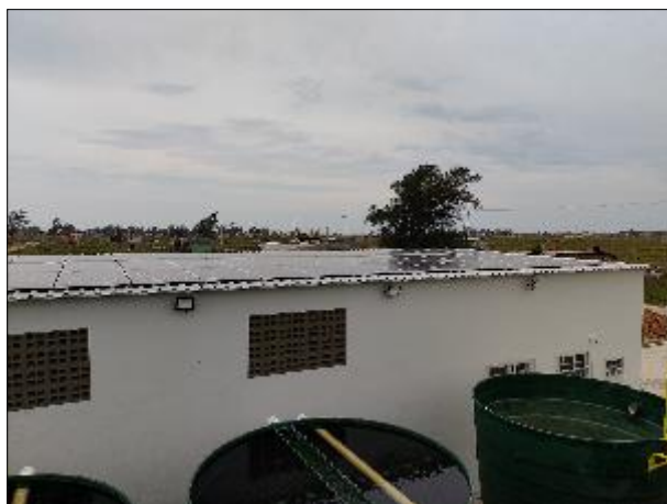
Figura 29: Vista dos painéis de energia fotovoltaica instalados na área superior do prédio adjacente.
