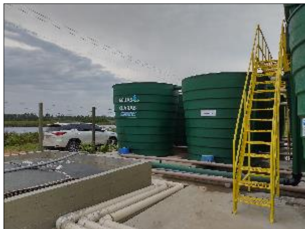
Figura 9: Vista das escadas de acesso à área superior da ETA II, com pintura e corrimões em boas condições.
