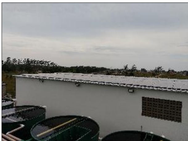
Figura 28: Vista dos painéis de energia fotovoltaica instalados na área superior do prédio adjacente.
