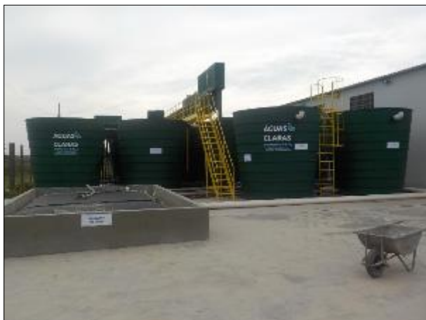
Figura 8: Vista da ETA II, já em funcionamento, com seus equipamentos de material fibra de vidro.
