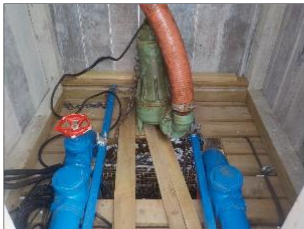
Figura 7: Vista da área interna onde estão localizadas as bombas de 7,5 cv cada,
