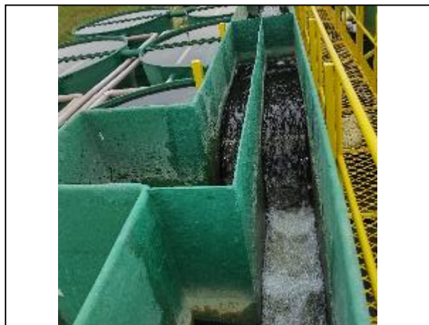
Figura 23: Vista da saída do floculador, estágio anterior à entrada de água nos decantadores
