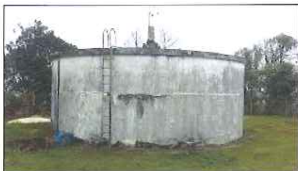
Figura 7: Imagem do Reservatório Mirante Canto da Praia, Bairro Canto da Praia.
