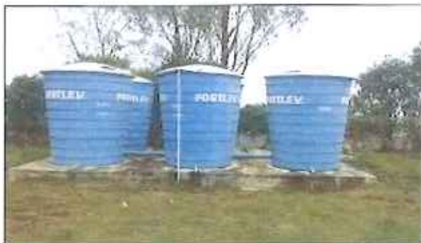
Figura 5: Imagem dos Reservatórios que recebem água tratada da Casa de Química do município de Papanduva.
