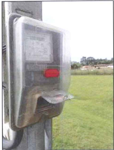
Figura 31: Medidor de energia com cadeado
