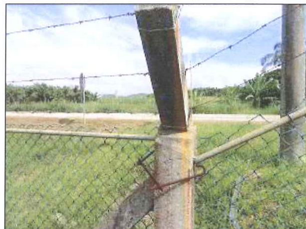
Figura 6: Abraçadeira solta e arames farpados superiores oxidados
