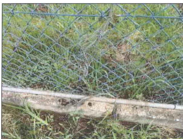
Figura 4 - Cordoalha aterramento rompida
