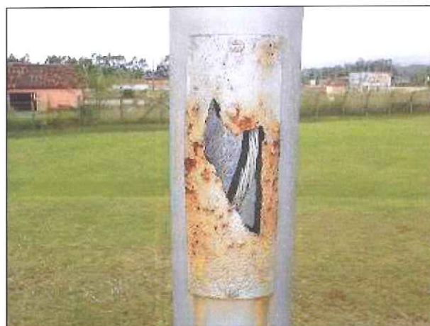
Figura 29 - Postes do SPDA com pontos com corrosão
