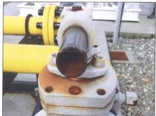
Figura 19 – Válvula e alavanca com corrosão
