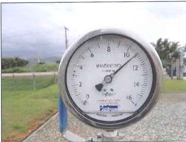
Figura 21: Manômetro com infiltração de água
