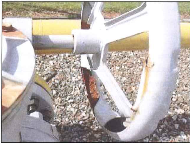
Figura 26: Volante com corrosão
