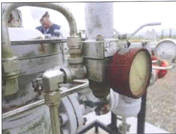
Figura 22: Manômetro com corrosão
