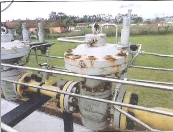
Figura 20: Válvulas com corrosão
