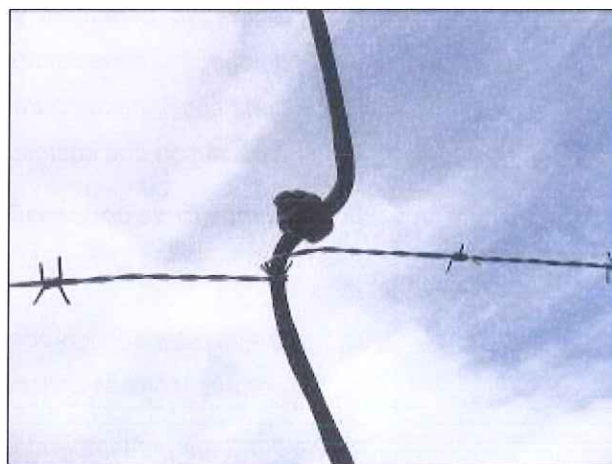
Figura 7: Conexão da cordoalha de aterramento aos arames da cerca está inadequada
