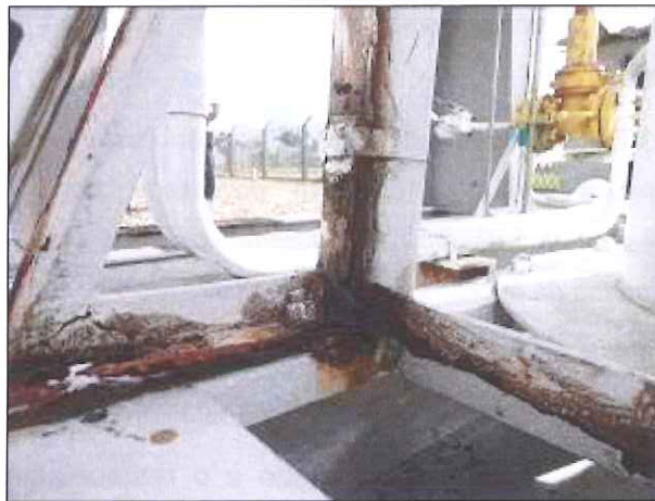
Figura 10: Corrosão na estrutura do SDO
