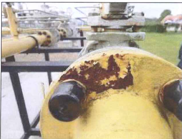
Figura 15: Conexão com corrosão
