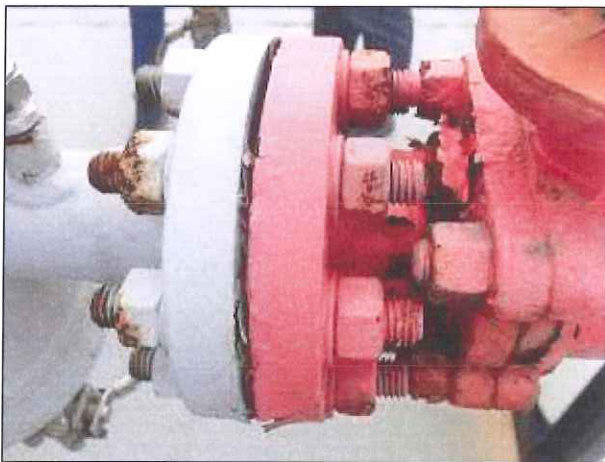
Figura 16: Conexão com corrosão
