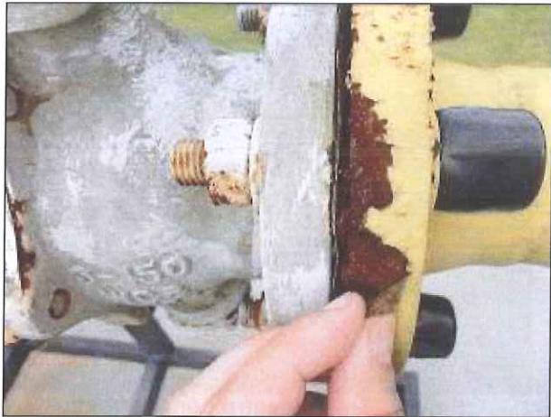
Figura 14 – Conexão com corrosão
