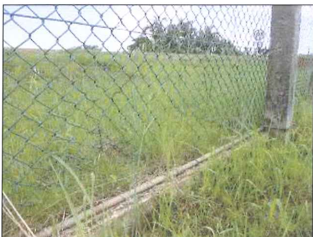
Figura 2: Tela oxidada e rompida em vários pontos
