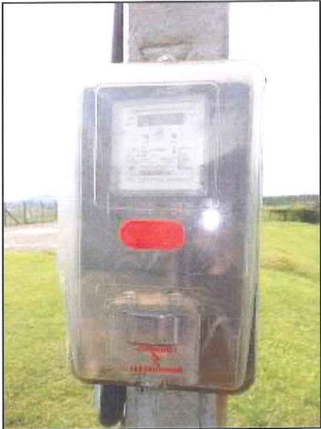
Figura 30: Medidor de energia sem cadeado
