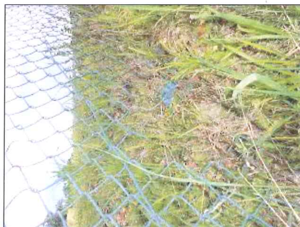
Figura 5: Tela oxidada e rompida em vários pontos
