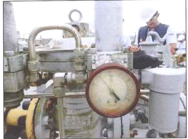
Figura 23: Manômetro com corrosão
