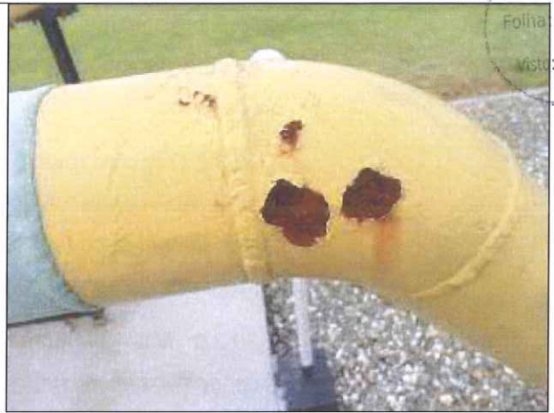
Figura 27: Tubulação com corrosão
