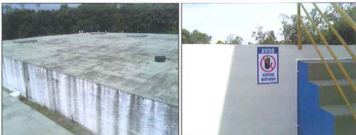
Figura 2: Reservatórios anexos à ETA
