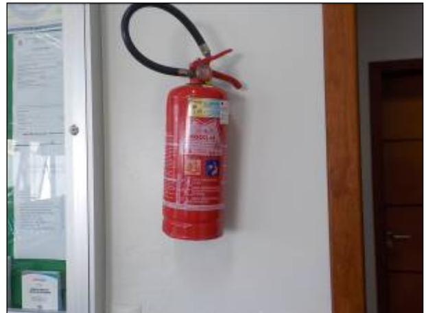
Figura 6: Aparelho contendo produto extintor de incêndio do tipo BC disponível na sala de atendimento.
