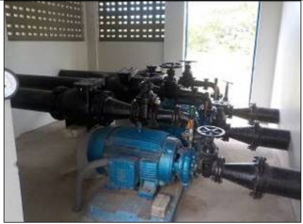
Figura 22: Moto bombas da Estação de Recalque da ETA I.
