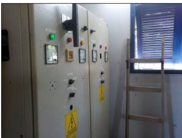
Figura 13: Vista do Quadro de Comando da ERAT FUCAP.
