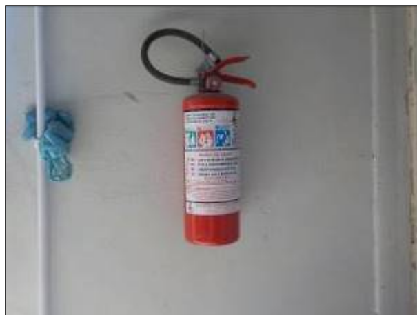
Figura 8: Cilindro contendo pó químico extintor de incêndio em boas condições de uso (pressão, lacre e casco).
