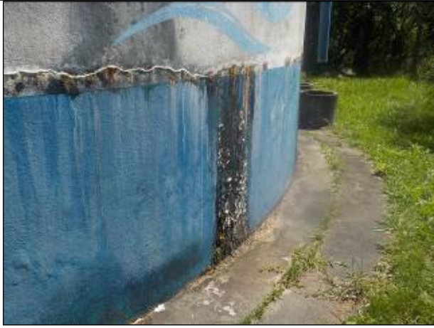
Figura 23: Detalhe das infiltrações no Reservatório R 3.
