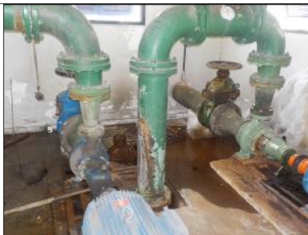
Figura 12: Duas Moto Bombas de 50 Cv, ERAT FUCAP
