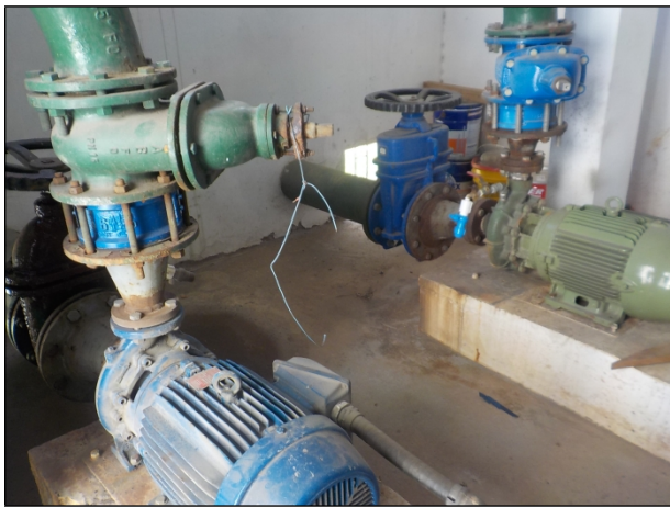
Figura 19: Duas Moto Bombas ERAT Paraíso com 30 CV, cada.
