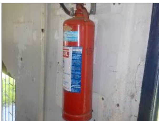
Figura 14: Cilindro contendo pó químico extintor de incêndio em boas condições de uso (pressão, laque e casco).
