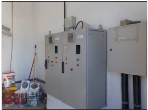
Figura 20: Vista do Quadro de Comando da ERAT Paraíso.
