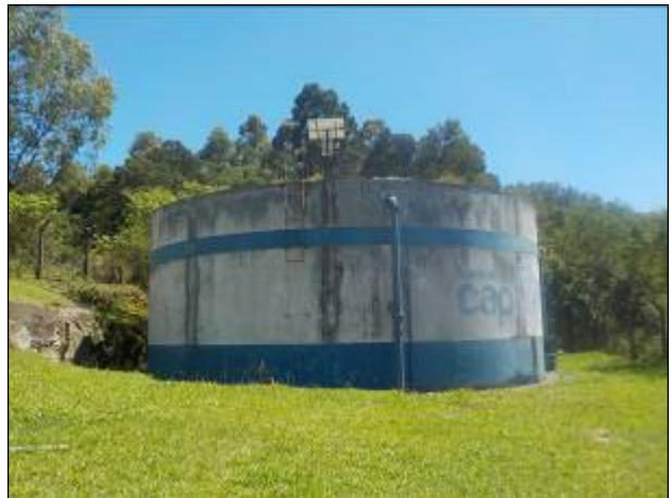
Figura 22: Vista do reservatório R 3, aos sábados é esvaziado e funciona como caixa de passagem.
