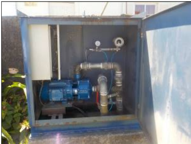
Figura 21: Vista do Booster Santa Lúcia, contendo uma bomba em funcionamento e uma reserva (no almoxarifado).
