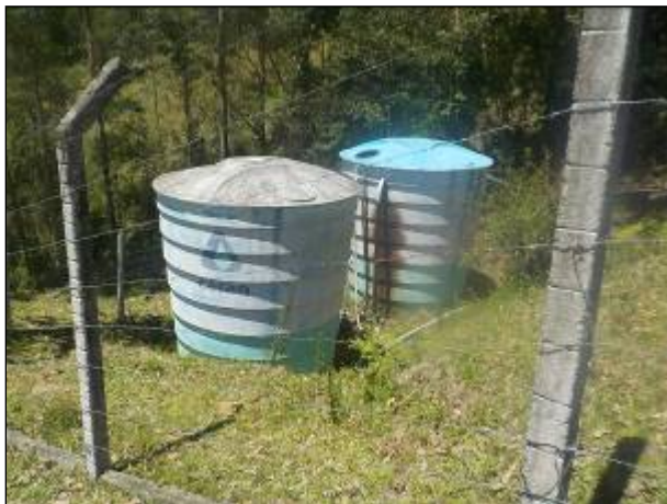
Figura 11: Reservatório Varginha dispostos junto à ETA de Varginha (2 x 20 m 3 ). Planejamento para ser desativado com implantação de outro (2 x 25 m 3 ) em local próximo ao atual.
