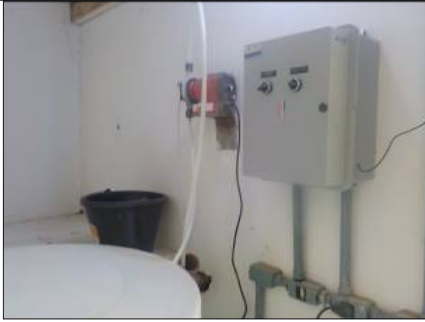
Figura 9: Vista do sistema de tratamento (desinfecção) disponível na ETA de Varginha.
