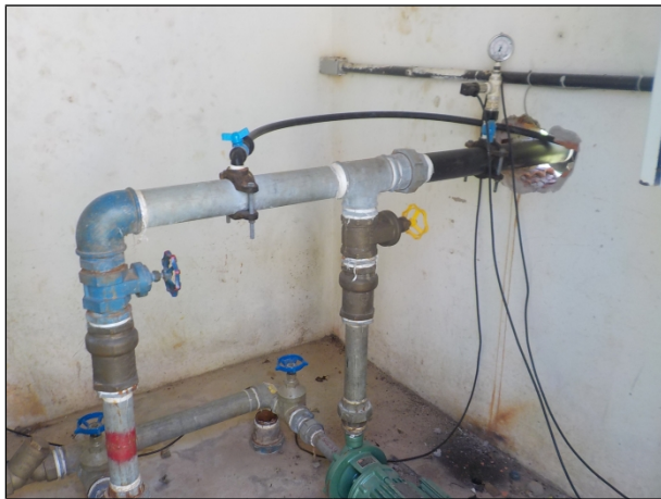
Figura 13: Vista de parte da estrutura do Booster de Pescaria Brava, em funcionamento. Com sua implantação, em julho de 2020, o Reservatório Centro (cemitério) foi desativado.
