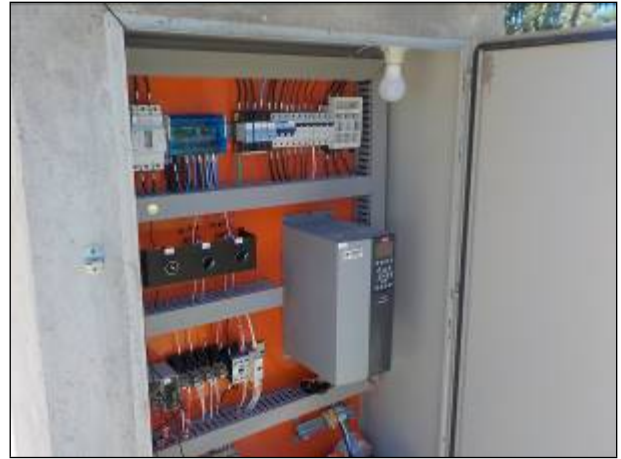
Figura 16: Vista do Quadro de Comando disponível no Poço de Barreiros.
