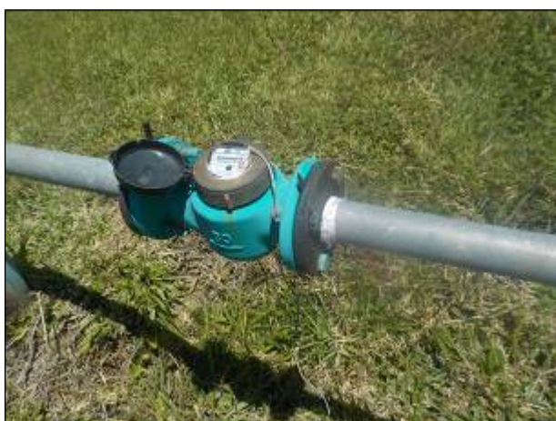
Figura 7: Vista do macromedidor disponível no Poço Varginha, o qual faz a medição do volume d'água enviado para a ETA de Varginha.
