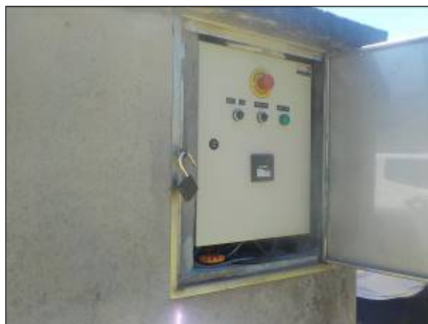
Figura 6: Quadro de Comando Poço Varginha
