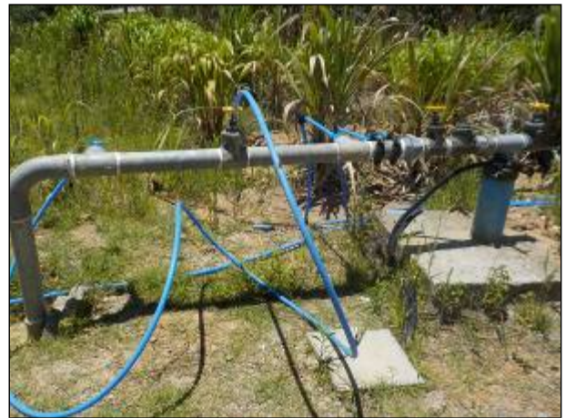
Figura 14: Poço Barreiros contendo o tratamento com cloro (desinfecção) e ortopolifosfato (proteção da tubulação).
