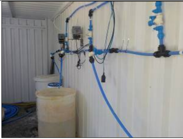
Figura 15: Vista do sistema de dosagem dos produtos químicos do poço de Barreiros; em funcionamento provisório no momento da fiscalização.
