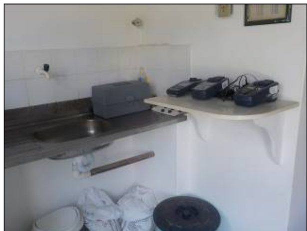
Figura 12: Aparelhos utilizados para controle da qualidade da água tratada. Exames laboratoriais mais completos são enviados ao município de Armazém (mesma concessionária).
