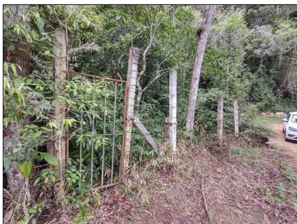
Figura 1: Portão de entrada e cercamento da captação no Rio Cachoeira, condições pouco satisfatórias.
