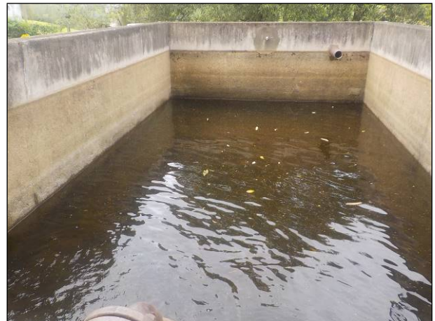
Figura 18: Estrutura disponível no terreno da ETA São Martinho.
