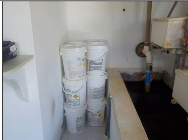
Figura 10: Detalhe do acondicionamento dos produtos químicos na ETA São Martinho, devem estar sobre paletes e isolados.
