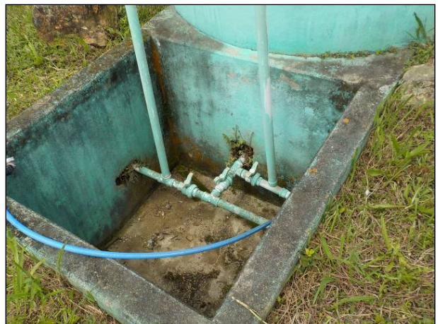
Figura 32: Equipamentos disponíveis no Reservatório Rio Gabiroba, condições satisfatórias.
