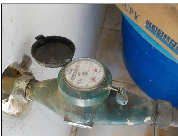
Figura 24: Vista do medidor de água bruta disponível no local.
