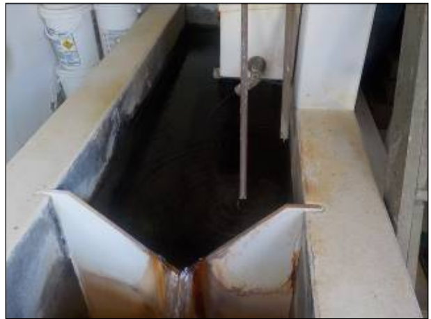
Figura 8: Vista da parte interna da chegada da água bruta, proveniente do Rio Cachoeira, na ETA São Martinho.
