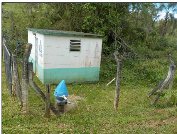
Figura 26: Vista do equipamento para realizar a desinfecção da água bruta (azul) após esta ser captada no local ao fundo.
