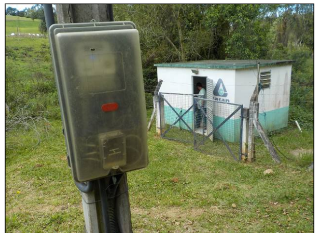
Figura 20: Vista do relógio medidor de energia, sem cadeado de proteção, e ao fundo a Casa de química e local onde estão dispostas as bombas na comunidade de Rio Gabiroba
