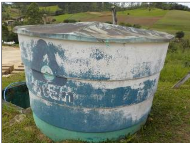
Figura 31: Reservatório Gabiroba, pintura não satisfatória, tampa e estrutura em boas condições.
