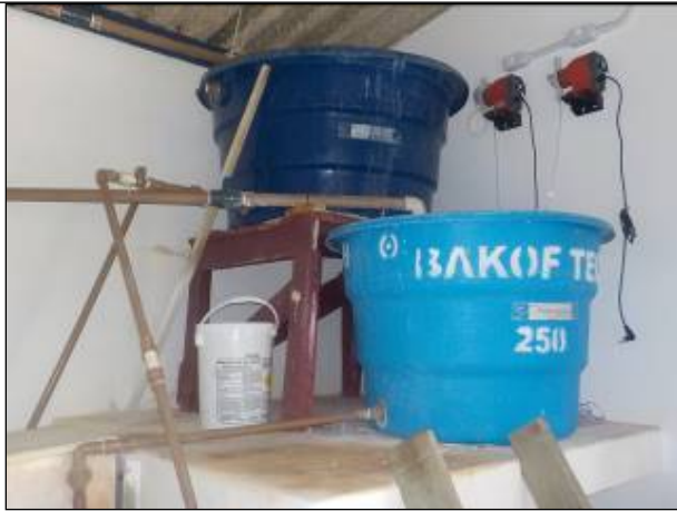
Figura 9: Detalhe do tratamento químico na ETA São Martinho, dosadores instalados (superior direito).
