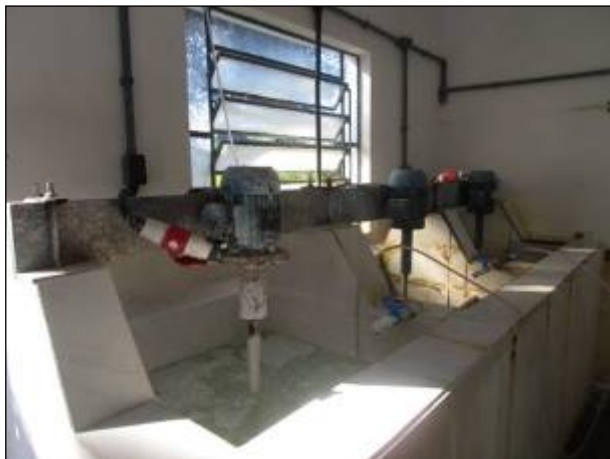
Figura 23: Equipamentos em funcionamento na dosagem de produtos químicos na ETA (junho 2019).
