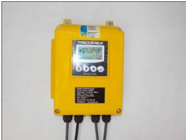
Figura 59: Aparelho eletrônico medidor de vazão do Poço 01 (outubro 2020).
