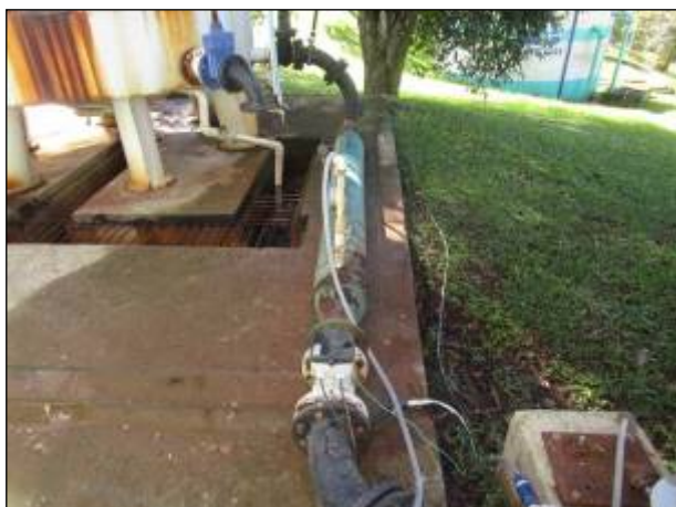
Figura 29: Outra vista em detalhe do Sistema de filtro/floccodcantador (junho 2019).
