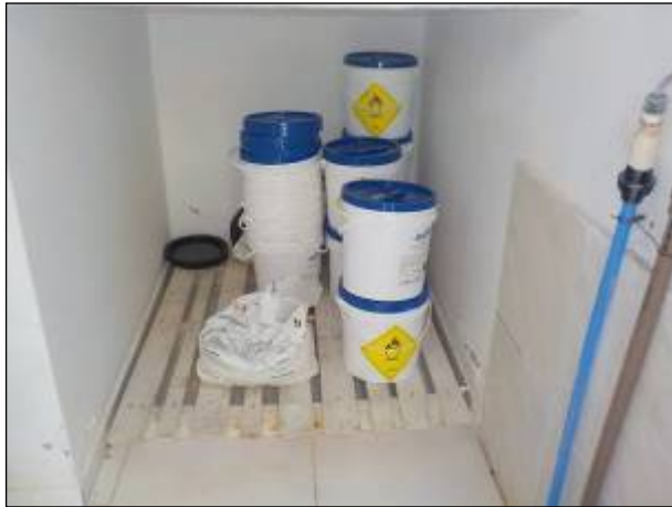
Figura 45: Armazenamento do Hipoclorito de Cálcio nas dependências da ETA (outubro 2020).
