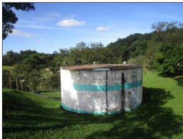
Figura 32: Vazamento aparente no R 01, danificando parte da estrutura (junho 2019).
