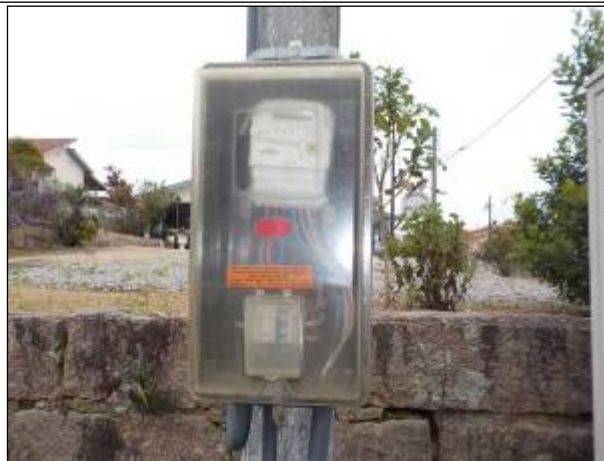
Figura 75: Quadro de energia junto ao Booster 01 , desprotegido (outubro 2020).
