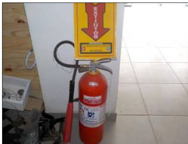
Figura 12: Equipamento contendo dióxido de carbono, um agente extintor de incêndio do tipo BC, em boas condições de uso (outubro 2020).
