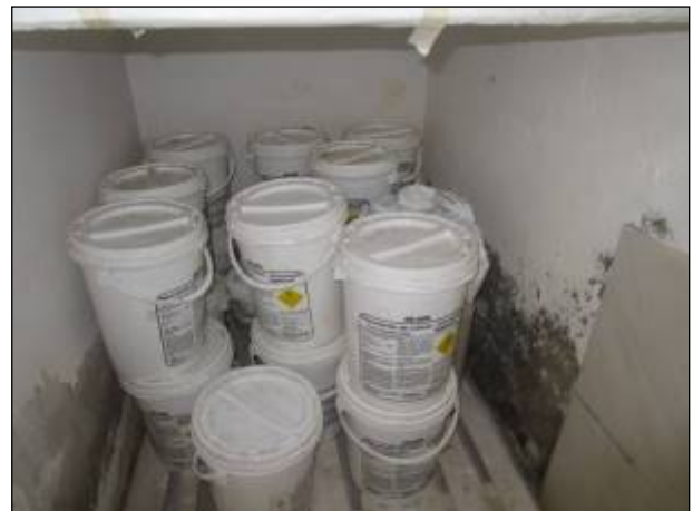
Figura 24: Armazenamento do Hipoclorito de Cálcio nas dependências da ETA (junho 2019).
