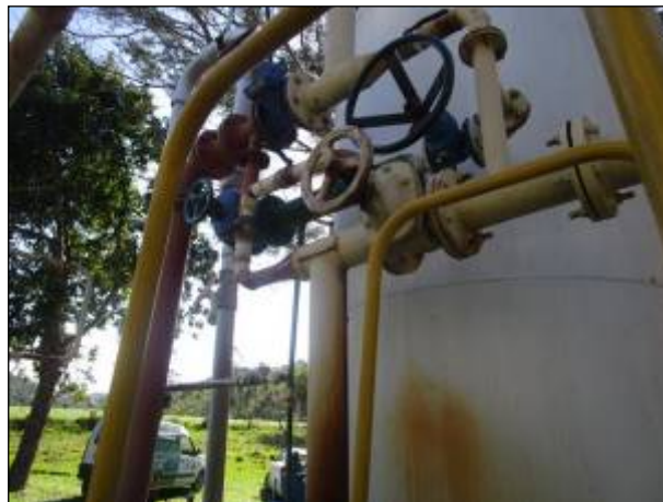
Figura 28: Sinais de corrosão e pequenos vazamentos no sistema de filtro/floccodntação (junho 2019).
