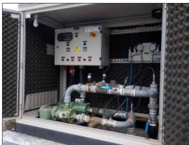
Figura 73: Vista da parte interna do Booster 01, contendo o painel de controle e as bombas (outubro 2020).
