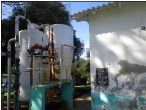
Figura 27: Vista da parede externa da casa de química/laboratório e ao fundo o sistema de filtro e floccodcantador na ETA (junho 2019).
