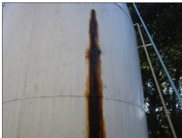
Figura 30: Floccodcantador com forte corrosão na estrutura (junho 2019).
