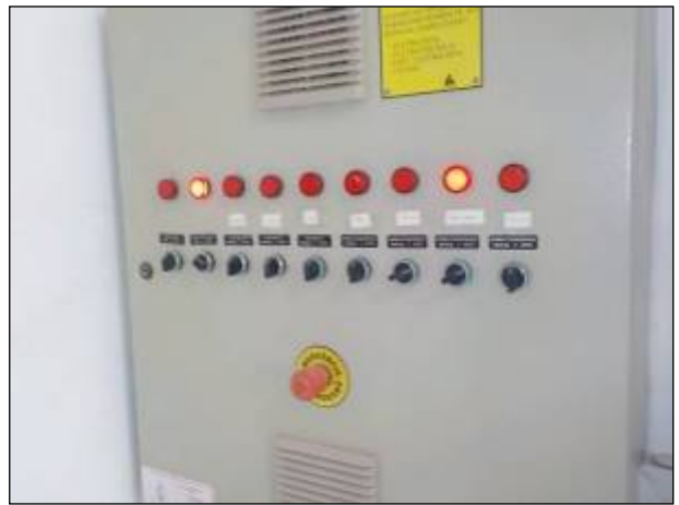
Figura 42: Quadro de Comando, localizado na área interna do imóvel construído na ETA (outubro 2020).
