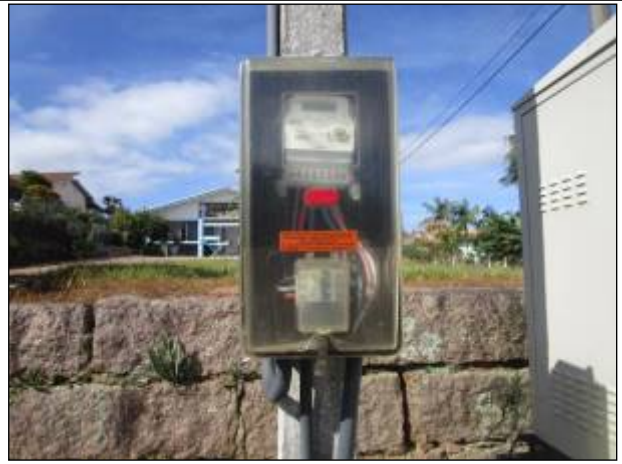
Figura 40: Quadro de energia junto ao Booster 01, sem proteção para o acesso de pessoas estranhas (junho 2019).
