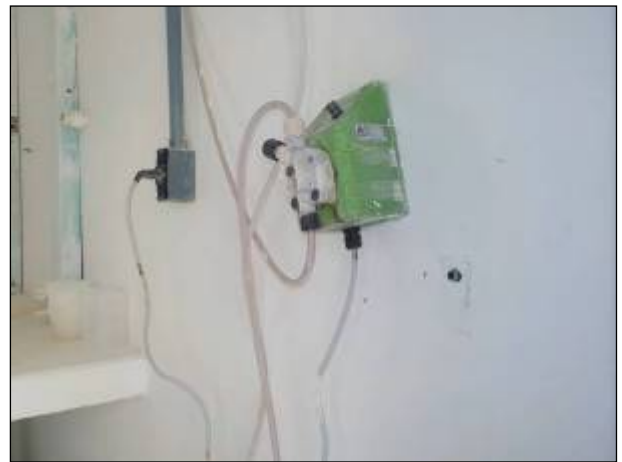
Figura 44: Equipamento em funcionamento na dosagem de produtos químicos na ETA (outubro 2020).
