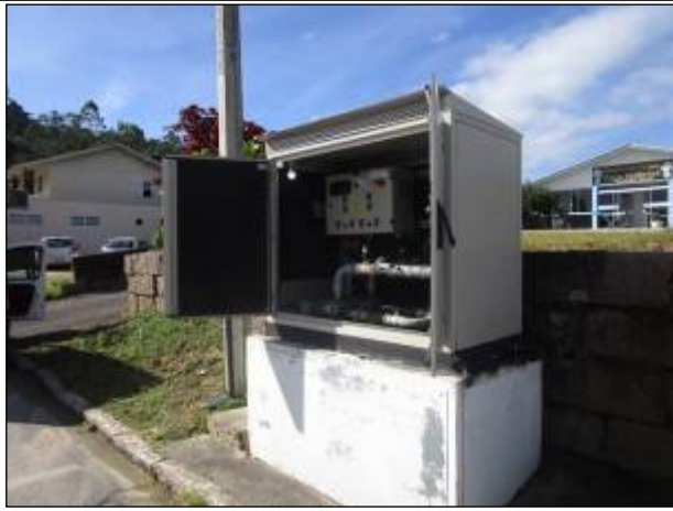
Figura 39: Booster 01, na Avenida Sete de Setembro, instalado recentemente (junho 2019).
