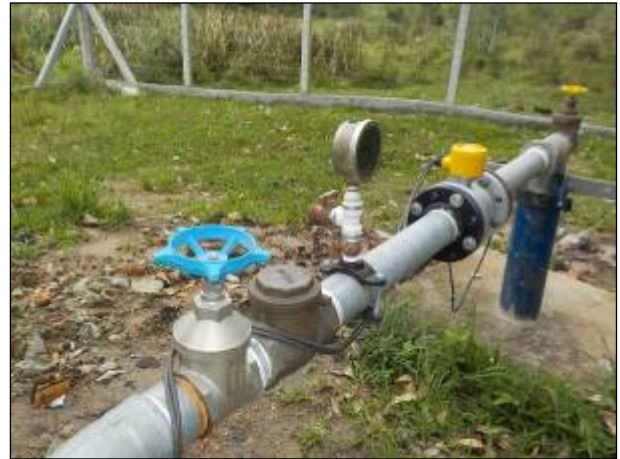
Figura 58: Vista da área de captação e da tubulação que faz a adução da água bruta (outubro 2020).
