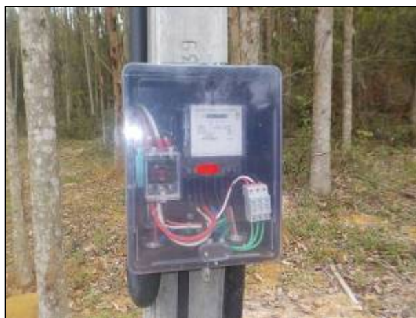
Figura 54: Aparelho de medição de energia instalado próximo à entrada da propriedade, sem cadeado de proteção (outubro 2020).
