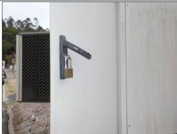
Figura 74: Vista do quadro de proteção com cadeado, porém sem placas informativas e restritivas da unidade (outubro 2020).
