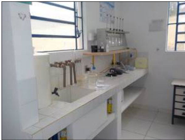
Figura 47: Bancada com os equipamentos disponíveis para testes e verificações na ETA Treze de Maio (outubro 2020).
