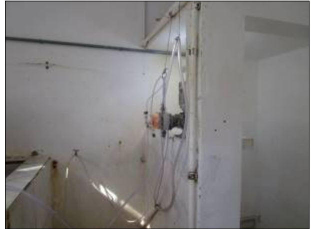
Figura 22: Equipamento dosador dos produtos químicos na área de tratamento da água (junho 2019).
