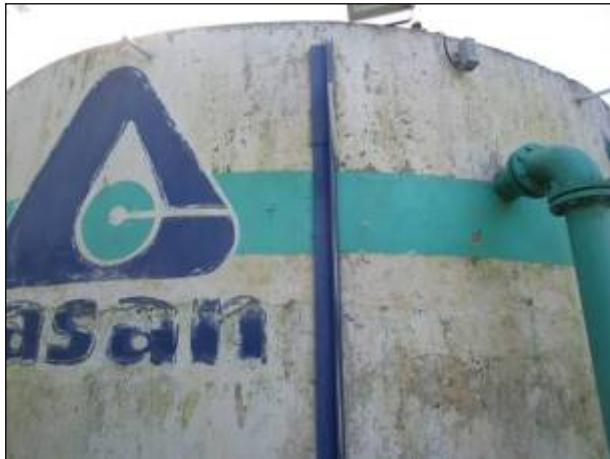
Figura 33: Detalhe do R 01, pintura e estrutura sem manutenção recente (junho 2019).
