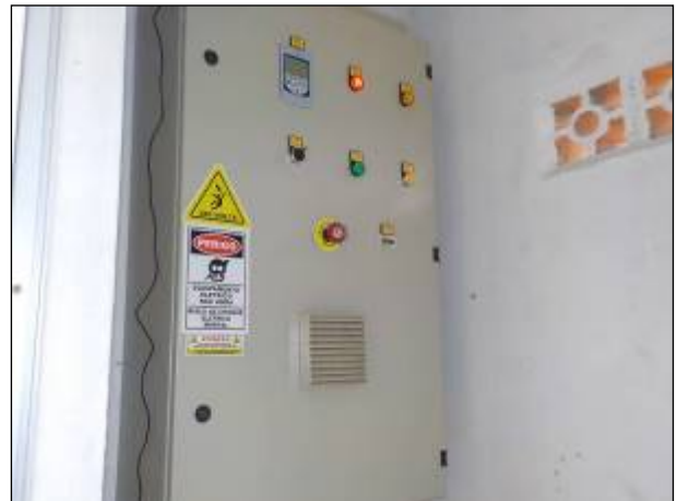
Figura 60: Quadro de comando localizado em área protegida, junto à Captação do Poço 01 (outubro 2020).
