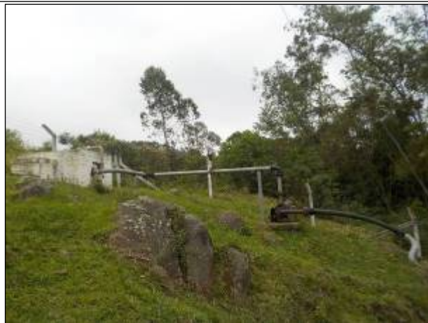
Figura 68: Vista da área da antiga captação superficial no rio Coruja, com os equipamentos desativados (outubro 2020).
