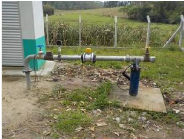
Figura 57: Vista geral da área de captação e da tubulação que faz a adução da água bruta (outubro 2020).
