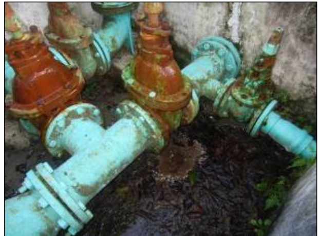
Figura 34: Vazamento, na saída para a rede de abastecimento, do R 01 (junho 2019).
