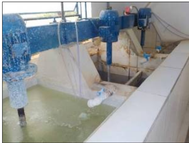
Figura 43: Equipamentos em funcionamento na dosagem de produtos químicos na ETA (outubro 2020).
