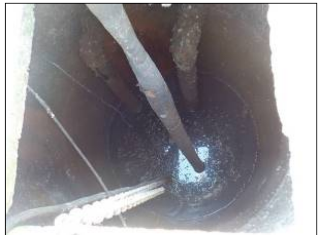
Figura 138: Detalhe do Poço de Sucção da EEE 03.
