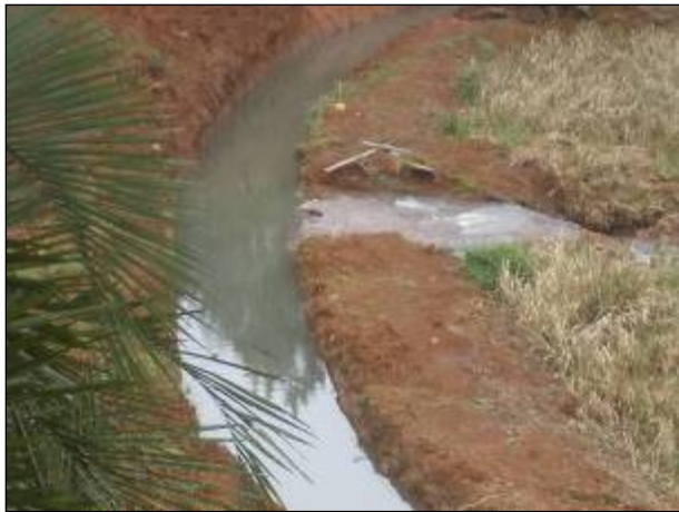
Figura 27: Detalhe do desvio feito no Lajeado Catanduvras para que este passe pela captação provisória, montada para a manutenção da Barragem de Captação.
