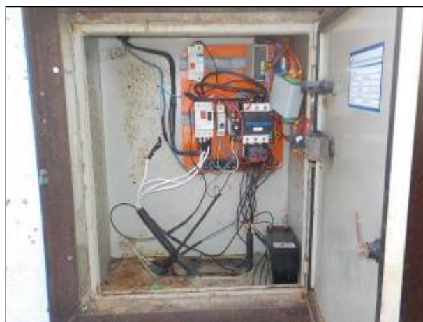
Figura 144: Vista em detalhe da seção interna do Painel de Controle da EEE 04.
