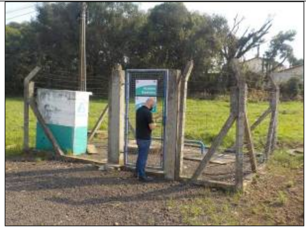
Figura 134: Vista geral da área onde está localizada a EEE 03, local cercado e trancado, portanto protegido.
