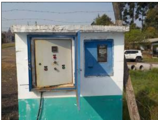
Figura 135: Vista externa do painel de controle e do medidor de energia elétrica da EEE 03.
