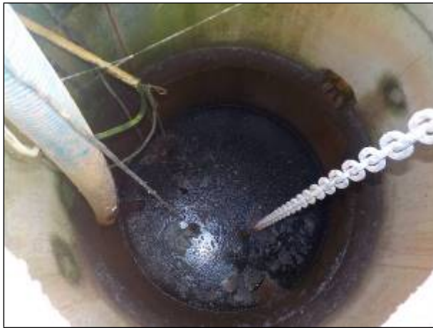
Figura 147: Poço do EEE 05.
