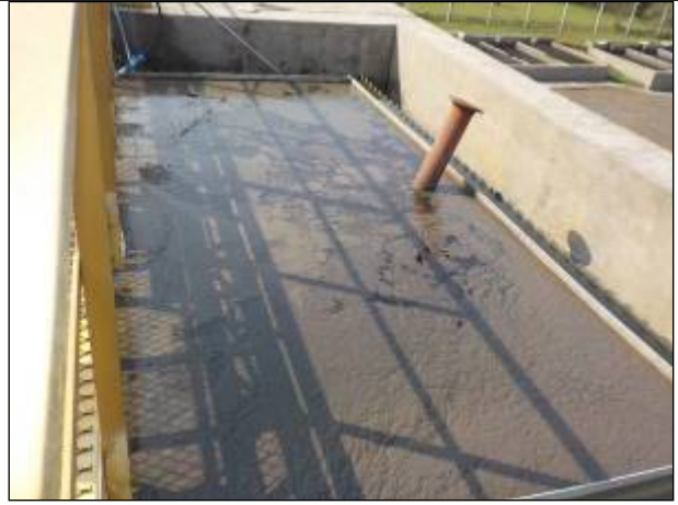
Figura 110: Detalhe do tratamento realizado por decantação na ETE Catanduvas; ao fundo o leito de secagem do lodo.
