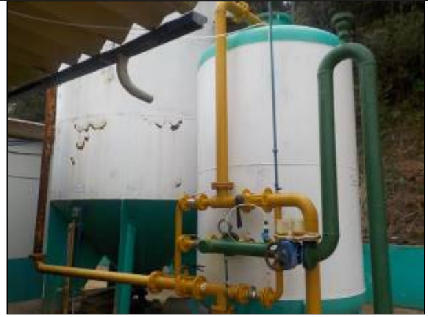
Figura 38: Equipamentos disponíveis para o Tratamento da Água Bruta na ETA Catanduvas.
