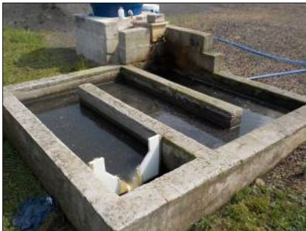
Figura 111: Vista geral do Tanque de Contato que auxilia na desinfecção (por hipoclorito de cálcio), processo final de tratamento de esgoto.
