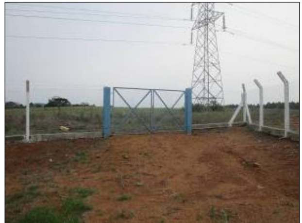
Figura 90: Vista da entrada de veículos no reservatório do Casagrande, o qual ainda não é parte do SAA Catanduvas.
