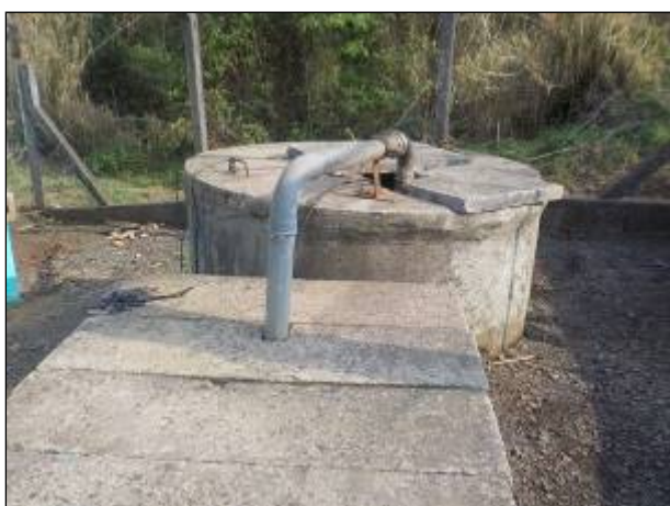
Figura 125: Vista da área interna onde está localizada a EEE 01.
