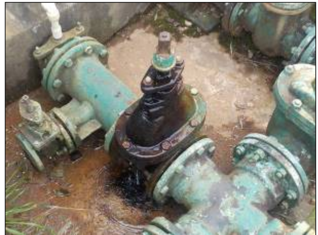
Figura 66: Detalhe da saída de água tratada dos reservatórios.
