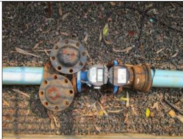
Figura 44: Detalhe do macromedidor de entrada de água bruta da ETA Catanduvás.
