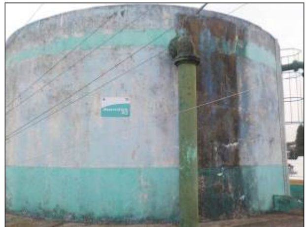
Figura 64: Vista parcial do reservatório R-02, com capacidade de reservação de 300 m³.
