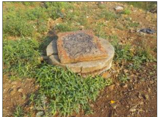
Figura 150: Detalhe do Poço onde armazena-se o esgoto para elevação até o Poço da EEE 04, visto na figura 140.
