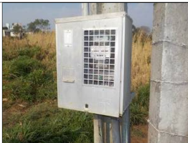
Figura 128: Vista do medidor de energia elétrica junto à EEE 01.
