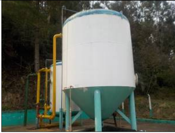
Figura 37: Equipamentos disponíveis para o Tratamento da Água Bruta na ETA Catanduvas.
