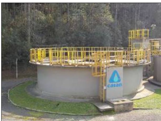
Figura 101: Vista geral de um dos tanques de aeração disponíveis na ETE de Catanduvras.
