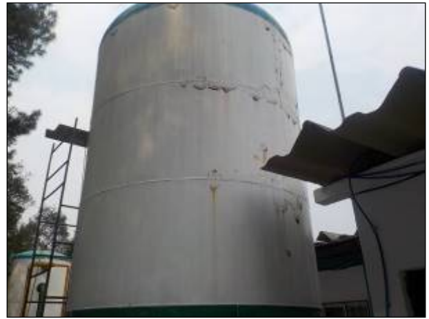
Figura 40: Equipamentos disponíveis para o Tratamento da Água Bruta na ETA Catanduvas.
