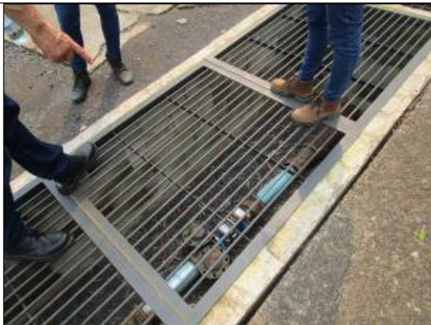
Figura 43: Local onde está instalado o macromedidor de água bruta, ou seja, na Entrada da ETA Catanduvás.
