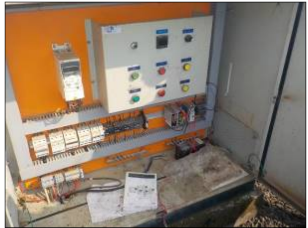
Figura 148: Detalhe do Painel de Controle da EEE 05.
