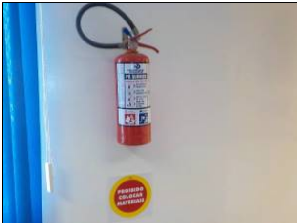
Figura 7: Cilindro contendo pó químico extintor de incêndio em boas condições de uso (pressão, lacre e casco)
