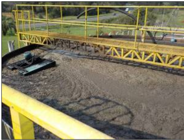
Figura 105: Equipamento aerador, em funcionamento, em um dos tanques.
