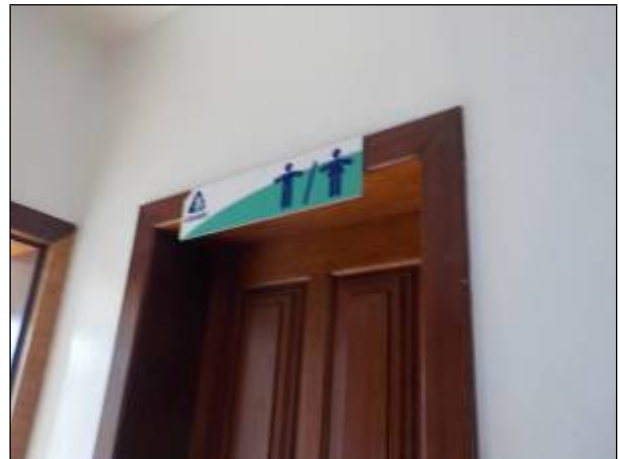
Figura 6: Placa informativa do banheiro compartilhado, seu interior em boas condições.
