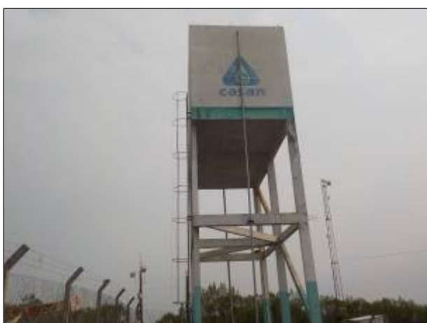
Figura 83: Vista em detalhe da escada de acesso e da estrutura elevado que contém os 2 reservatórios de fibra de 26 m 3 cada.
