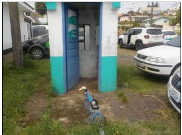
Figura 30: Vista da área onde está localizado o Poço 02 (Poço da Polícia), com sua estrutura externa e local onde se localiza o Painel de Controle. A Concessionária deve finalizar o cercamento da área até o início do ano de 2021.
