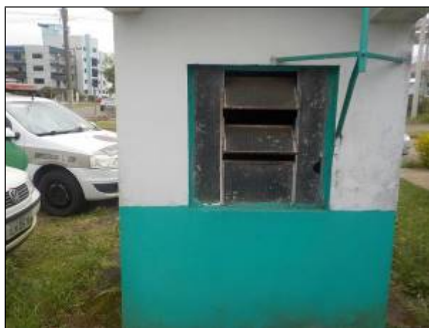
Figura 34: Vista da área externa, fundos, do local onde o Painel de Controle está localizado.
