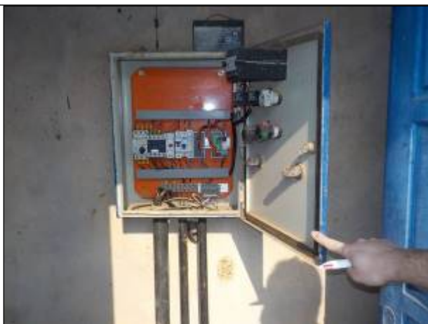
Figura 127: Vista do painel de controle da EEE 01.
