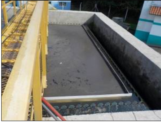
Figura 109: Detalhe do tratamento realizado por decantação secundária na ETE Catanduvas.
