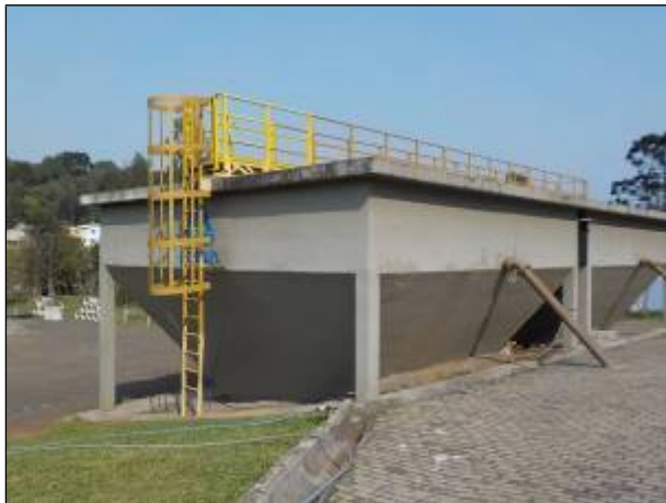
Figura 107: Vista parcial do local onde é realizada a decantação secundária, com destaque para a escada e passarela de acesso.
