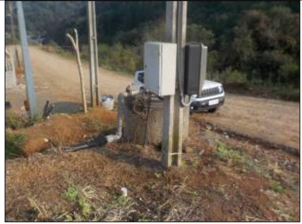
Figura 152: Vista geral da EEE 07, com seu painel de controle e medidor de energia elétrica expostos, pois a unidade não possui o cercamento protetivo e placas de restrição e indicativas da unidade.
