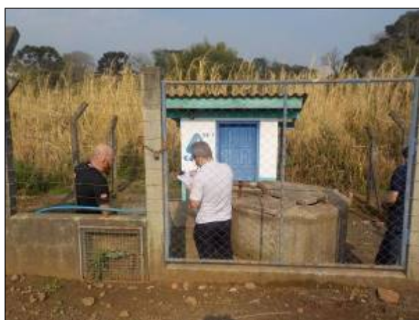
Figura 124: Vista parcial frontal da EEE 01, localizada às margens da Estrada da Pedra Lisa.
