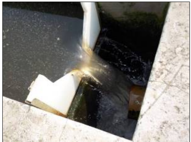
Figura 112: Produto final do tratamento de esgoto, após a cloração realizada no tratamento terciário, o qual será despejado no Lajeado Catanduvas.
