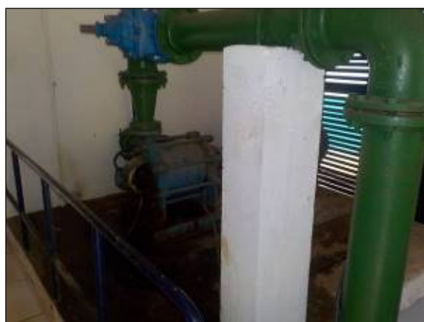
Figura 54: Vista da bomba que faz o recalque da água já tratada, denominada ERAT 01.
