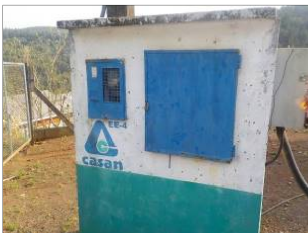
Figura 143: Vista do medidor de energia e das portas externas dos Painéis de controle das EEE 04 (ao centro) e EEE 06 (na lateral direita).
