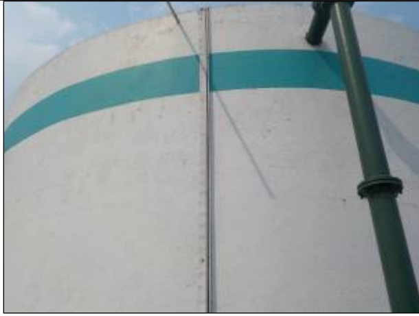
Figura 73: Vista em detalhe da tubulação utilizada para o extravasamento da água excedente no R-03.
