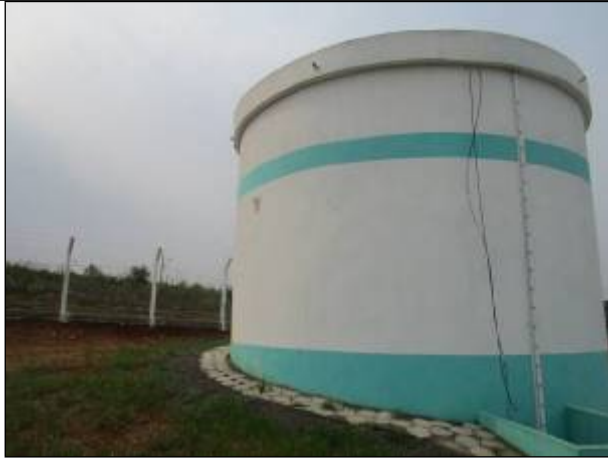
Figura 85: Vista parcial do reservatório a ser ativado, ainda não fazendo parte do sistema público de abastecimento de Catanduvas, localizado no Casagrande.
