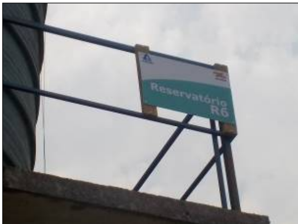
Figura 77: Detalhe da placa indicativa do reservatório R-06 (Covalan), afixada na parte superior lateral da estrutura.
