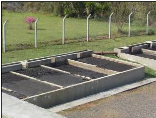
Figura 113: Vista parcial de um dos leitos de secagem de lodo na ETE de Catanduvas.
