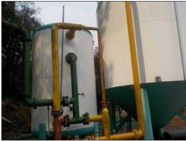
Figura 39: Equipamentos disponíveis para o Tratamento da Água Bruta na ETA Catanduvas.
