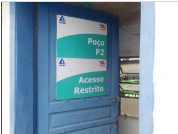
Figura 29: Poço 02, também denominado Poço da Polícia, e a porta de acesso ao local onde fica o painel de controle. Porta trancada com cadeado e placas indicativas da unidade e de restrição.
