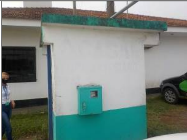
Figura 31: Vista da parede lateral externa do local onde o Painel de Controle está localizado.
