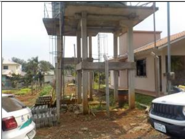
Figura 79: Vista frontal da estrutura construída para elevar os reservatórios componentes do R-06; no solo estão os materiais para finalização da construção e à frente pode-se observar os postes que serão a estrutura do cercamento futuro.
