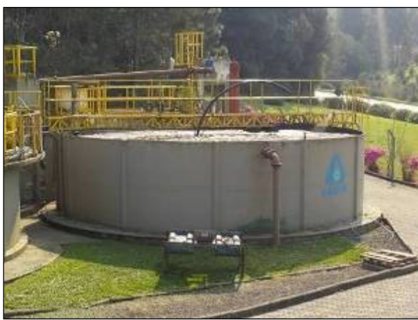
Figura 102: Vista geral de um dos tanques de aeração disponíveis na ETE de Catanduvras.
