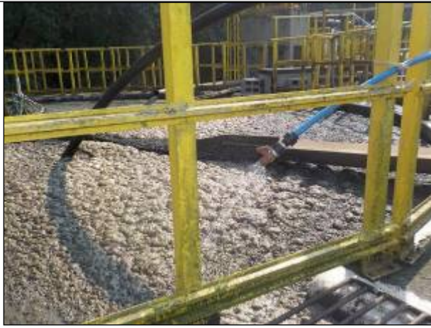
Figura 103: Detalhe do Tanque de Aeração em funcionamento.
