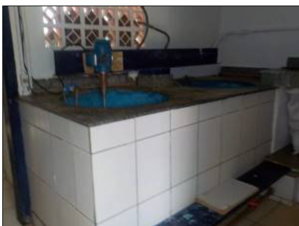
Figura 45: Área interna reservada para mistura dos produtos químicos utilizados no tratamento da água na ETA Catanduvás.
