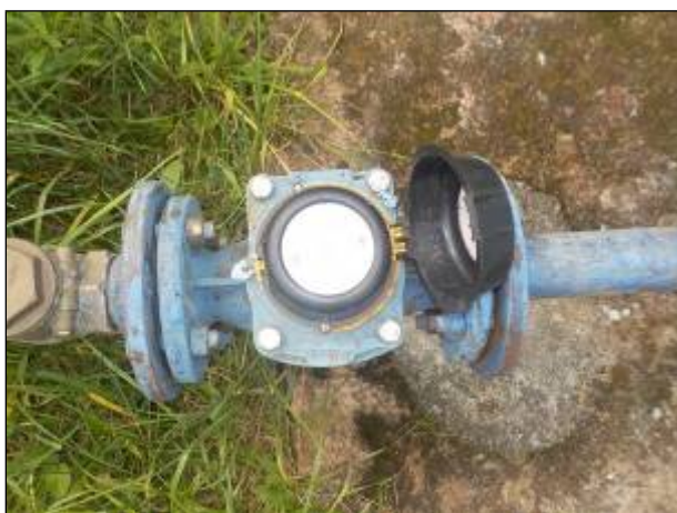
Figura 33: Detalhe do medidor de vazão do Poço 02, em Catanduvás.
