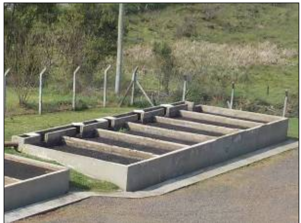
Figura 114: Vista de um dos leitos de secagem de lodo na ETE Catanduvas.
