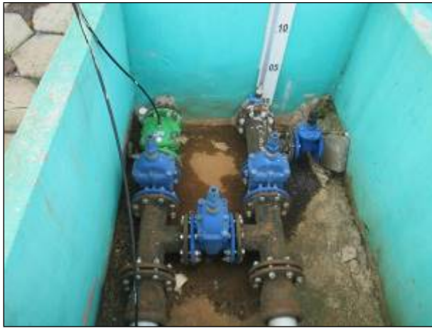
Figura 87: Equipamentos na dispostos na saída do reservatório do Casagrande.
