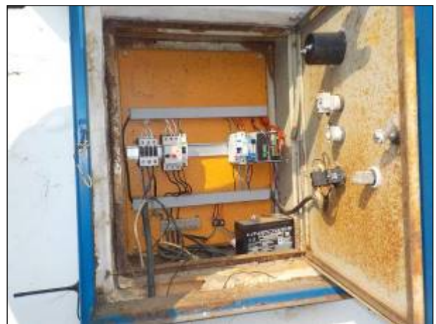
Figura 136: Detalhe da parte interna do Painel de Controle da EEE 03; na área externa, abaixo e à esquerda, a antena de comunicação remota.
