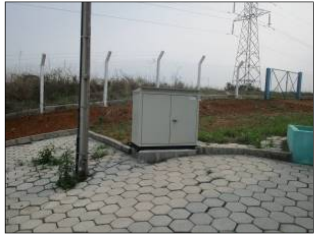
Figura 88: Equipamento junto ao reservatório do Casagrande
