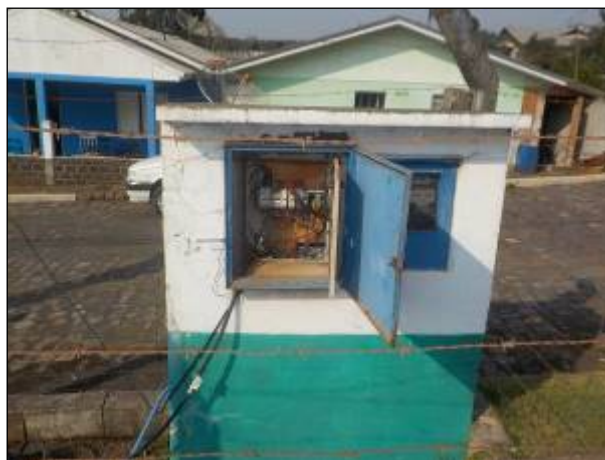
Figura 130: Vista do Painel de Controle e do medidor de energia elétrica localizados na área da EEE 02.
