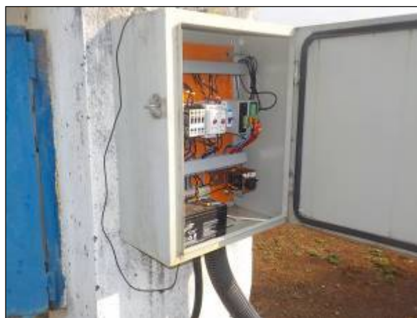
Figura 142: Detalhe do Painel de Controle da EEE 06 instalado na área da EEE 04; a EEE 06 está a cerca de 100 metros deste ponto, em cota mais baixa.
