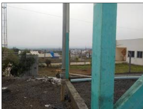
Figura 84: Vista em detalhe da parte de trás do R-07, com o registro para controle da vazão de saída da água reservada.
