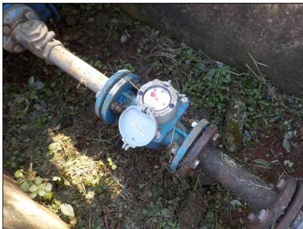
Figura 9: Vista da estrutura onde está o macromedidor na ETA.
