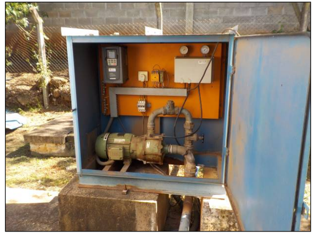
Figura 8: Vista da parte interna do booster 1 , em operação.
