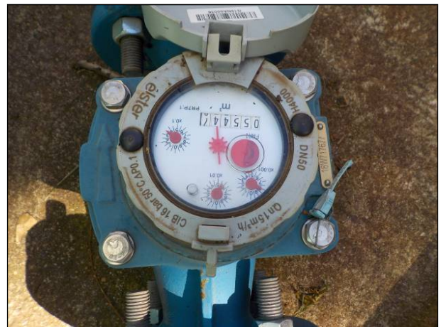
Figura 10: Vista em detalhe do macromedidor.
