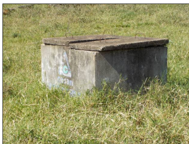
Figura 4: Vista do Poço 1, sem proteção externa (cercamento) e indicação da unidade ilegível. A unidade está em terreno próximo à ETA.
