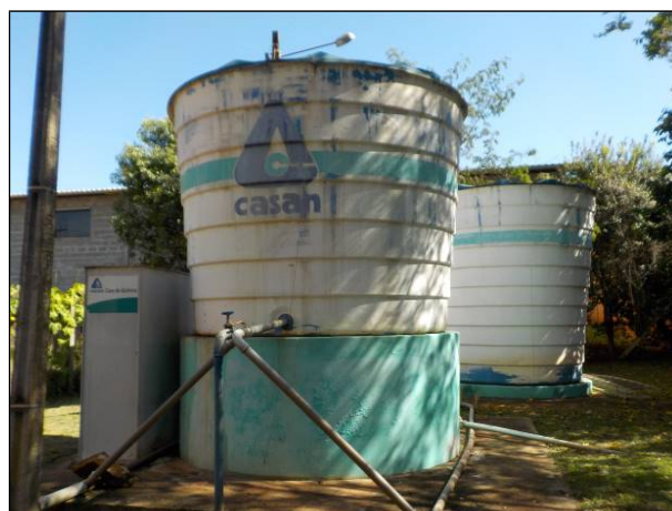
Figura 6: Reservatório R1, identificado e operando normalmente.
