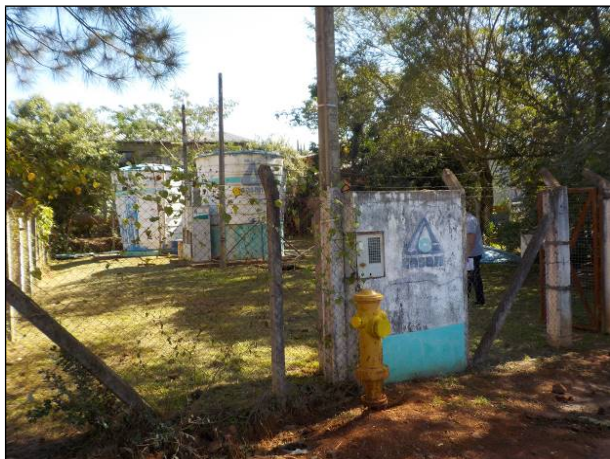
Figura 1: Vista da área onde estão a totalidade dos equipamentos do SAA São Bernardino, exceção ao Poço 1.
