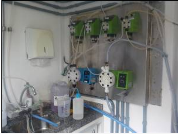
Figura 15: Equipamentos para dosagem dos produtos químicos no interior da Casa de Química.
