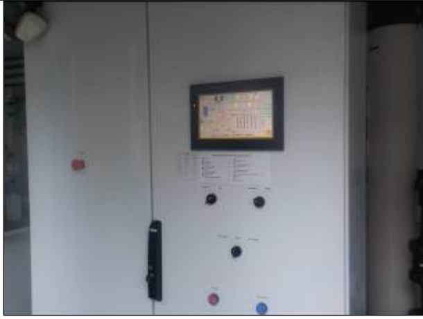
Figura 111: Vista do Painel de Controle instalado no local, em funcionamento.
