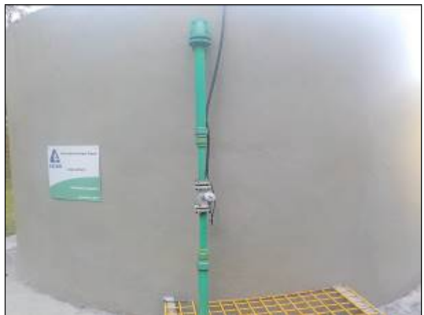
Figura 18: Vista do medidor de nível do reservatório e da placa de identificação, ambos em bom estado de conservação.
