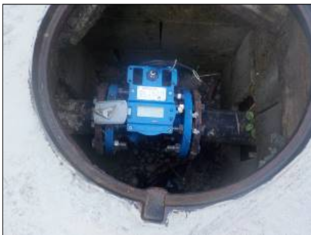
Figura 19: Vista do macromedidor para reservatório vertical.
