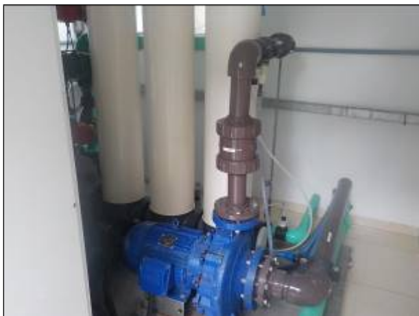
Figura 13: Vista detalhada dos equipamentos disponíveis na ETAU Angelina.
