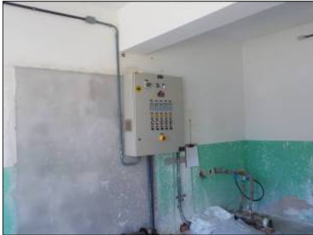
Figura 47: Vista do painel de controle disponível na ETA Balneário Barra do Sul, com estrutura pouco satisfatória principalmente relacionado à limpeza.
