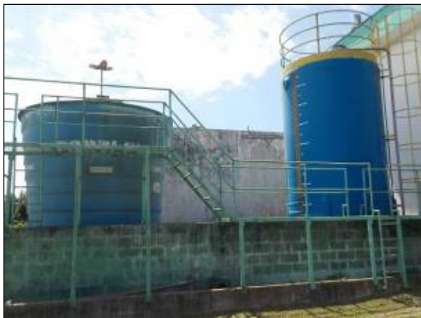
Figura 39: Vista de parte da ETA contendo a estrutura para o tratamento da água.
