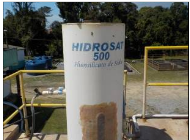
Figura 40: Vista de parte da estrutura, considerada insatisfatória quanto à manutenção, para o tratamento da água na ETA Balneário Barra do Sul.
