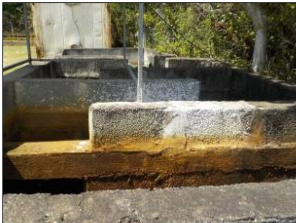
Figura 37: Vista de parte da estrutura de tratamento disponível na ETA Balneário Barra do Sul.
