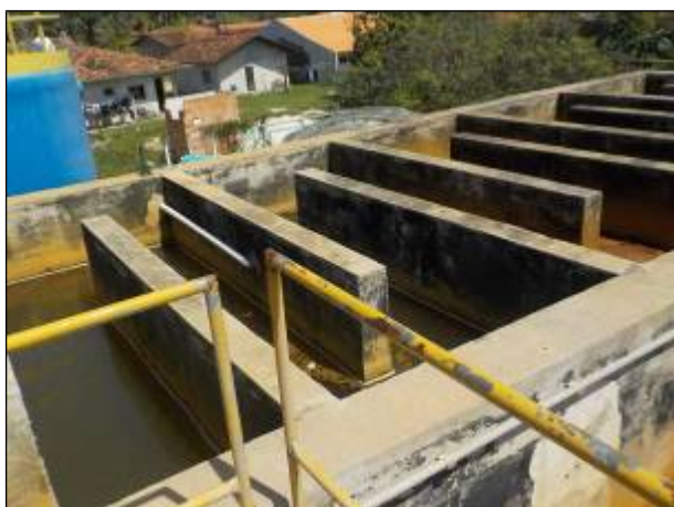
Figura 45: Vista de parte da ETA contendo a estrutura para o tratamento da água.
