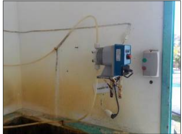
Figura 48: Vista de equipamento dosador de produtos químicos na ETA Balneário Barra do Sul.
