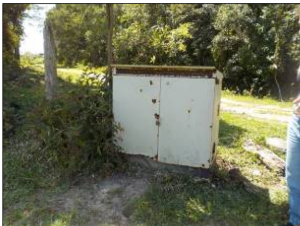
Figura 25: Vista do painel de controle da ERAB 4, em local desprotegido, sem placas de identificação e restrição, bem como sem indicação de que está energizado.
