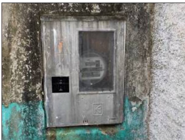
Figura 15: Medidor de energia na ERAB 2, na área externa e sem cadeado para isolamento da chave de desligamento de energia elétrica.
