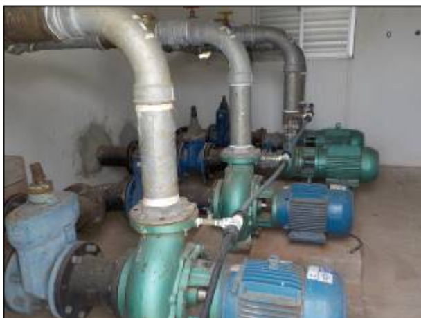
Figura 63: Bombas disponíveis para o Recalque da Água Bruta, localizadas na ETA.
