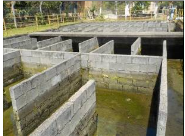
Figura 36: Vista de parte da estrutura disponível, em desuso, na ETA Balneário Barra do Sul.
