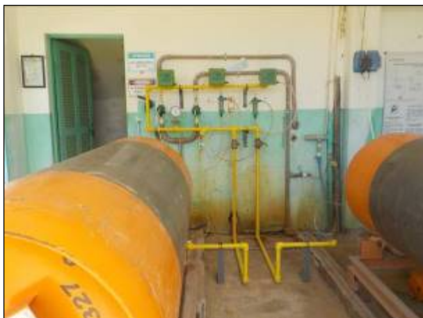
Figura 51: Estrutura montada para armazenamento e utilização de cloro gasoso para a desinfecção da água tratada na ETA Balneário Barra do Sul.
