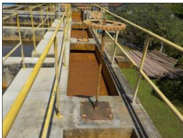
Figura 46: Vista de parte da ETA, necessário dar segurança aos operadores melhorando a estrutura.
