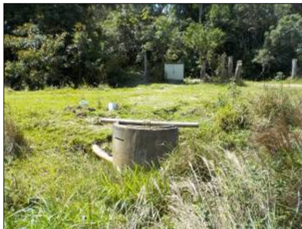
Figura 26: Vista em primeiro plano do poço de inspeção, com água proveniente do Rio Perequê (captação a cerca de 800 metros) e do painel de controle da ERAB 4, ao fundo.
