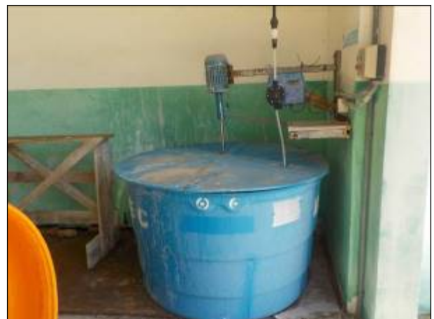
Figura 52: Vista da estrutura montada para armazenamento e utilização de produtos químicos para o tratamento da água na ETA Balneário Barra do Sul.
