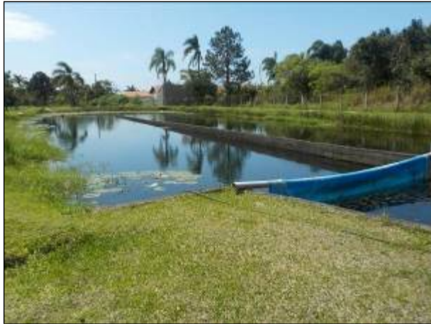
Figura 35: Vista da área interna da ETA Balneário Barra do Sul, especificamente a lagoa de decantação.
