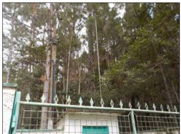
Figura 16: Vista da parte superior na ERAB 2, contendo a antena que transmite informações da unidade para os operadores na central (telemetria).
