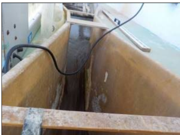
Figura 41: Vista de parte da ETA contendo a estrutura para o tratamento da água.
