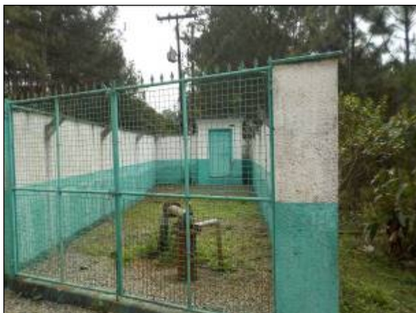
Figura 21: Vista da área externa do Poço 1 e ERAB 1, local isolado e com cadeado, porém sem informação da unidade por placa ou pintura e sem placa restritiva.
