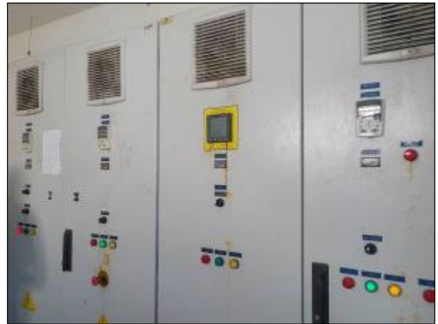
Figura 62: Painel de Controle da ERAT, condições satisfatórias.
