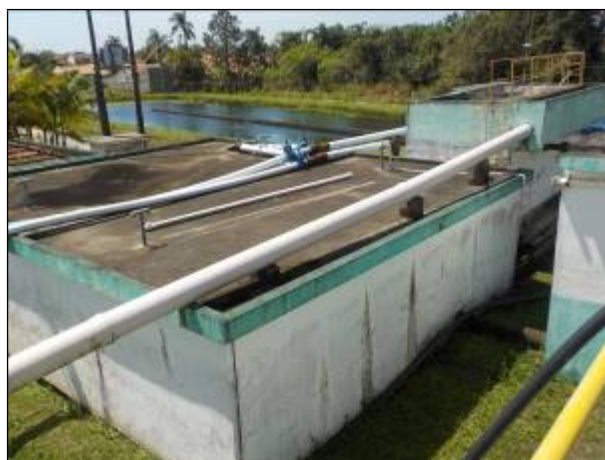
Figura 34: Vista da área interna da ETA de Balneário Barra do Sul, ao fundo a lagoa de decantação.
