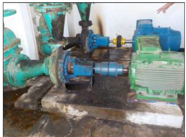
Figura 64: Bombas disponíveis para o Recalque da Água Bruta, localizadas na ETA.
