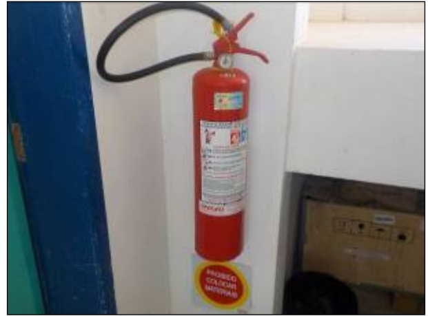
Figura 54: Cilindro contendo pó químico extintor de incêndio em boas condições de uso (pressão, lacre e casco) junto ao laboratório da ETA.
