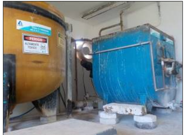
Figura 50: Vista de parte da casa de química para tratamento da água bruta na ETA, necessário dar segurança aos operadores melhorando a estrutura.
