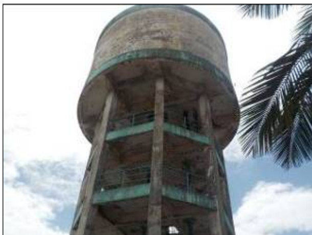
Figura 65: Vista do reservatório R1, localizado na área central de Balneário Barra do Sul.
