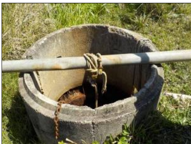
Figura 27: Vista em detalhe do poço de inspeção da ERAB 4, com água superficial do rio Perequê, sem cercamento e placas informativas e de restrição de acesso.
