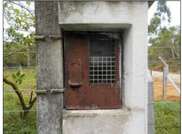
Figura 20: Medidor de energia na ERAB 3, na área externa, enferrujado e sem cadeado para isolamento da chave de desligamento de energia elétrica.
