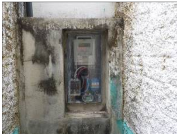
Figura 24: Vista do medidor de energia na ERAB 1, na área externa, sem cadeado para isolamento da chave de desligamento de energia elétrica.
