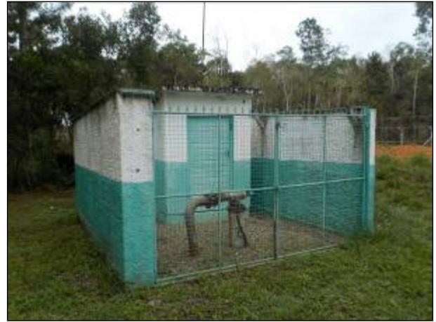
Figura 18: Vista da área externa do Poço 3 e ERAB 3, local isolado e com cadeado, porém sem informação da unidade por placa ou pintura.
