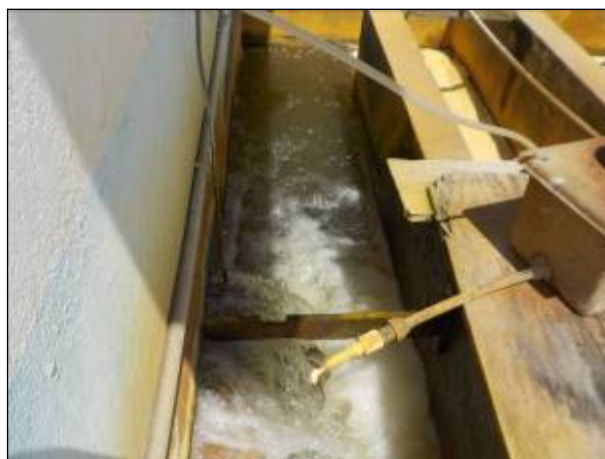
Figura 42: Vista de parte da ETA contendo a estrutura para o tratamento da água.
