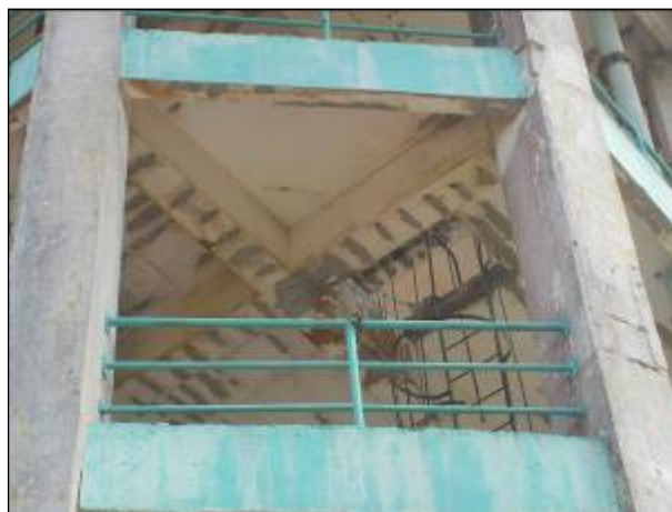
Figura 68: Vista de parte do reservatório R1 necessitando de manutenção e reparos.
