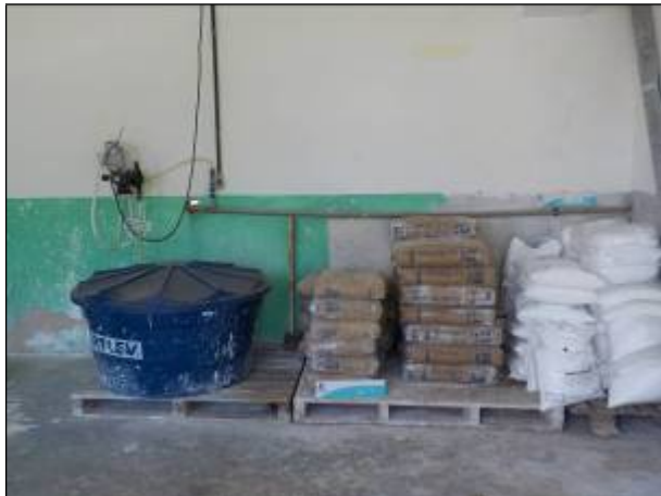
Figura 49: Armazenamento de produtos químicos na ETA, estes dispostos adequadamente sobre paletes, porém deve ser disposto em lugar fechado.
