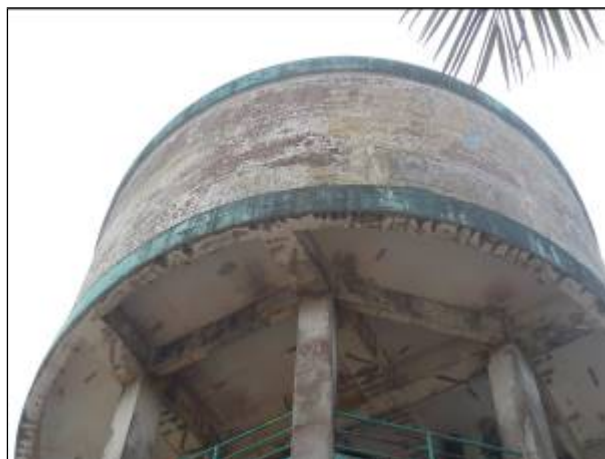
Figura 66: Vista do reservatório R1 necessitando de manutenção e reparos.
