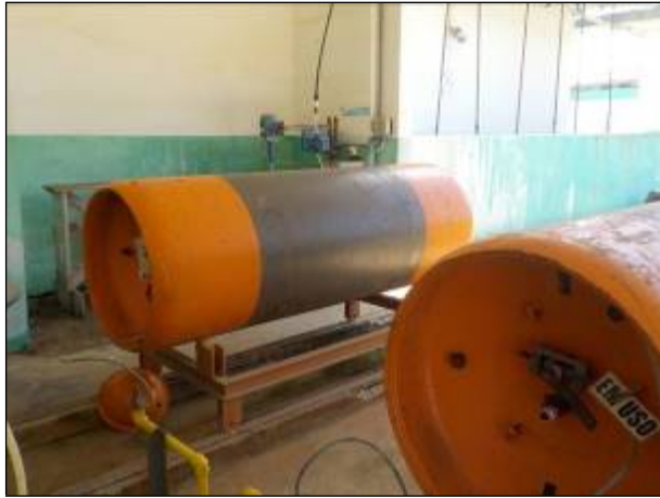
Figura 53: Estrutura montada para a desinfecção da água tratada na ETA Balneário Barra do Sul.
