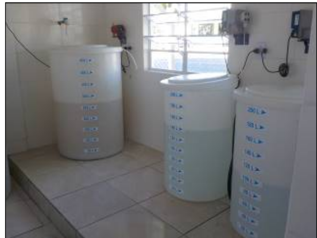
Figura 12: Dosadores e equipamentos para o tratamento da água disponíveis na ETA Central.
