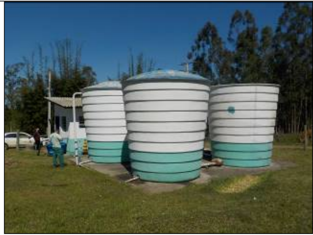
Figura 20: Detalhe dos reservatórios de Vila Santa Catarina, 3x20m 3 , sem placas de identificação.
