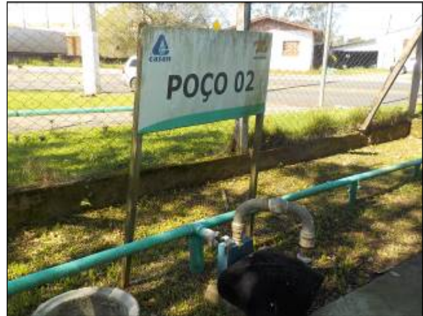
Figura 10: Poço Subterrâneo área Central.
