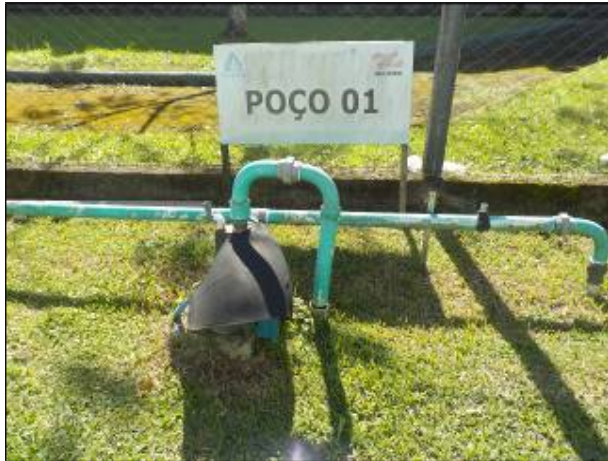
Figura 9: Poço Subterrâneo, localizado na área central.
