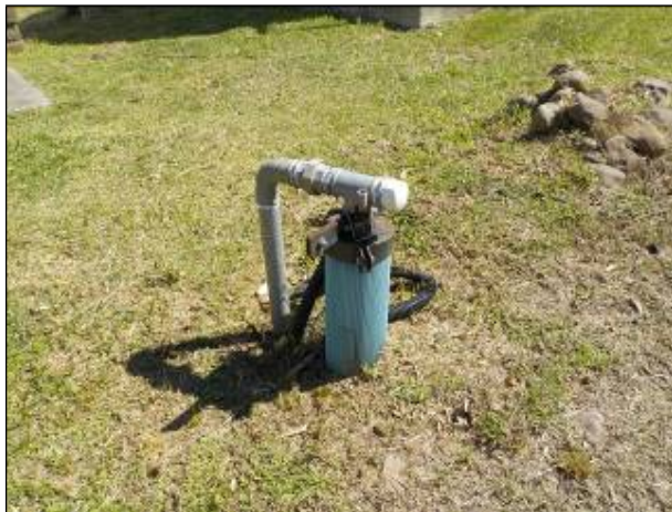
Figura 11: Poço Vila Santa Catarina.
