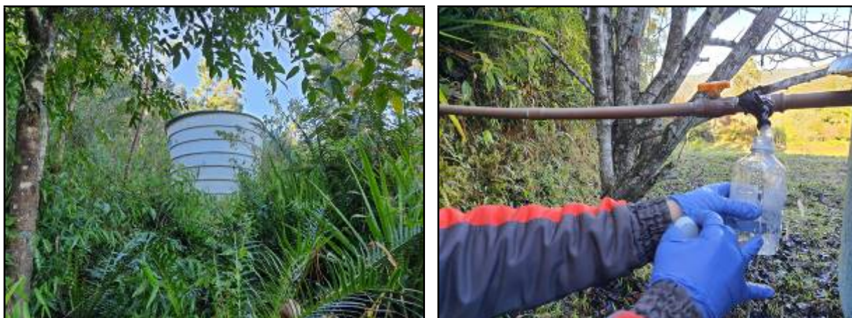
Figura 3 – Vista Geral e coleta de amostras de água tratada no Reservatório Solar das Colinas (28/07/2021).
