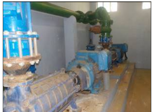
Figura 30: Conjunto motobombas da ERAT Intermediária
