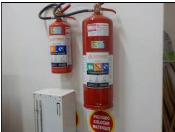
Figura 11: Extintores de incêndio junto ao almoarifado.
