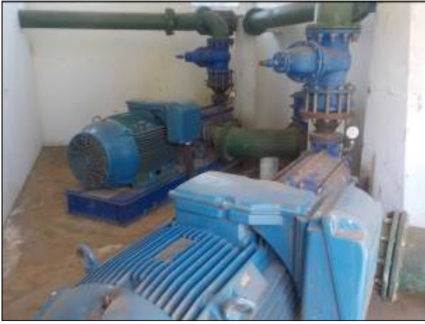
Figura 19: Estação de recalque de água bruta.
