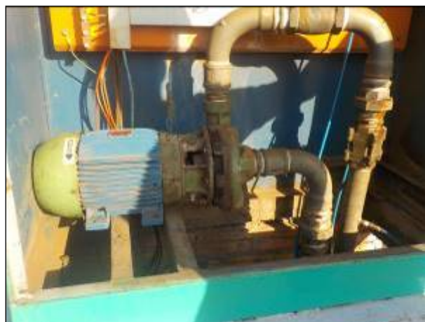
Figura 46; Bomba de recalque do Booster Dom Pedro II.
