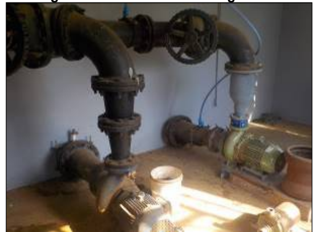
Figura 28: Recalque de Água Tratada junto a ETA (booster Presidente Juscelino).
