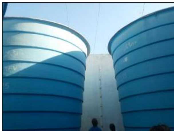
Figura 36: Reservatório R3 com 4 caixas de fibra contendo 25m 3 cada.
