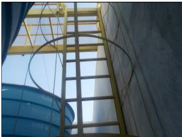
Figura 37: Acesso as caixas de fibra do R3.
