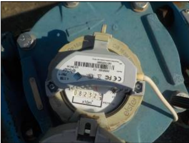
Figura 17: Macromedidor de água bruta do poço 01.
