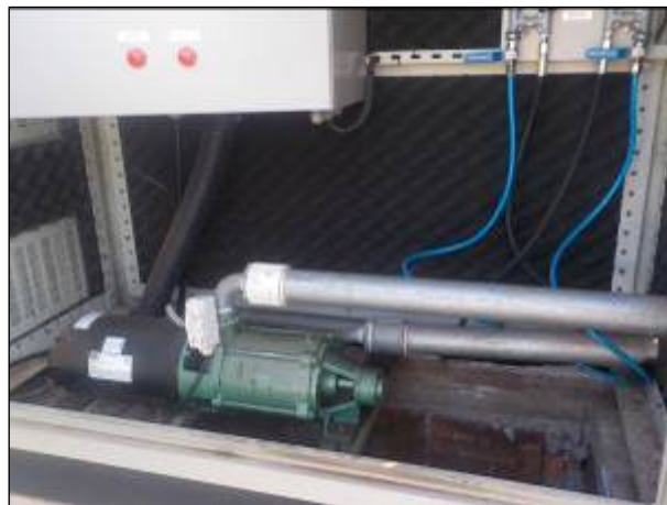
Figura 44: Bomba de recalque do Booster da Rua Aderbal com 3CV
