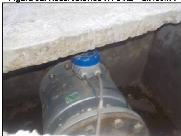
Figura 34: Macromedidor dos Reservatórios R1 e R2.
