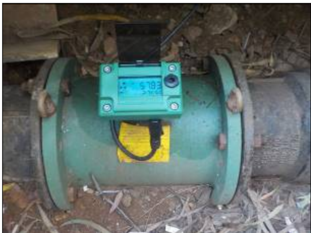
Figura 31: Macromedidor de água tratada eletromagnético da ERAT Intermediária.
