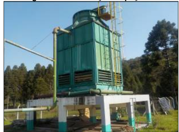
Figura 18: Torre de resfriamento do poço 01.
