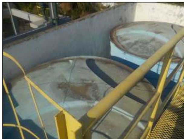
Figura 38: Vista parcial das coberturas das caixas de fibras.
