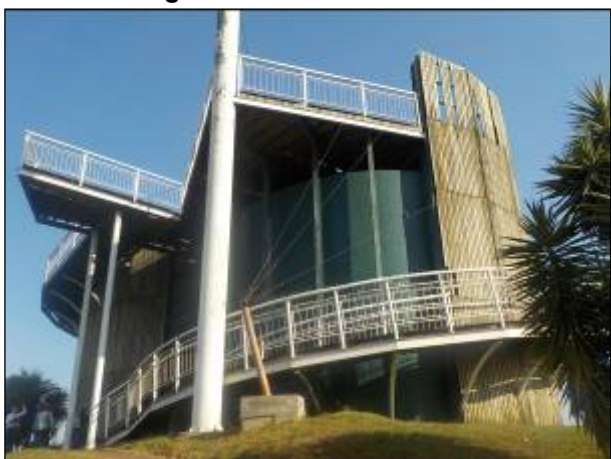
Figura 33: Vista parcial dos Reservatórios R1 e R2 – 2x400m 3 .
