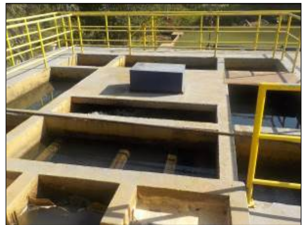
Figura 24: Vista da estrutura da ETA em operação.
