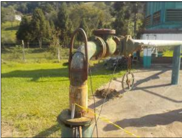
Figura 15: Poço 01 Aquífero Guarani localizado nas dependências da ETA.
