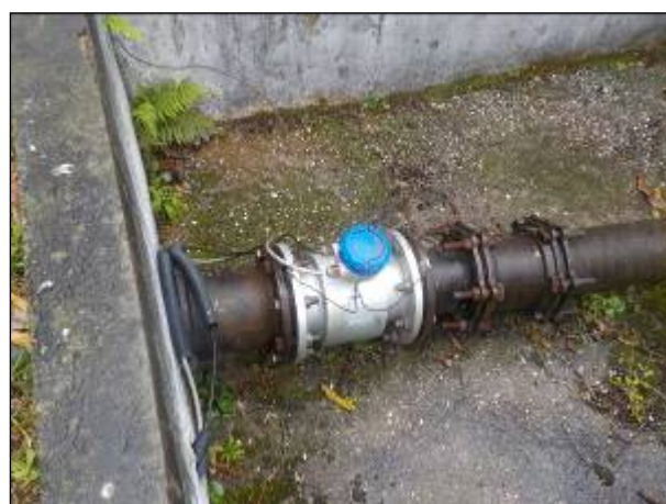
Figura 39: Vista do macromedidor de vazão junto ao Reservatório, em sua saída. Há monitoramento remoto.
