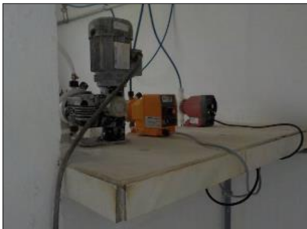
Figura 22: Vista das bombas dosadoras de produtos químicos na ETA Treze de Maio.
