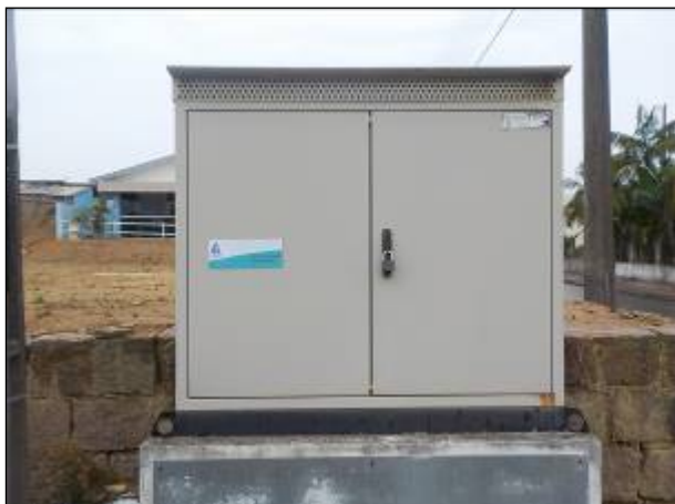
Figura 28: Vista do booster 01 localizado na rua Sete de Setembro, 324.
