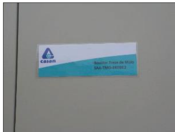
Figura 33: Detalhe da placa indicativa da unidade booster 02, condição satisfatória.
