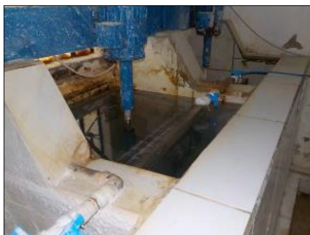
Figura 21: Vista dos equipamentos disponíveis na ETA Treze de Maio para a desinfecção, em funcionamento.
