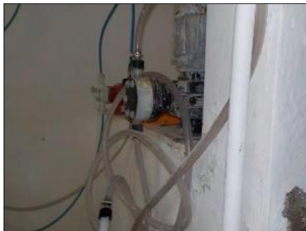
Figura 23: Vista em detalhe das bombas dosadoras de produtos químicos e suas tubulações na ETA Treze de Maio.
