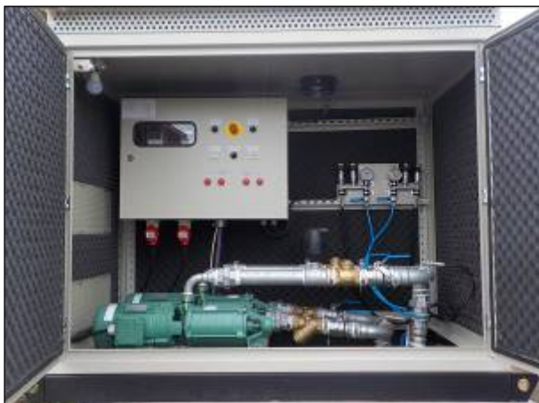
Figura 34: Vista do quadro de comando e da bomba de recalque do booster 02 , boas condições.
