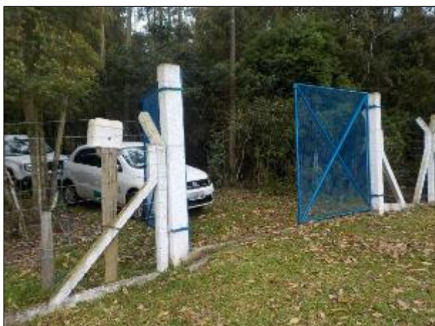
Figura 10: Entrada da Captação subterrânea na Linha Fragnani, portão de acesso e cercamento adequados.
