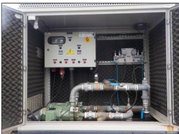
Figura 30: Vista do quadro de comando e do booster 01, boas condições.
