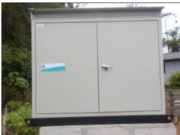
Figura 32: Vista do booster 02, na rua Inácio Nandi, s/n, previsão de início de operação para o mês de novembro de 2022.
