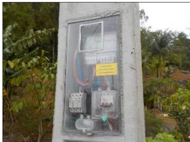
Figura 35: Vista do quadro de energia junto ao booster 02 , boas condições na estrutura, ainda fora de operação no momento da visita.
