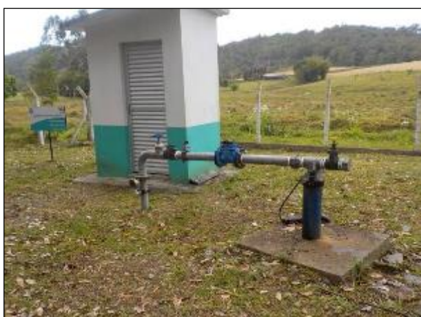
Figura 12: Vista da área de captação, placa indicativa e estrutura que abriga o painel de controle do Poço da Linha Fragnani.
