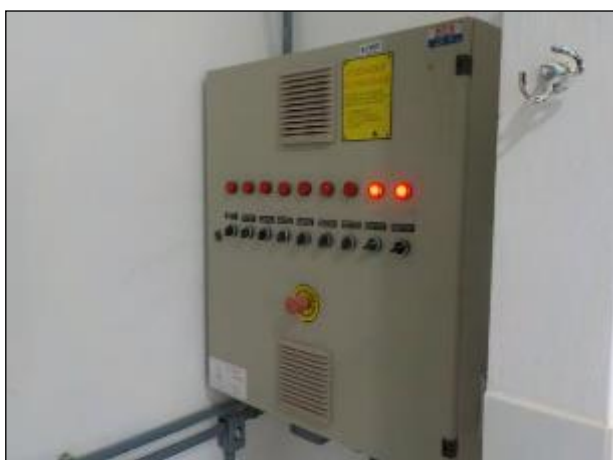
Figura 24: Painel de Controle dos equipamentos utilizados para o tratamento da água bruta, em funcionamento e condições satisfatórias
