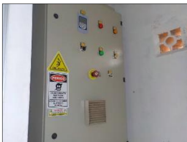
Figura 13: Vista do Painel de Controle de motorbomba que faz o recalque do poço da Linha Fragnani, boas condições.
