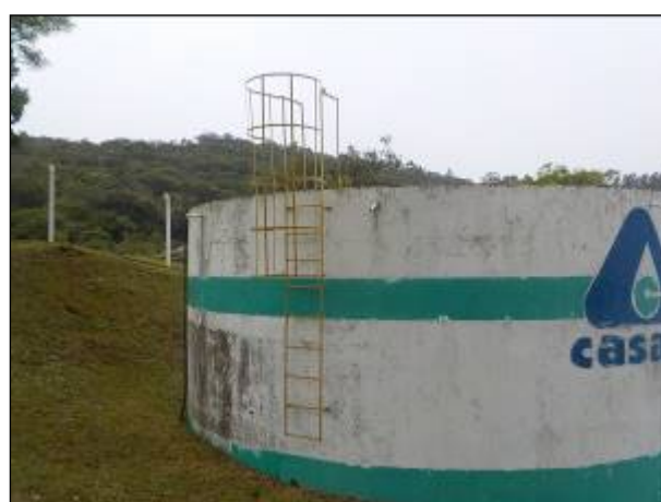
Figura 37: Detalhe da escada de acesso para acesso à parte superior do Reservatório R 01; parte superior sem guarda-corpo.
