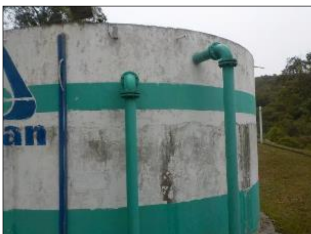
Figura 38: Detalhe do Reservatório R 01 e sua pintura com manchas, possível vazamento.
