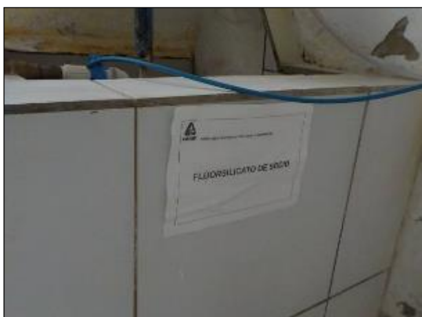
Figura 18: Vista da placa e local onde é misturado o fluorssilicato de sódio, produto utilizado para fluoretação da água bruta.
