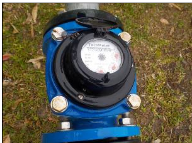
Figura 14: Vista do macromedidor de vazão de saída do Poço Linha Fragnani, em funcionamento.
