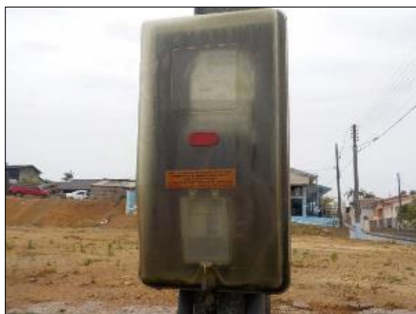
Figura 31: Vista do quadro de energia junto ao booster 01, boas condições na estrutura, porém sem proteção (cadeado).
