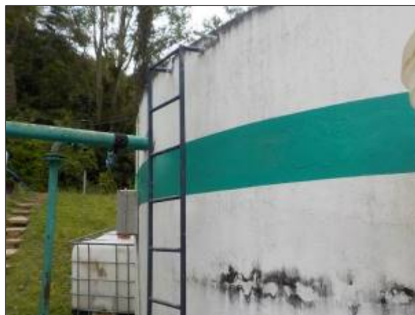
Figura 46: Vista da estrutura em detalhe e das escadas de acesso, estas sem guarda-corpos, inadequada.
