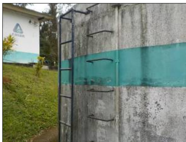
Figura 48: Vista da estrutura em detalhe e das escadas de acesso, estas sem guarda-corpos, inadequada.
