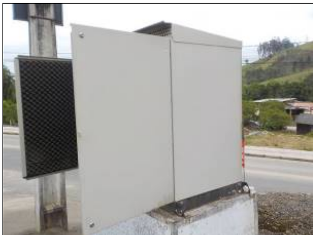
Figura 37: Vista do booster 01, na rua Frederico Wilemann, inexistência de pintura da concessionária e de placas informativas e restritivas, estrutura em boas condições e em local adequado.
