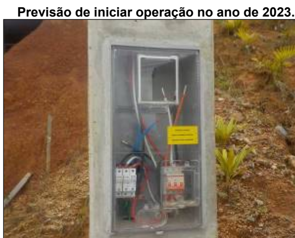
Figura 42: Vista do painel elétrico disponível junto à unidade booster 02, boas condições.
