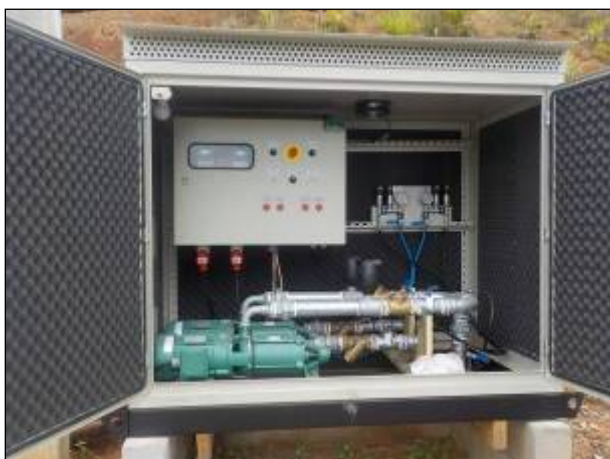
Figura 41: Estrutura interna do booster 01, boas condições dos equipamentos novos, ainda fora de funcionamento e sem instalação de equipamento para monitoramento remoto.
