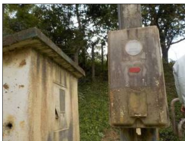
Figura 28: Vista do painel elétrico, necessita manutenção da estrutura frontal e cadeado para segurança da operação.
