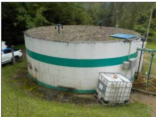
Figura 45: Vista geral do Reservatório R1 (100 m 3 ), boas condições da estrutura, incluindo pintura e parte superior.
