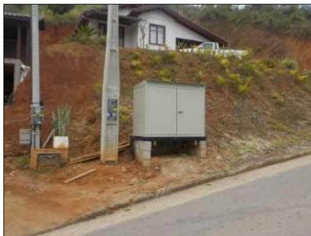
Figura 40: Vista geral do booster 02, localizado na rua Bernardo Tenfen, no momento da visita estava sem placas e pintura adequada, bem como ainda estava fora de operação.
