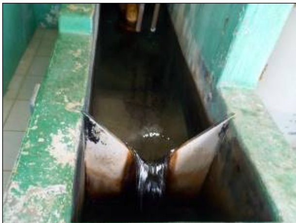
Figura 31: Local de tratamento da água na Casa de Química da ETA Rio Fortuna, satisfatório.
