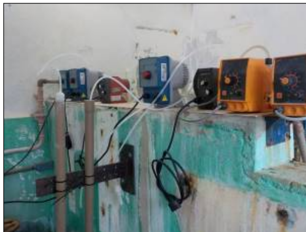
Figura 32: Equipamentos dosadores dos produtos químicos para tratamento na ETA Rio Fortuna; em boas condições, porém em local inadequado.
