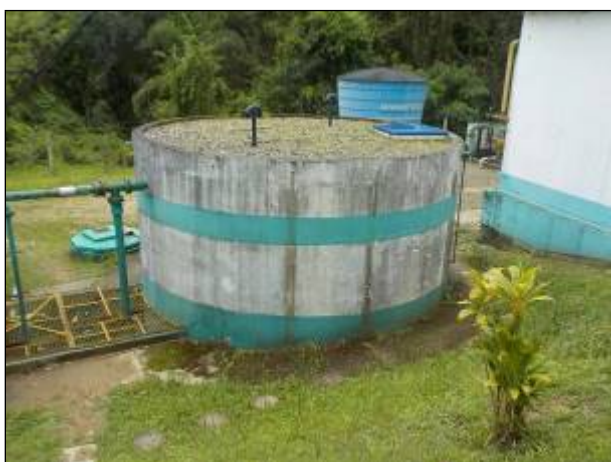
Figura 47: Vista geral do Reservatório R2 (50 m 3 ), estrutura externa em condições insatisfatórias, parte superior em boas condições.
