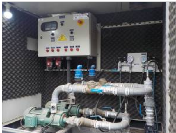
Figura 38: Vista da parte interna do booster 01, equipamentos em boas condições, incluindo supervisão remota.
