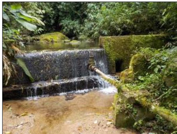
Figura 20: Adutora de água bruta e estrutura da barragem para captação de água bruta superficial no riacho São Bento.
