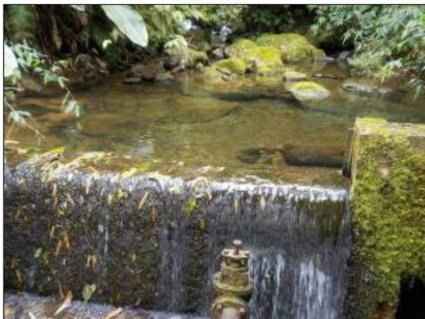
Figura 21: Vista em detalhe da estrutura da barragem e da captação; ponto com área de mata protegida e sem contaminantes conhecidos à montante.
