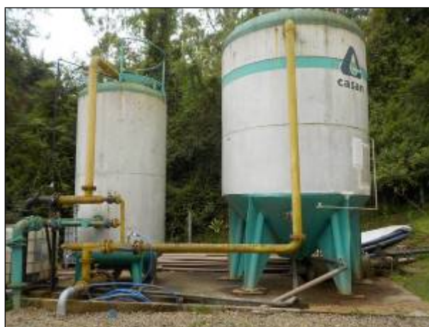
Figura 36: ETA Compacta disponível no local, condições satisfatórias. Há sistema de supervisão na unidade, que funciona 15 horas por dia.
