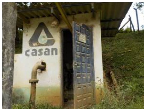
Figura 24: Vista da edificação onde estão as bombas para recalque e o painel de controle. Não há placa informativa e a pintura necessita manutenção.
