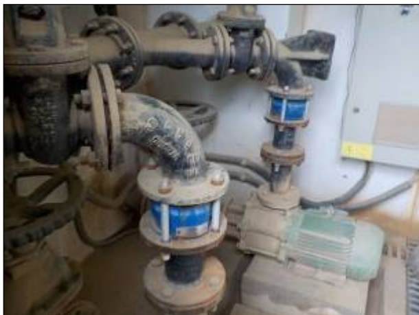
Figura 25: Local onde estão as bombas, há uma reserva, boas condições, embora o trânsito da rodovia deixe o local empoeirado.
