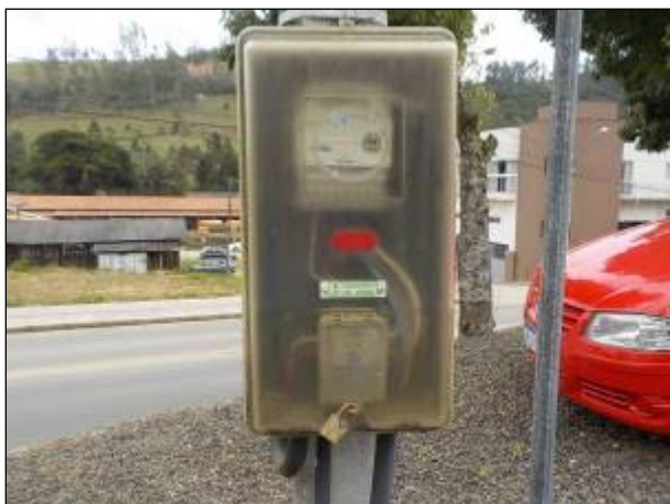
Figura 39: Vista do painel elétrico disponível junto à unidade booster 01, boas condições.
