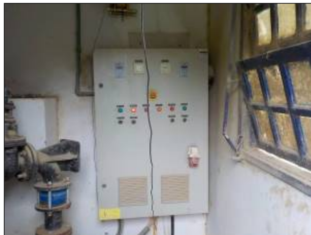
Figura 26: Vista do Painel de Controle da unidade ERAB 01, boas condições, em funcionamento e com sistema de supervisão remota adequado.
