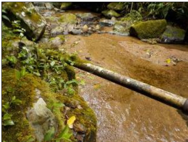
Figura 19: Vista da tubulação instalada para a adução da água bruta na captação riacho São Marcos.
