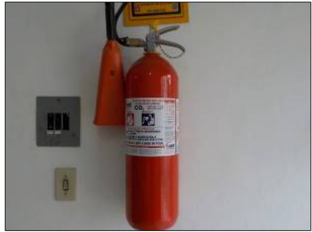
Figura 6: Vista do equipamento extintor de incêndio disponível no Escritório.
