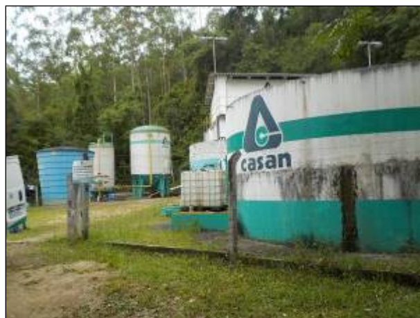
Figura 44: Vista do local onde estão os reservatórios R1 e R2, na ETA Rio Fortuna.
