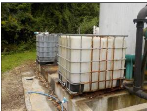
Figura 35: Equipamentos dispostos no pátio da ETA Rio Fortuna.
