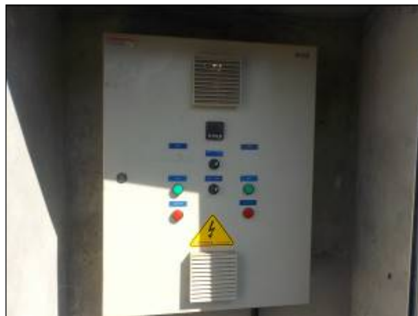
Figura 81: Vista do quadro de comando da EEE Parque das Araucárias, estrutura adequada.
