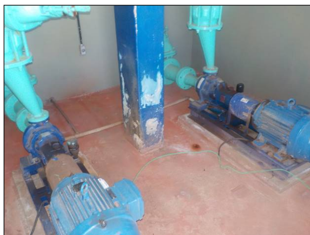
Figura 42: Vista dos motores para recalque da água tratada na ERAT da Raia, uma delas é reserva, a outra funcionando e em boas condições.
