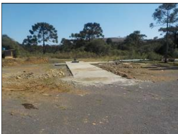
Figura 13: Vista do Poço da Prefeitura, fora de operação no momento da visita, aguardando instalação elétrica e motorbomba para até início de 2023. Obras civis, reservatório e entrono, previstas para final do ano 2023.
