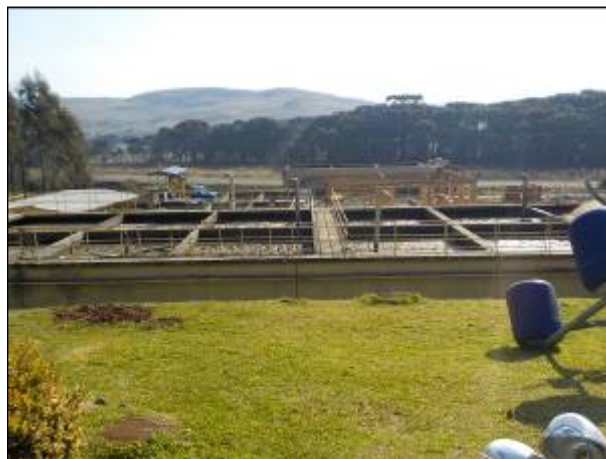
Figura 63: Vista do Tanque de Aeração em funcionamento.
