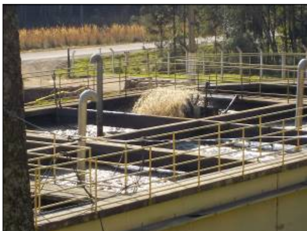
Figura 64: Equipamento aerador, em funcionamento da ETE de São Joaquim.
