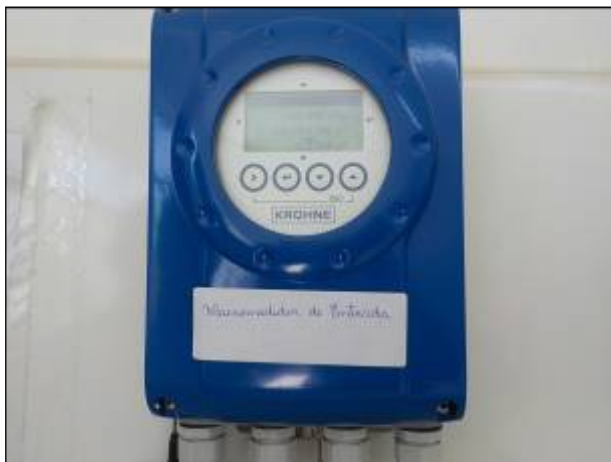
Figura 21: Detalhe do medidor de vazão de entrada localizado na ETA.
