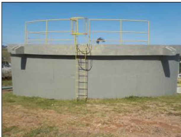
Figura 27: Escada de acesso dos operadores a parte superior dos Reservatórios.
