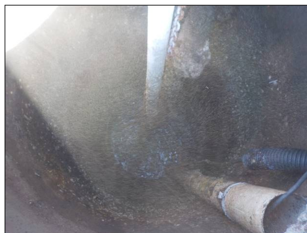
Figura 73: Vista do poço de sucção da elevatória de esgoto EEE B1.
