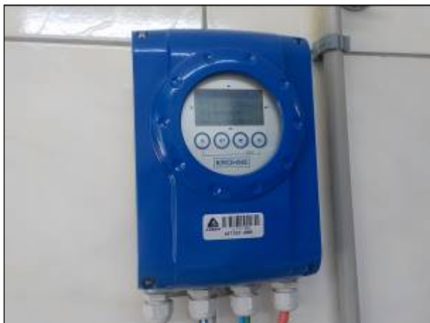
Figura 68: Macromedidor de vazão disponível na ETE de São Joaquim.
