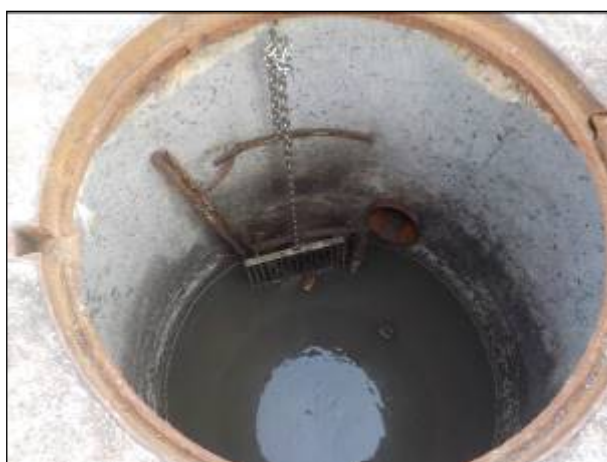
Figura 82: Vista do poço de sucção da EEE Parque das Araucárias, destaque para o gradeamento disponível e adequado.
