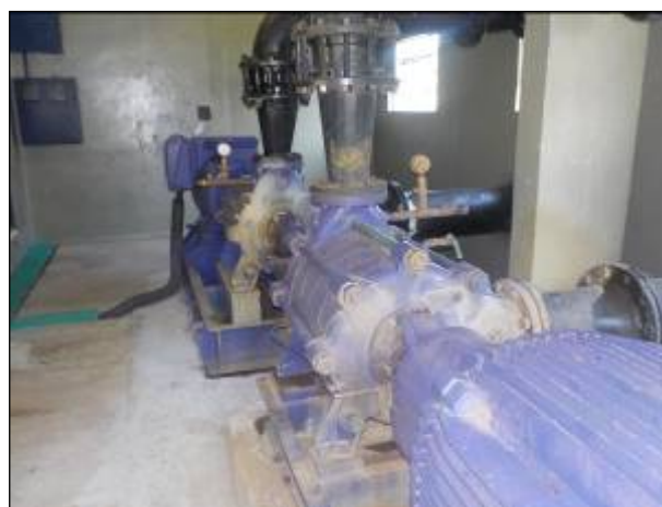
Figura 12: Vista interna das bombas que recalcam a água bruta do Rio Antonina, boa condição e em funcionamento.
