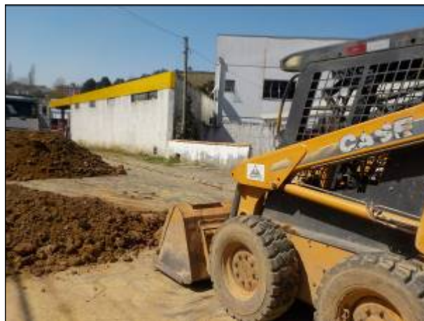
Figura 44: Maquinário auxiliando o trabalho de substituição das tubulações da rede de água na área central da cidade de São Joaquim.
