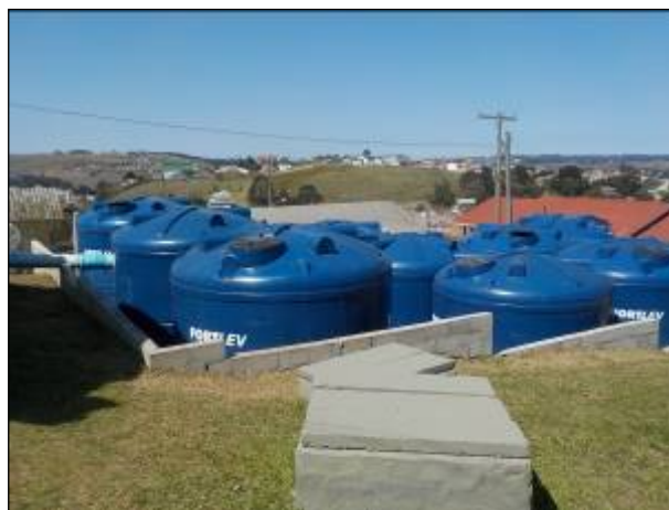
Figura 30: Vista dos Tanques de Recirculação da água tratada para entrada da ETA, boas condições.
