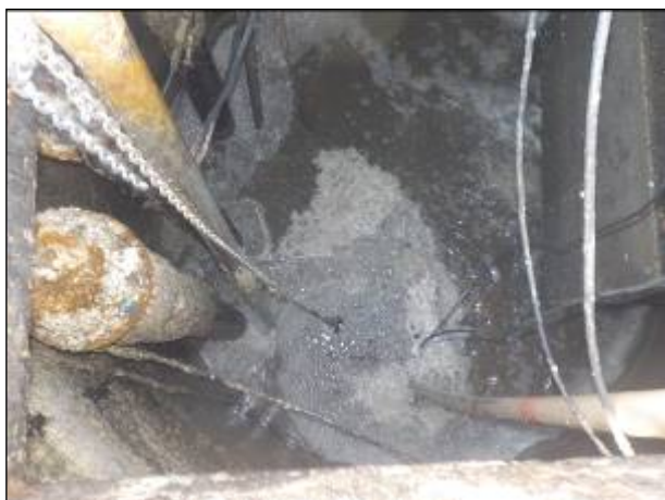
Figura 76: Vista do poço de sucção da elevatória de esgoto EEE G1, boas condições.
