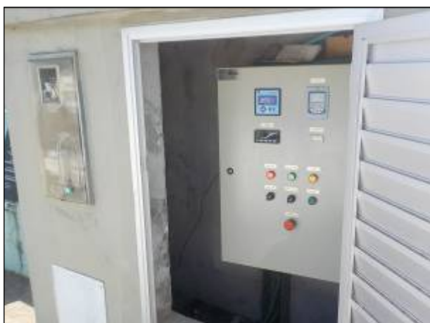
Figura 72: Vista da estrutura que comporta o Quadro de Comando na EEE B, instalação adequada.
