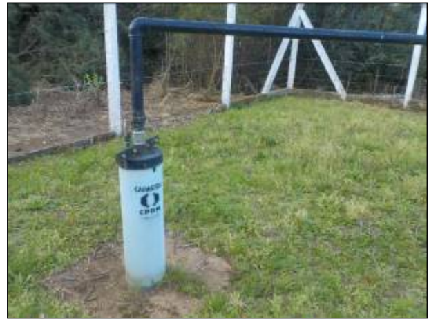
Figura 46: Vista da captação subterrânea, denominada poço Santa Isabel, cercada e identificada adequadamente.
