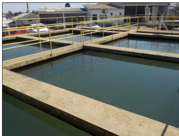
Figura 18: Vista da estrutura em operação da ETA em São Joaquim.
