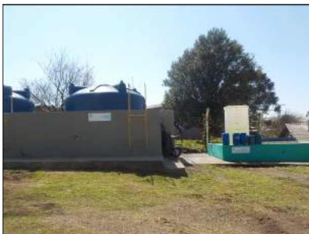
Figura 29: Tanque contendo o Ácido Fluossilícico e Sulfato de Alumínio utilizados nos processos de fluoretação e coagulação.
