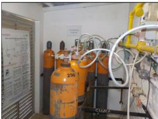
Figura 23: Detalhe dos cilindros de cloro e os dosadores para o tratamento água na ETA.
