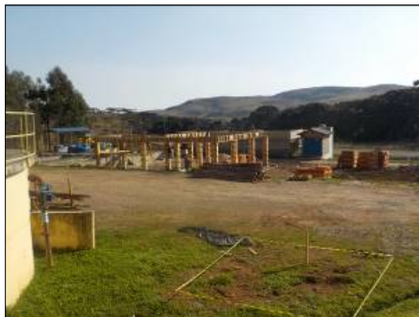
Figura 69: Vista geral das obras de ampliação sendo realizadas na ETE de São Joaquim.
