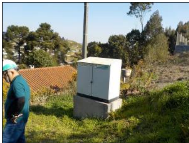
Figura 40: Vista do Booster Parque das Araucárias , identificado, porém sem cercamento para melhor proteção dos equipamentos
