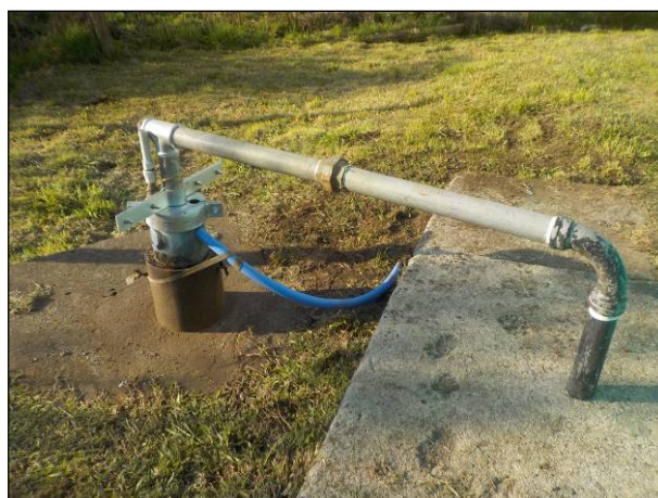
Figura 54: Vista do poço no Distrito de Boava, boas condições. No momento da visita sendo consertado por estar inoperante.
