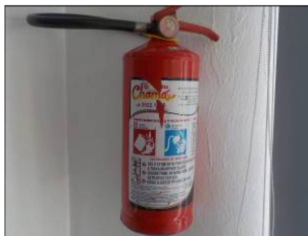
Figura 6: Cilindro contendo pó químico extintor de incêndio em boas condições de uso (pressão, lacre e casco).
