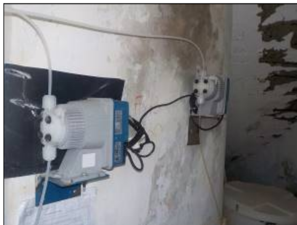
Figura 52: Detalhe dos dosadores de cloro e flúor no tratamento do Reservatório Santa Isabel.
