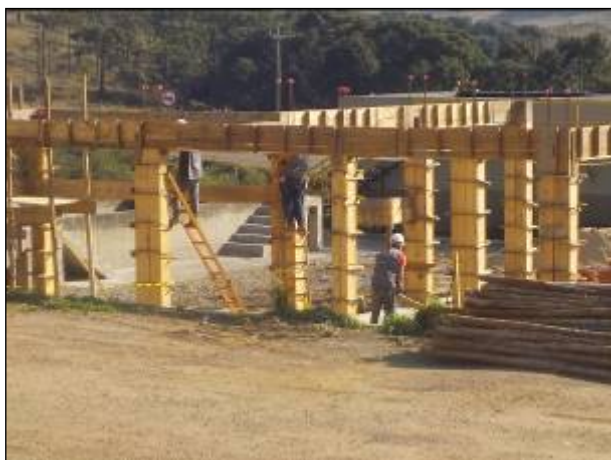
Figura 70: Detalhe da nova estrutura em construção da ETE, previsão de conclusão para o ano de 2023.
