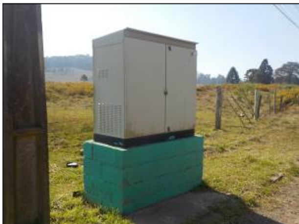
Figura 39: Vista do Booster Bairro Recanto , sem placas de identificação e sem proteção adequada.
