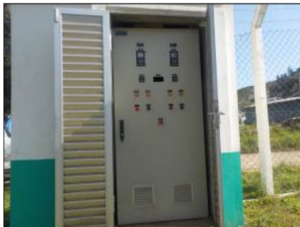
Figura 75: Quadro de comando da EEE G1 na Avenida Beira Rio, boas condições.
