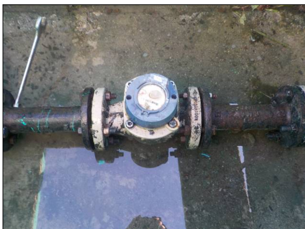
Figura 55: Medidor de vazão disponível na captação, soma-se a este o acompanhamento online, denominado telemetria.
