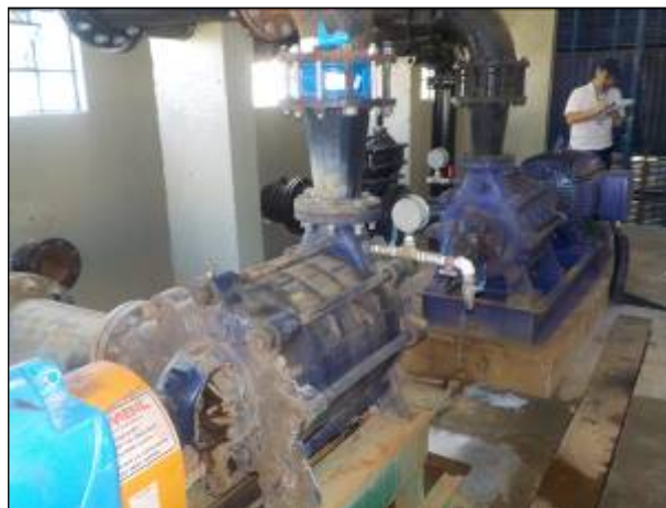
Figura 16: Vista em detalhe da estrutura de Captação de Água Bruta – ERAB II.
