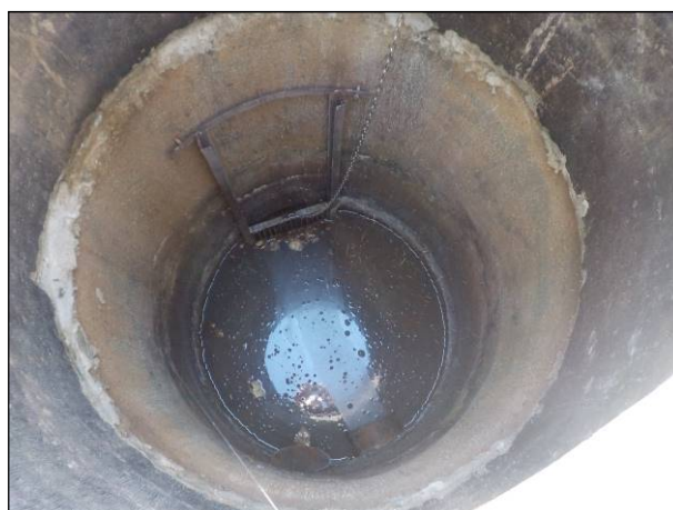
Figura 79: Vista do poço de sucção da EEE Jardim das Hortências, boas condições do gradeamento.
