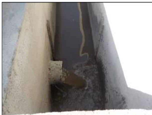
Figura 65: Chegada do esgoto bruto na ETE de São Joaquim no momento da visita técnica de fiscalização.
