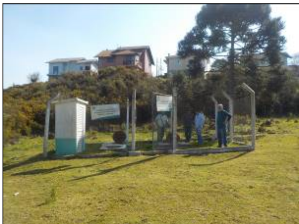
Figura 80: Vista geral do local onde está inserida a EEE Parque das Araucárias, local cercado e identificado adequadamente.
