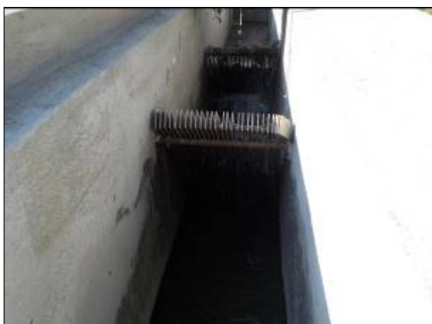
Figura 66: Sistema de gradeamento da chegada do esgoto bruto na ETE de São Joaquim
