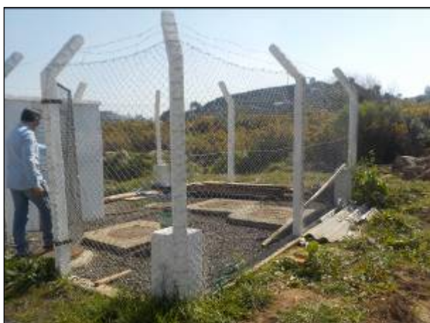
Figura 78: Vista geral da estrutura disponível na EEE Parque das Hortências, cercamento e estrutura adequados.
