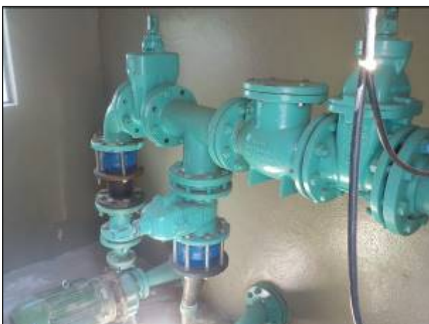
Figura 35: Vista da parte interna da Estação de Recalque ERAT CTG.
