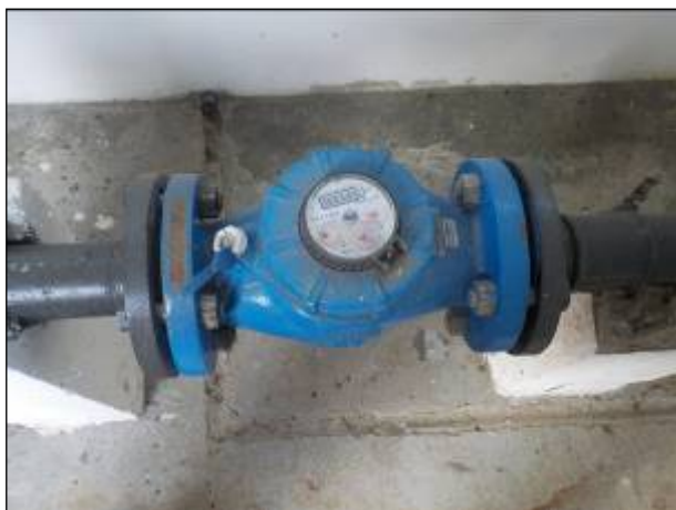
Figura 47: Macro medidor disponível no Poço Santa Isabel.
