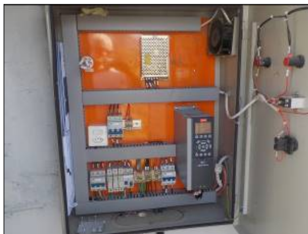
Figura 77: Detalhe do Quadro de comando da EEE Jardim das Hortências, condições satisfatórias.
