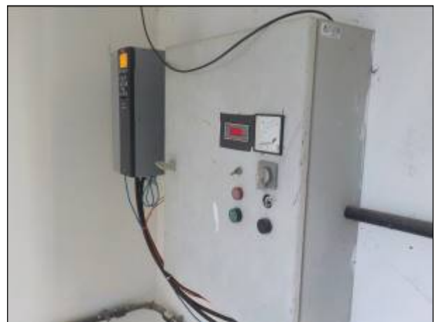
Figura 48: Vista interna do quadro de comando do poço Santa Isabel.
