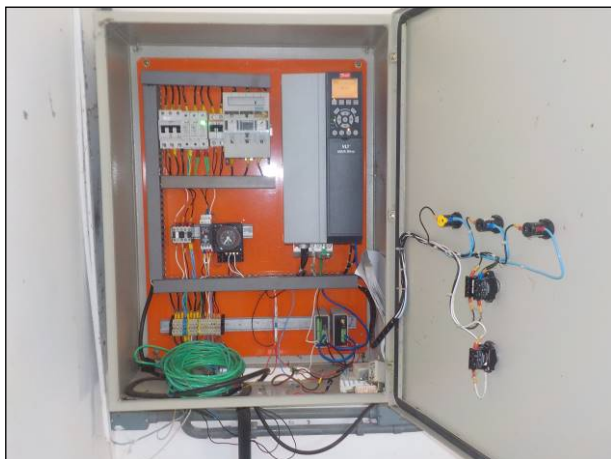
Figura 57: Painel de Controle do Poço Boava, boas condições para operação.
