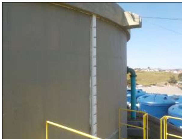
Figura 28: Régua de nível de controle disponível nos reservatórios R3 e R4.
