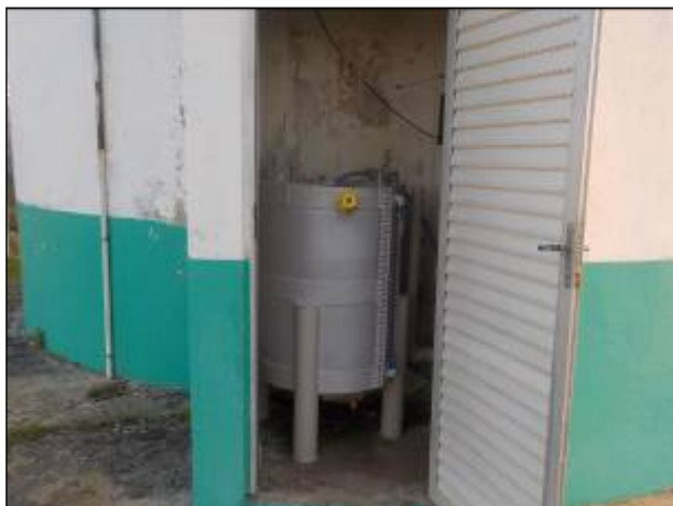
Figura 51: Sistema de cloro e flúor utilizado no tratamento dentro do Reservatório Santa Isabel.
