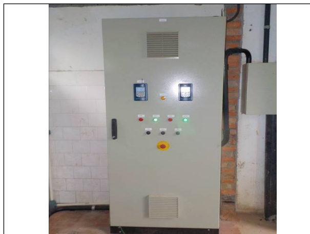
Figura 20: Vista externa do Painel de Controle da unidade.
