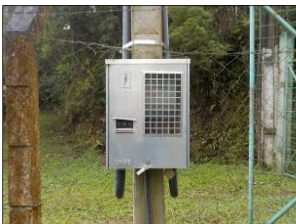
Figura 23: Vista do painel elétrico disponível para a ERAB 01, boas condições.
