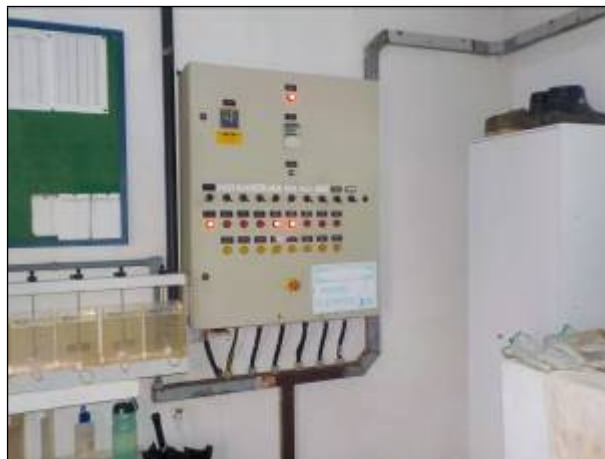
Figura 44: Painel de Controle da ETA Rio do Oeste.
