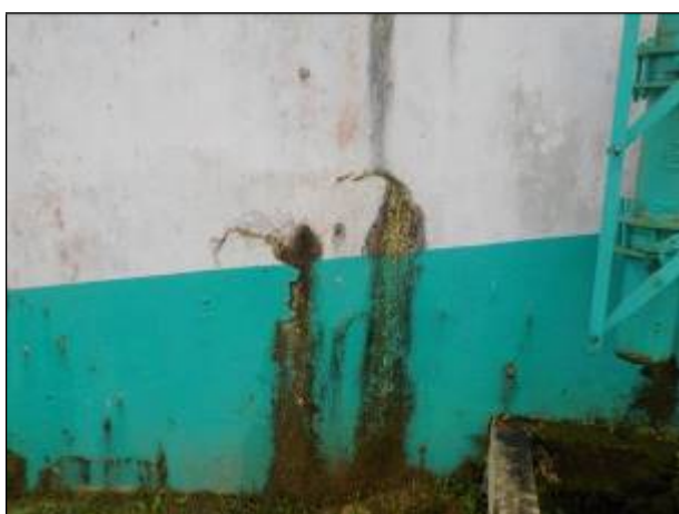
Figura 35: Estrutura da ETA e Reservatórios comprometida devido a uma possível má conservação.
