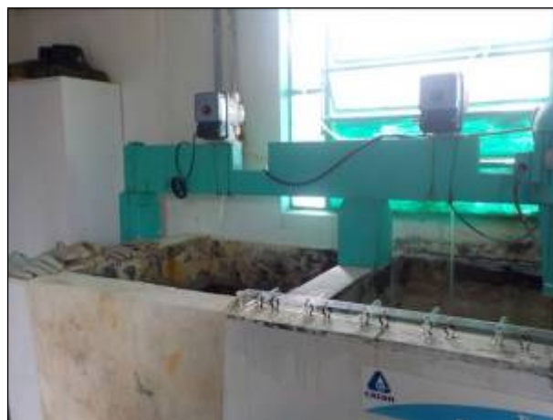
Figura 40: Vista do equipamento para mistura de produtos químicos, estrutura precária com dosadores em boas condições.
