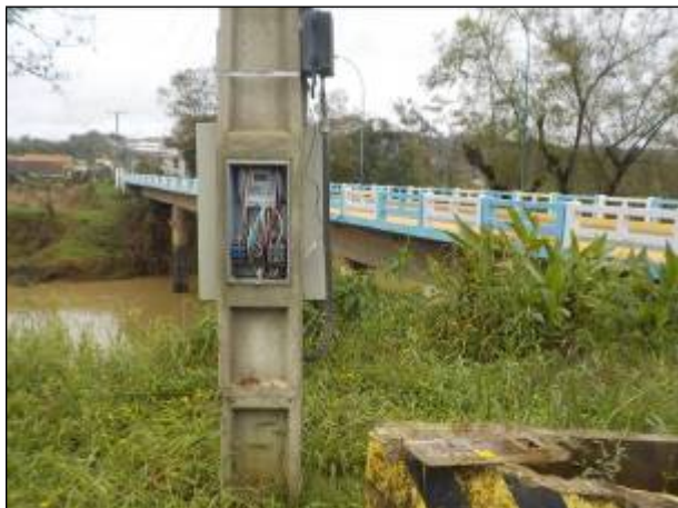
Figura 25: Vista do local e painel elétrico onde está situada a Captação no Rio Itajaí do Oeste e a ERAB 02.
