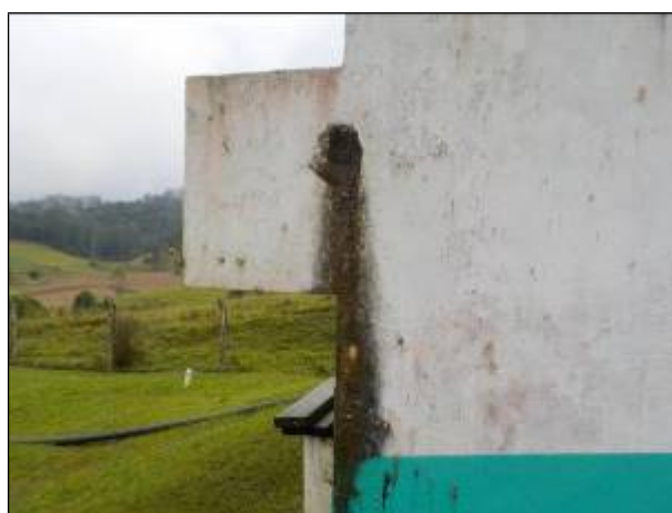
Figura 36: Estrutura da ETA, externamente, com musgo e possibilidade de infiltração, possivelmente.
