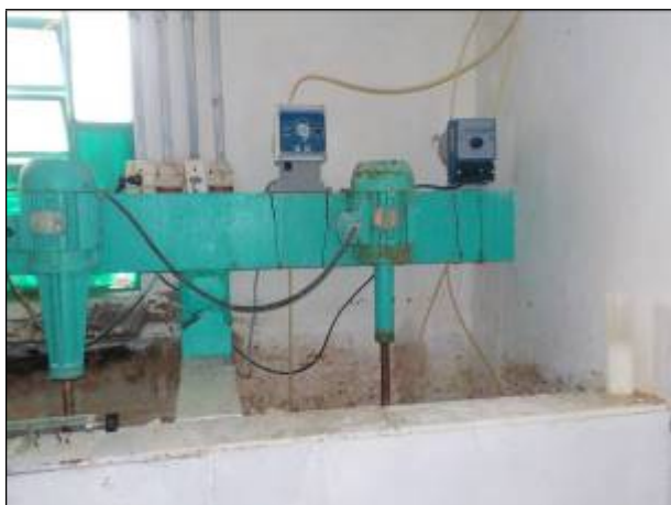
Figura 41: Vista da estrutura para dosagem e mistura dos produtos químicos utilizados no tratamento.
