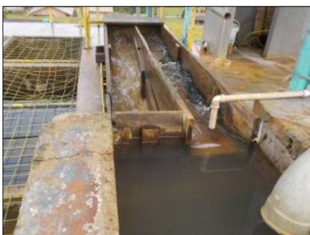
Figura 33: Vista do início do tratamento da ETA Rio do Oeste, entrada de água bruta.
