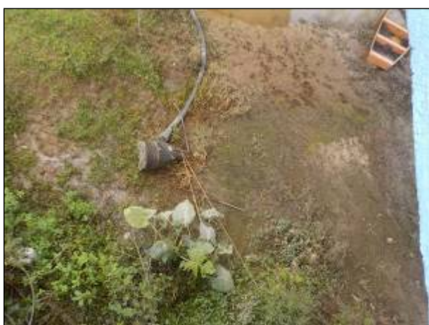
Figura 27: Vista da bomba de captação no Rio do Oeste, como é uma reserva (auxiliar) da captação principal, não estava em funcionamento.
