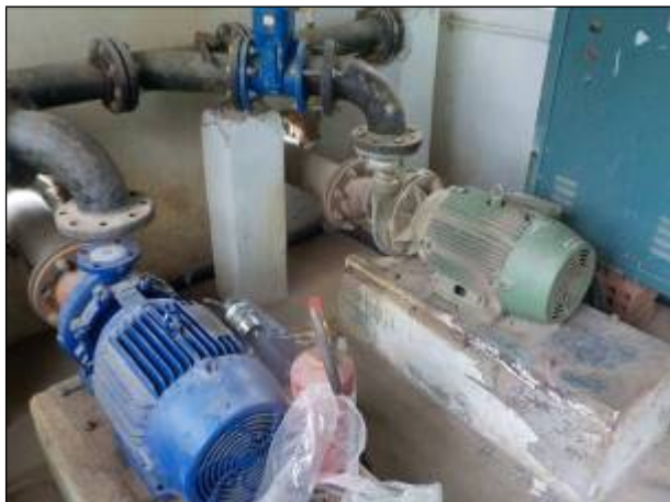
Figura 19: Vista da parte interna da Estação de Recalque de Água Bruta com seus motores de 30 CV.
