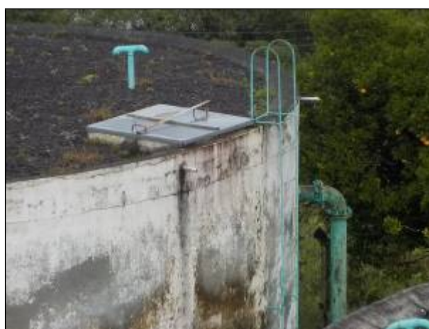
Figura 52: Escada de acesso superior e tampa de acesso ao interior do Reservatório R1 estão sem os guardas-corpos necessários para proteção do operador.
