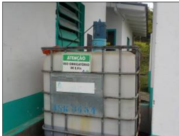
Figura 38: Armazenamento de produtos químicos, flúor, em local externo.
