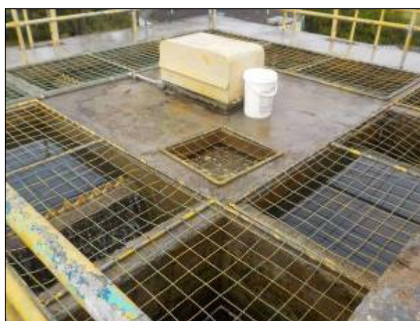
Figura 34: Vista dos decantadores na ETA Rio do Oeste, necessário manutenção da estrutura.
