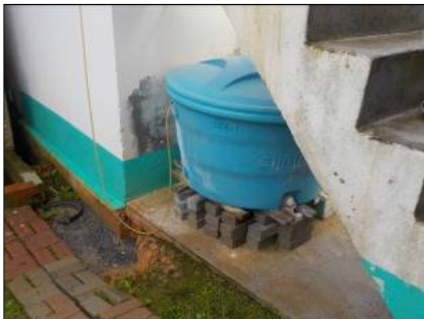
Figura 37: Equipamento provisório instalado para o tratamento na ETA.
