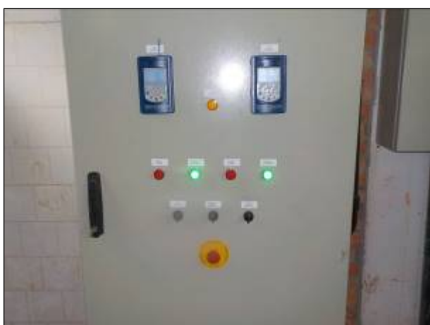
Figura 21: Vista em detalhe do Painel de Controle.
