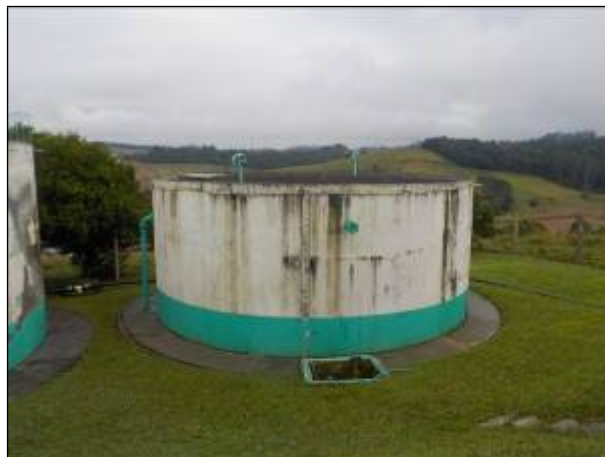
Figura 50: Vista da estrutura do Reservatório R1, estrutura lateral visualmente malconservada, necessário estudo para verificar melhorias.
