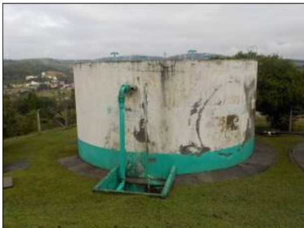
Figura 49: Vista da estrutura do Reservatório R1, estrutura lateral visualmente malconservada, necessário estudo para verificar melhorias.
