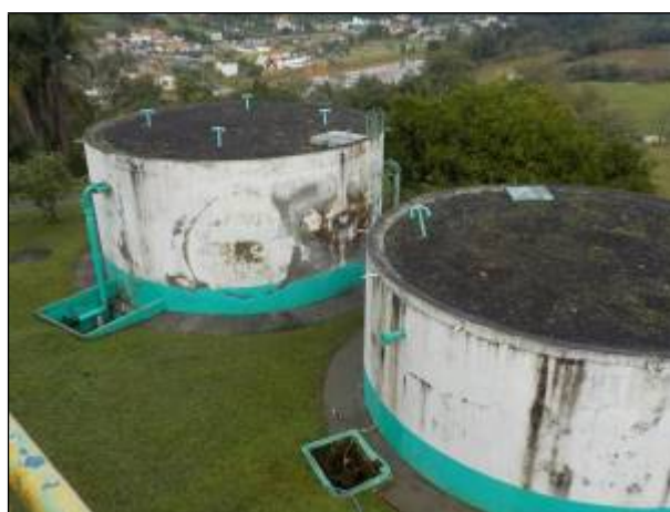
Figura 48: Vista da área superior dos reservatórios R1 e R2, boas condições, capacidade para armazenar 125 m 3 cada.
