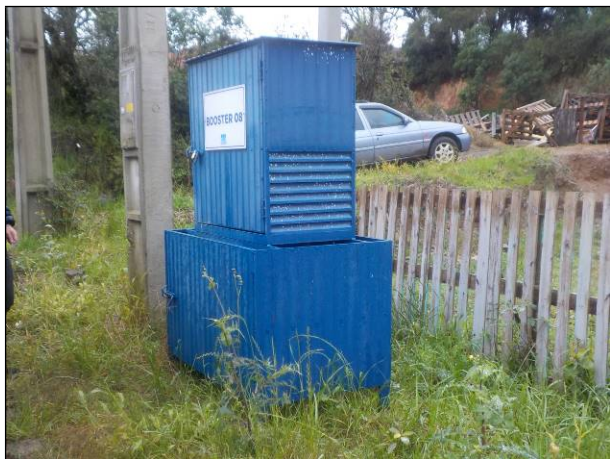
Figura 75: Vista da estrutura do booster 08, situado na rua Jair Damaso da Silveira, boas condições da estrutura e entorno.
