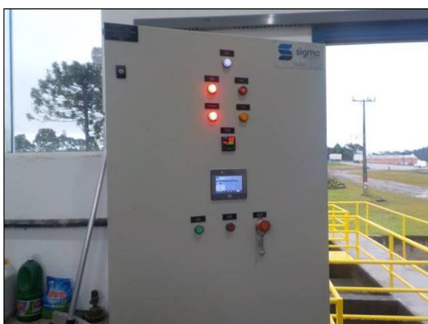
Figura 35: Painel de controle das unidades, boas condições e em funcionamento.
