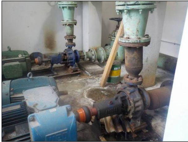
Figura 45: Vista da ERAT ETA, em funcionamento.
