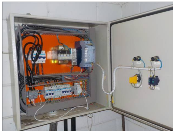
Figura 52: Vista do Painel de Controle na unidade, equipamentos em boas condições.
