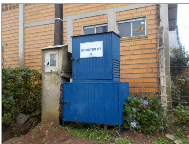
Figura 71: Vista da estrutura do booster 07, localizado na Estrada São Tomaz, condições satisfatórias da estrutura, pintura e placa.
