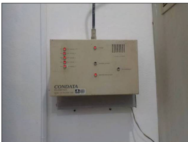
Figura 37: Sistema de monitoramento remoto da unidade, conexão com os demais sistemas e com o Escritório, em funcionamento.
