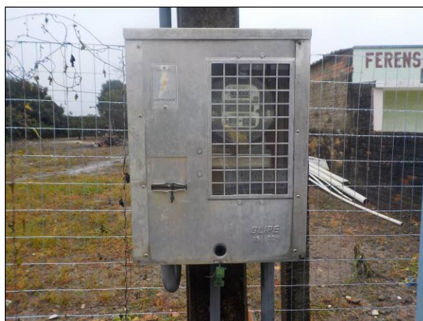
Figura 62: Vista do painel elétrico junto ao booster 03, sem cadeado e em boas condições.
