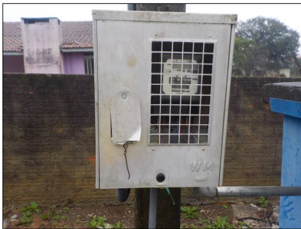
Figura 65: Painel elétrico disposto junto ao booster 04, condições insatisfatórias de segurança.
