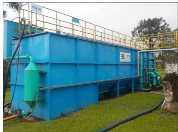
Figura 32: Vista geral da ETA 2, auxiliar à ETA 1, boas condições para operação.
