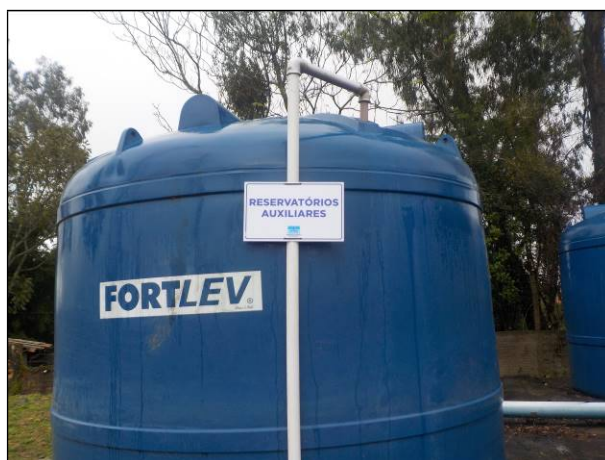
Figura 90: Vista da placa indicativa da unidade e detalhe de um dos reservatórios de 20 m 3 .
