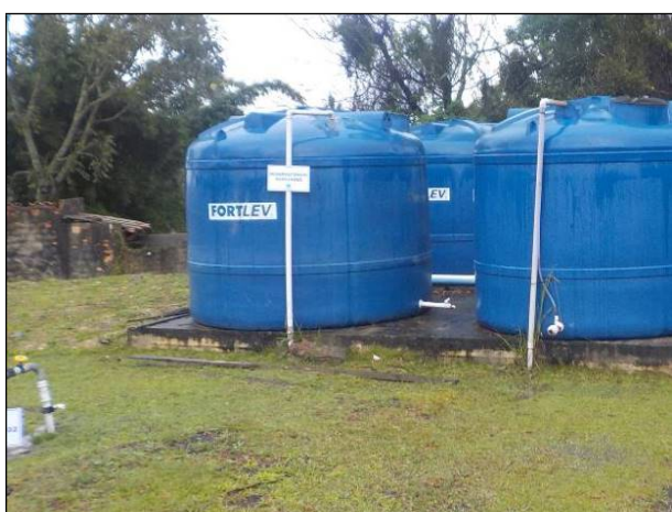
Figura 11: Vista do entorno do Poço 02 junto aos reservatórios auxiliares, em local cercado e identificado, porém a unidade está desprotegida em seu entorno próximo e sem sinalização para veículos.
