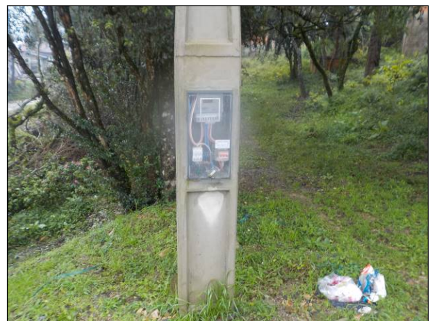
Figura 68: Vista do painel elétrico na unidade booster 05, boas condições.
