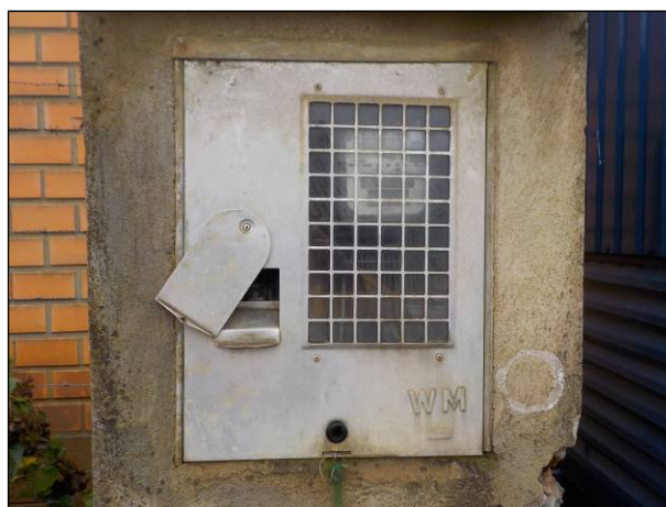
Figura 74: Painel elétrico disposto junto ao booster 07, sem cadeado.
