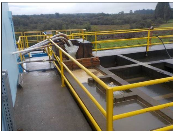
Figura 29: Vista da parte principal da ETA, denominada ETA 1, boas condições de segurança e funcionamento.
