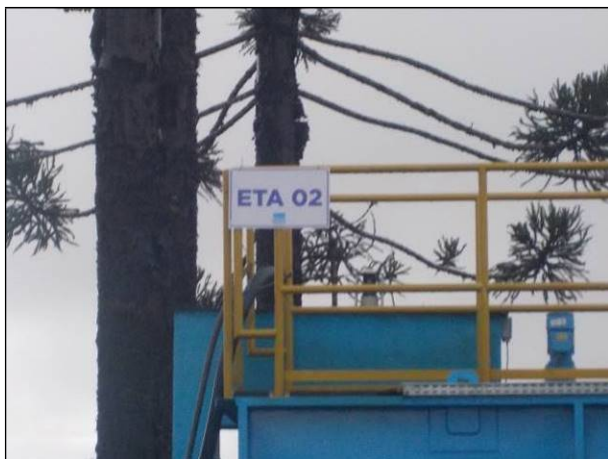
Figura 31: Vista de placa informativa da unidade auxiliar denominada ETA 2, localizada junto à ETA 1
