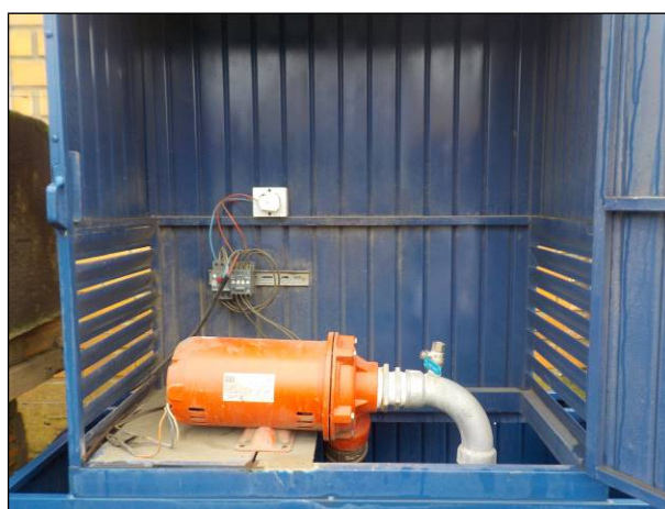
Figura 72: Vista do motorbomba, condições satisfatórias.
