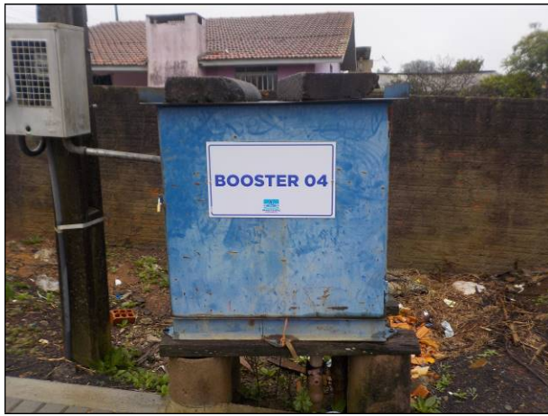
Figura 63: Vista do booster 04, condições insatisfatórias para proteção dos equipamentos e pintura, placa informativa em boas condições.
