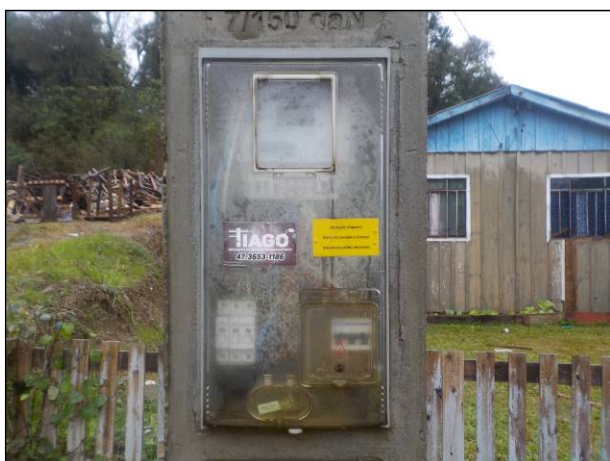
Figura 79: Painel elétrico junto ao booster 08, sem cadeado de proteção.
