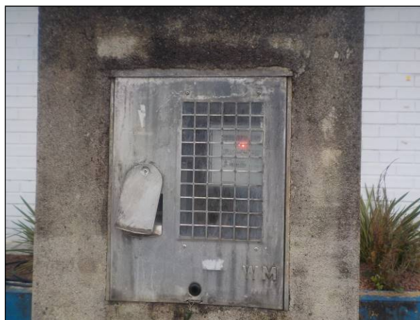
Figura 56: Vista do painel elétrico disponível na unidade booster 01.
