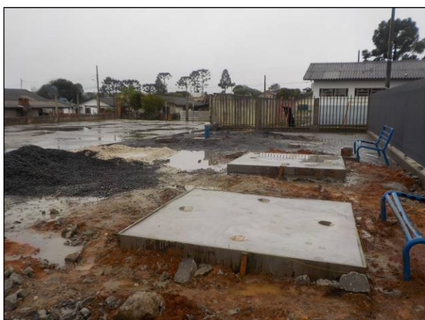
Figura 91: Obras civis em andamento na região denominada COHAB I, neste local estão disponíveis além de um Poço de captação de água bruta, mais dois reservatórios de 20 m 3 cada.
