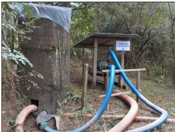
Figura 21: Equipamentos disponíveis para captação e adução da água no ponto de captação no rio São João, dia 14/06/2022. Placa indicativa adequada.
