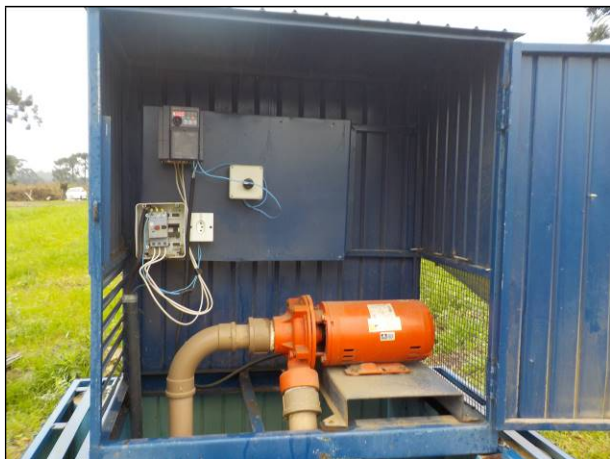
Figura 81: Vista interna do booster 09, boas condições de seus equipamentos.
