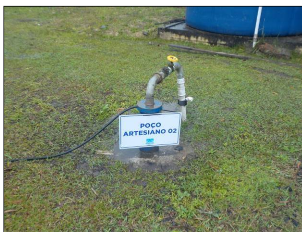
Figura 12: Vista em detalhe do Poço 02, placa indicativa da unidade em conformidade e em funcionamento.
