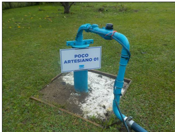
Figura 10: Vista do equipamento em detalhe, boas condições de funcionamento e placa indicativa adequada.
