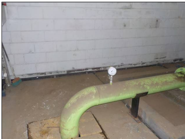
Figura 51: Vista interna da ERAT Motor Intermediário, condições satisfatórias.
