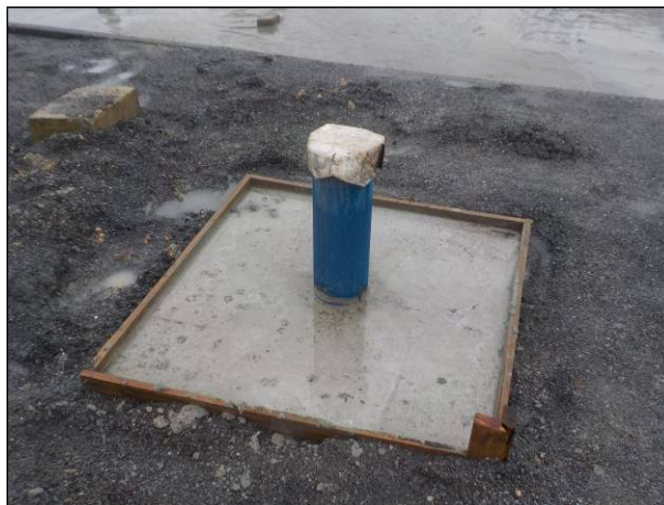
Figura 93: Vista em detalhe do ponto onde está a perfuração do Poço na COHAB I, obras em andamento na auditoria de fiscalização realizada em junho de 2022.
