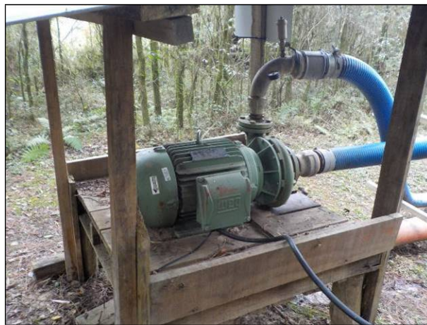
Figura 22: Detalhe do motorbomba utilizado na captação 01, condições satisfatórias de limpeza e proteção contra intempéries moderadas.
