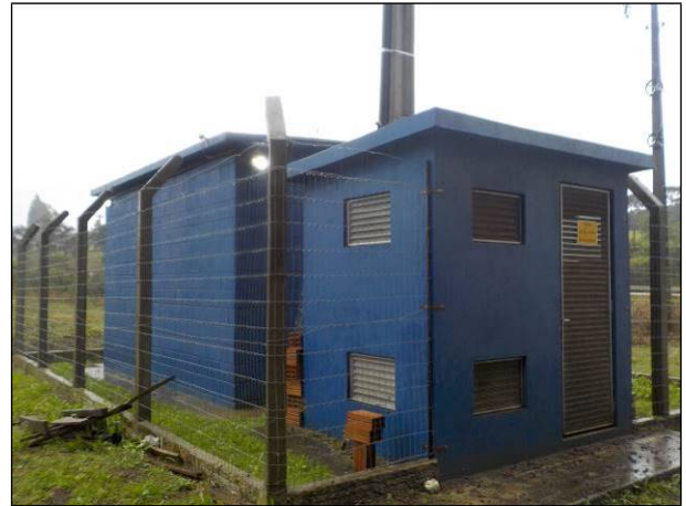
Figura 48: Vista da parte externa e cercamento da ERAT Motor Intermediário, boas condições.
