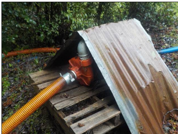
Figura 15: Local onde estão os equipamentos de adução da água bruta no rio São Pedro para o tratamento na ETA.
