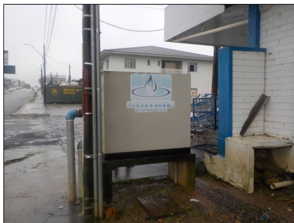
Figura 54: Vista externa traseira do booster 01, identificada e protegida.
