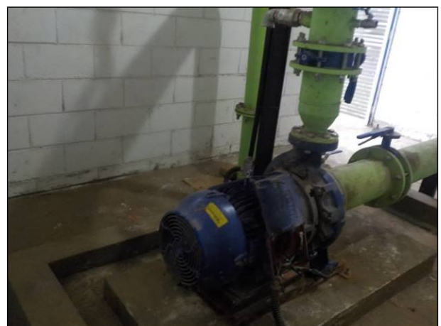
Figura 50: Vista interna da ERAT Motor Intermediário, condições satisfatórias.
