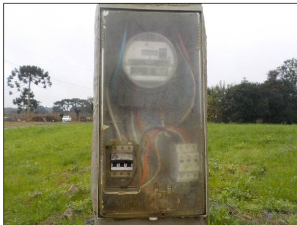
Figura 82: Vista do painel elétrico, condições insatisfatórias de proteção.
