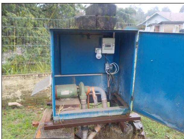
Figura 59: Vista interna do motorbomba disponível no booster 02, condições satisfatórias.
