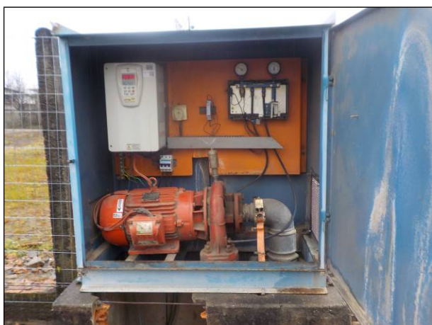
Figura 61: Vista interna do booster 03, motorbomba e demais equipamentos em boas condições e em funcionamento.
