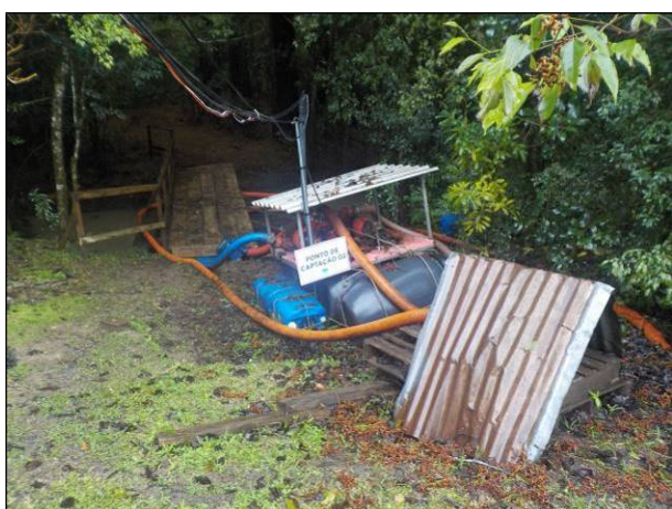
Figura 13: Local onde estão os equipamentos para captura e adução da água bruta captada no rio São Pedro.
