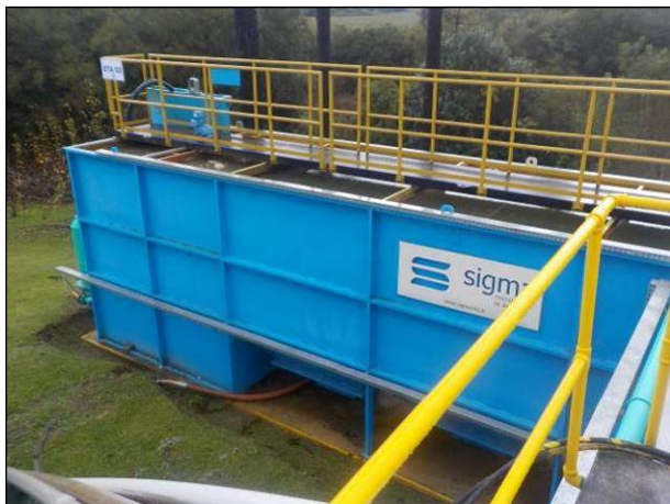
Figura 33: ETA auxiliar vista a partir da ETA 1, boas condições de operação e segurança, incluindo guarda-corpos.
