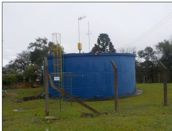
Figura 84: Vista do reservatório principal, capacidade de reserva de 300 m 3 , e seu entorno e cercamento em boas condições, este localizado na rua das Torres.
