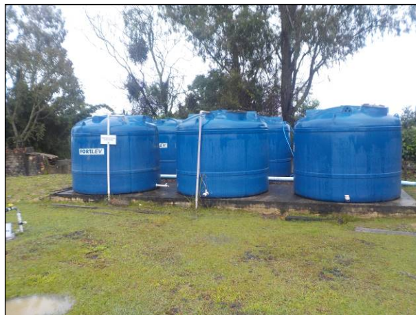
Figura 88: Vista dos Reservatórios Auxiliares, capacidade de armazenamento de 80 m 3 .
