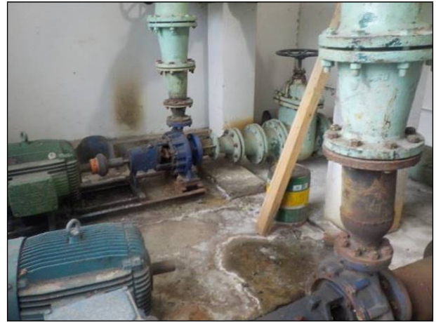
Figura 46: Imagem da ERAT ETA, equipamentos em condições satisfatórias.
