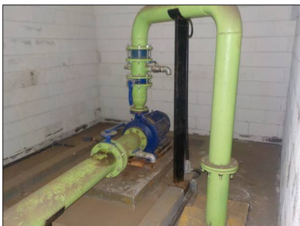
Figura 49: Vista interna da ERAT Motor Intermediário, condições satisfatórias.
