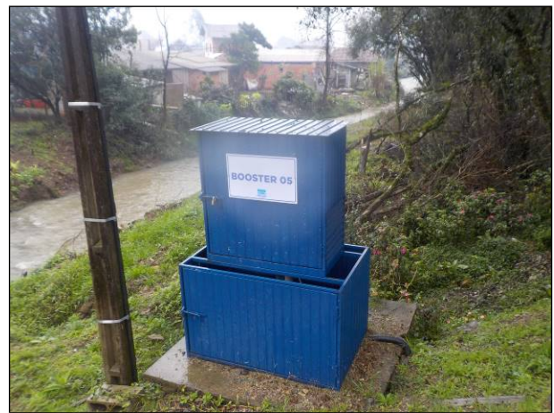
Figura 66: Vista do booster 05, na rua José Reva, boa estrutura incluindo placa de identificação e cadeado.
