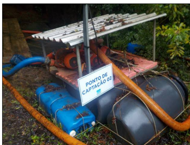
Figura 14: Vista em detalhe dos equipamentos protegidos da captação no rio São Pedro, local dentro do terreno da ETA Papanduva. Placa em conformidade.
