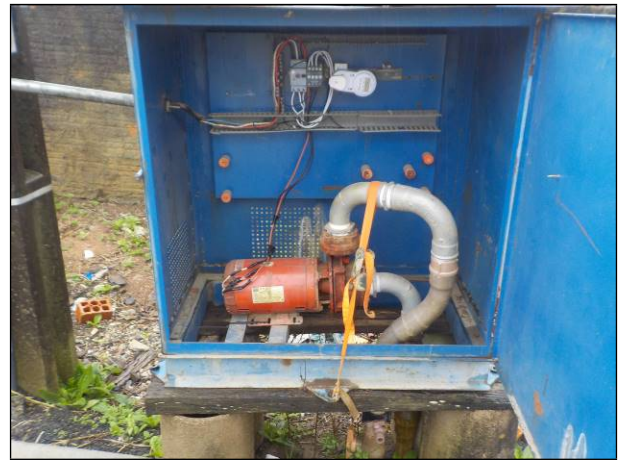
Figura 64: Vista interna do booster 04, condições satisfatórias do equipamento para recalque da água tratada.
