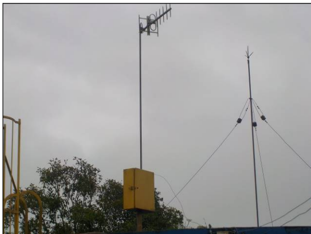
Figura 87: Vista em detalhe da estrutura para monitoramento remoto da unidade, condições satisfatórias.
