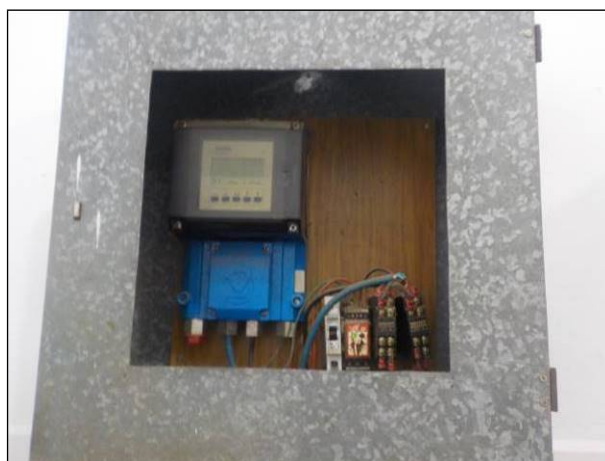
Figura 38: Equipamento disponível na ETA Papanduva, condições satisfatórias.
