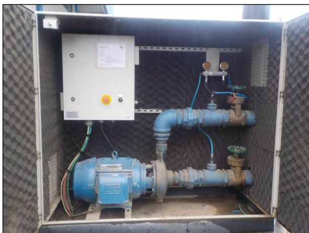
Figura 55: Vista do motorbomba disponível na unidade booster 01, boas condições.
