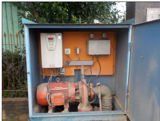
Figura 70: Vista do booster 06, boas condições de funcionamento.
