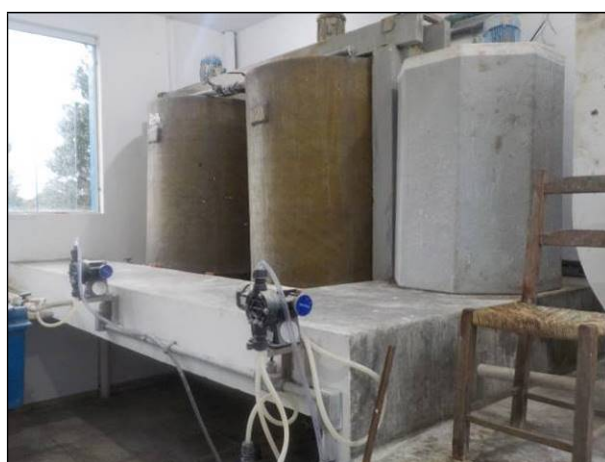
Figura 36: Equipamentos de mistura dos produtos químicos para tratamento da água e bom bombas dosadoras em bom estado na ETA Papanduva.
