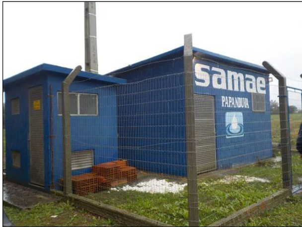
Figura 47: Vista externa da ERAT Motor Intermediário, cercamento e pintura adequados.
