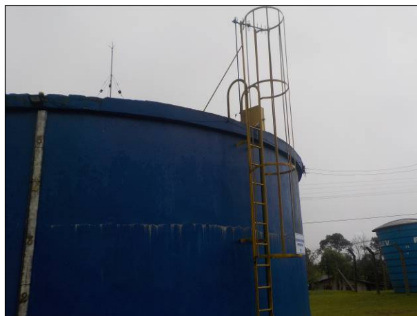
Figura 86: Detalhe da escada de acesso à parte superior do Reservatório Principal, guarda-corpo adequado embora não haja esta segurança na parte superior da unidade, até o ponto de acesso interno
