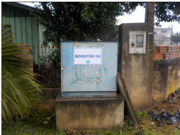
Figura 69: Vista do booster 06, placa informativa e cadeado adequados e condições insatisfatórias na estrutura, incluindo limpeza do entorno e pintura da unidade.
