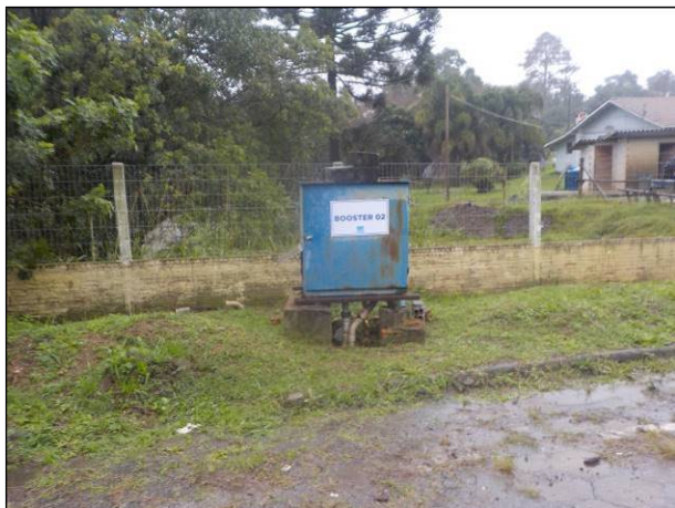
Figura 57: Vista do booster 02, estrutura em condições insatisfatórias disposta na rua Mafra.
