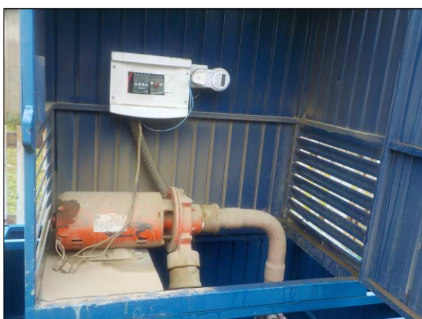
Figura 77: Vista da estrutura interna da unidade booster 08, condições satisfatórias e em funcionamento.
