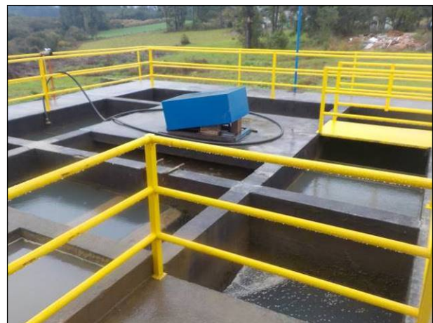
Figura 30: Vista de parte da ETA, denominada ETA 1, boas condições para operação.
