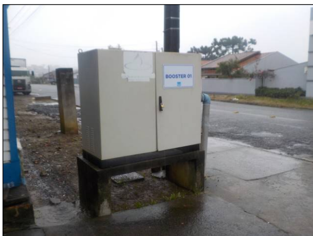
Figura 53: Vista externa frontal do booster 01, identificada e protegida, situada na esquina das ruas Jorge Lacerda e José Zadorosny.
