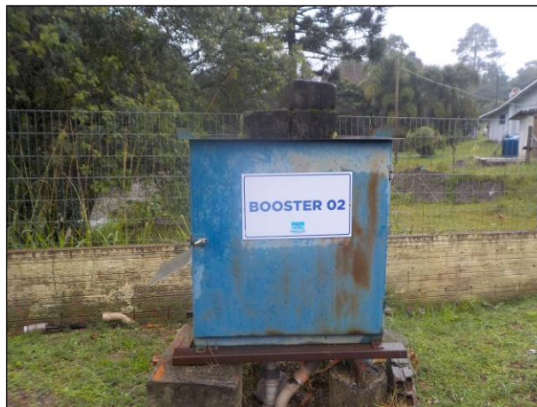
Figura 58: Vista do booster 02, placa indicativa e cadeado instalado adequadamente, embora a condição da estrutura esteja inadequada.
