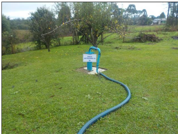
Figura 9: Vista do Poço 01 localizado no mesmo terreno da ETA, unidade desprotegida em seu entorno próximo.
