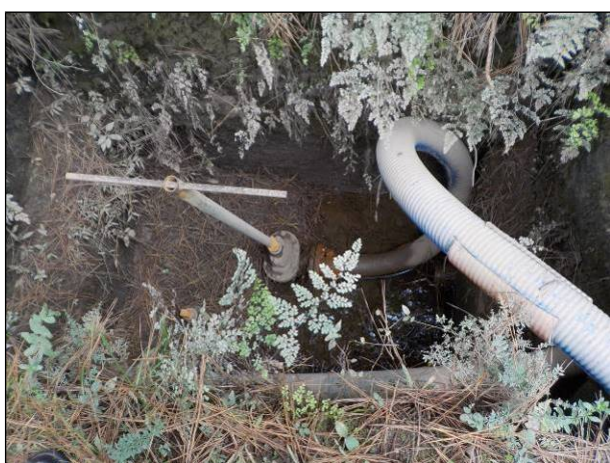
Figura 23: Equipamentos disponíveis na captação 01, satisfatório.
