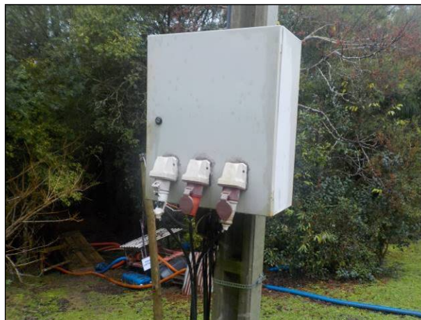
Figura 16: Instalação elétrica para o funcionamento da captação de água bruta no ponto 02, rio São Pedro.
