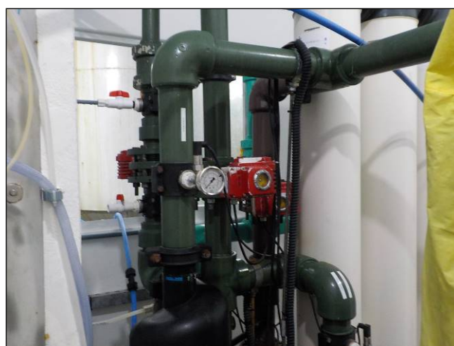
Figura 28: Unidade de Ultrafiltração em funcionamento e com a estrutura em perfeito estado.
