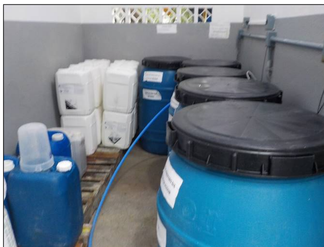
Figura 34: Local de armazenagem dos produtos utilizados no tratamento da água. Área coberta, ventilada e com paletes, adequado
