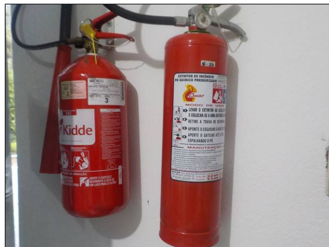
Figura 6: Equipamentos para extinção de incêndio disponíveis no escritório, pressurizados e com manutenção adequada.
