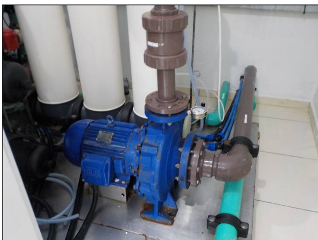
Figura 29: Vista da unidade de Ultrafiltração em funcionamento e com seus componentes em perfeito estado de conservação.
