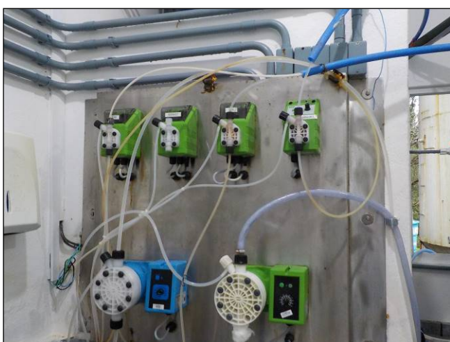
Figura 27: Vista da unidade de Ultrafiltração em funcionamento e com seus componentes em perfeito estado.
