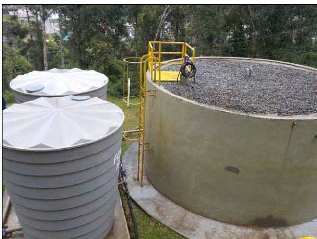
Figura 41: Vista dos reservatórios R1, R2 (20 m³) e R3 (20 m³), estrutura adequada de todos, incluindo a escada de acesso, guardas-corpos, escada e área de cobertura.
