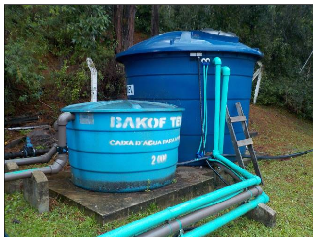
Figura 30: Tanque de contato, ao fundo, de 10 m³ utilizado no tratamento da água bruta na ETA Angelina.
