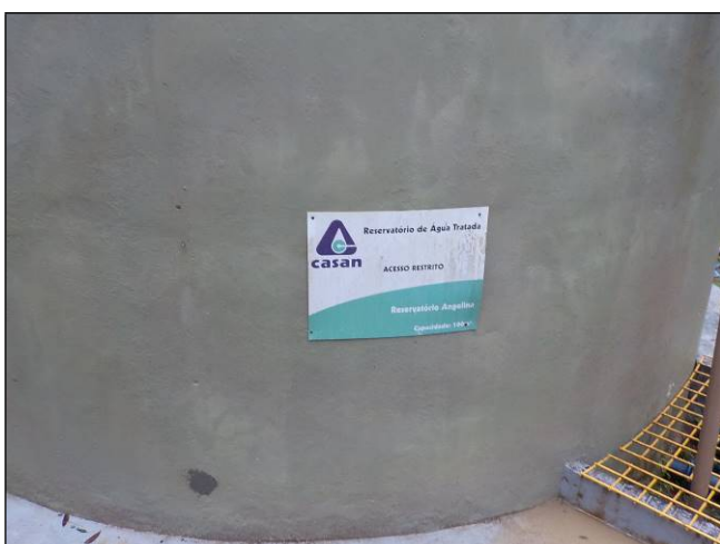
Figura 39: Placa do reservatório R1 afixada na unidade adequadamente.
