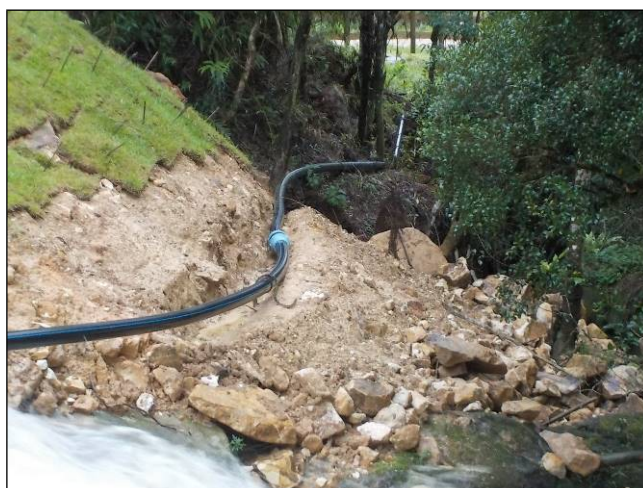
Figura 18: Vista detalhada da adutora de água bruta disponível no rio Vargem dos Pinheiros, transportando água por gravidade.
