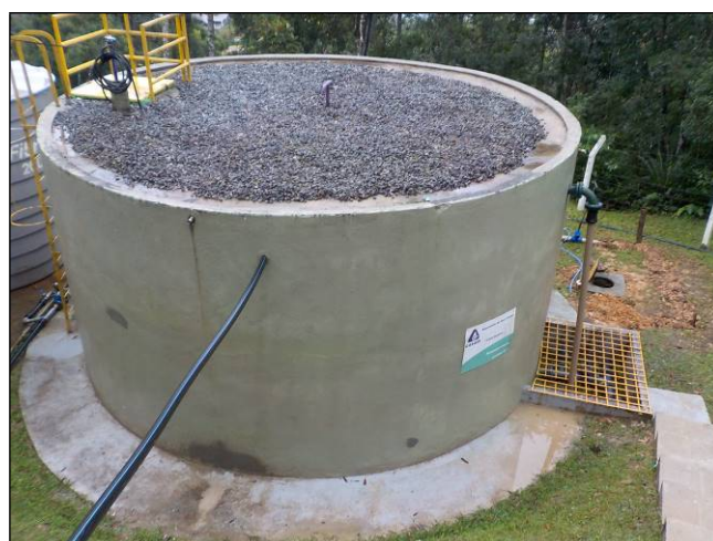
Figura 40: Vista geral do reservatório R1 (100 m³), parte superior e lateral sem problemas estruturais identificados.
