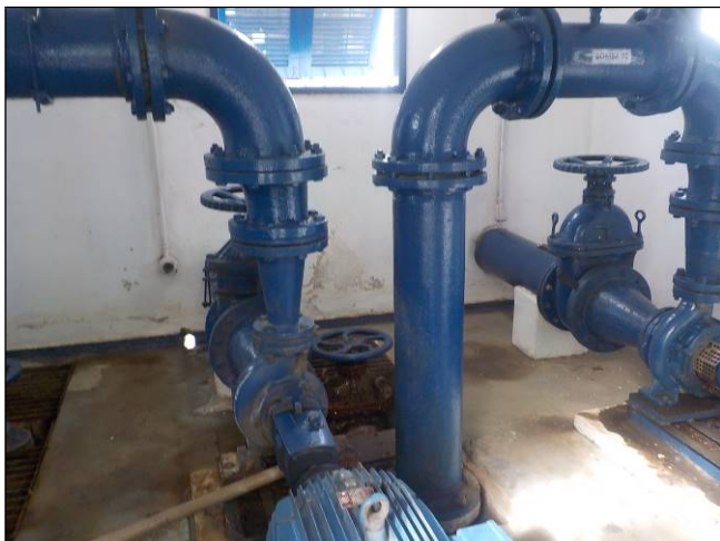
Figura 17: Vista das bombas na ERAT FUCAP, incluindo uma reserva não instalada.
