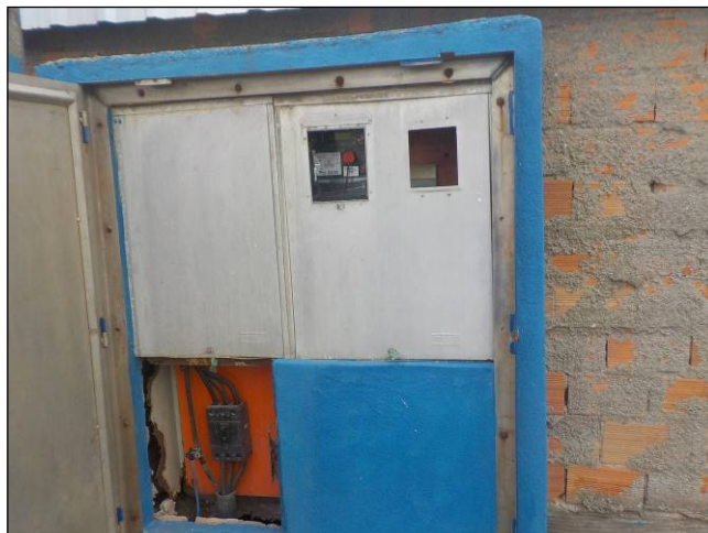
Figura 30: Painel elétrico da ERAT Paraíso, condição da estrutura não é adequada.
