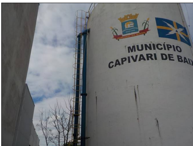
Figura 33: Reservatório R1 (330 m 3 ) com alguns pontos de vazamento aparentes, necessário fazer manutenção na unidade. Escadas e iluminação adequadas.
