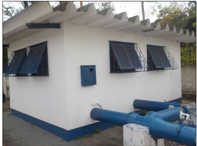
Figura 14: Estrutura que comporta a ERAT FUCAP, boas condições estruturais.
