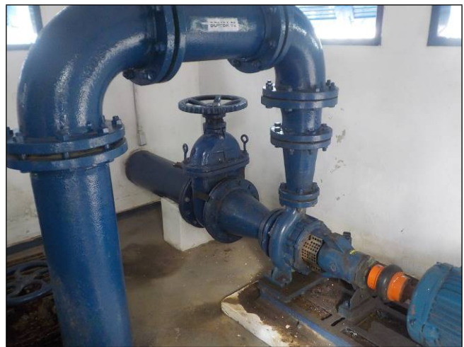
Figura 16: Bomba de recalque disponível e em uso na ERAT FUCAP. Alta vibração e som alto na área externa próxima ao equipamento.
