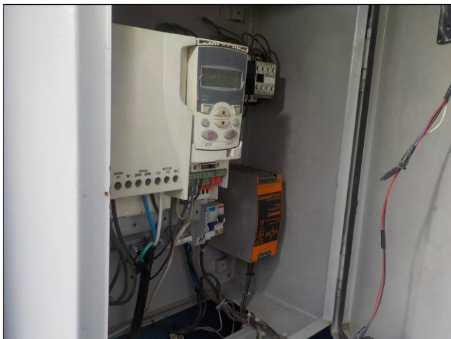
Figura 23: Painel de controle da unidade booster Santa Lúcia, condição adequada.
