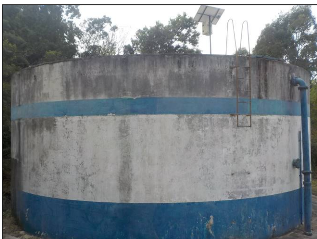
Figura 37: O reservatório R3 possui monitoramento remoto auxiliado pela placa solar disposta em sua cobertura. A escada de acesso e a pintura da unidade estão precárias.
