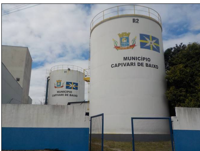
Figura 31: Reservatório R1 (ao fundo) e R2, localizados no mesmo terreno que a ERAT Paraíso. Portão e pintura adequados.
