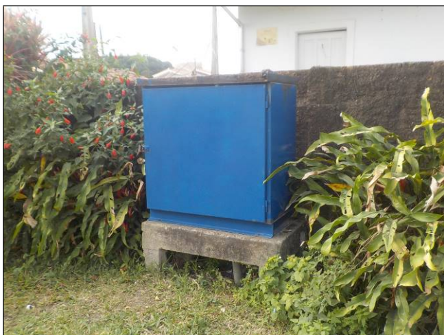
Figura 21: Vista da estrutura externa que comporta o booster Santa Lúcia, sem informação e restrição sobre a unidade, inadequado.
