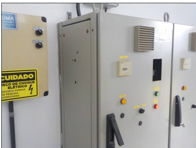
Figura 27: Painel de controle e equipamento de monitoramento remoto disponíveis na unidade, adequados.
