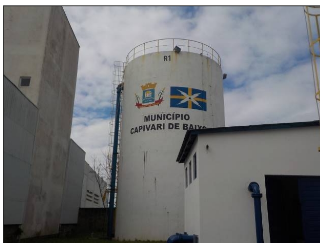
Figura 32: Vista da estrutura que comporta a ERAT Paraíso em primeiro plano (a direita) e reservatório R1 identificado.
