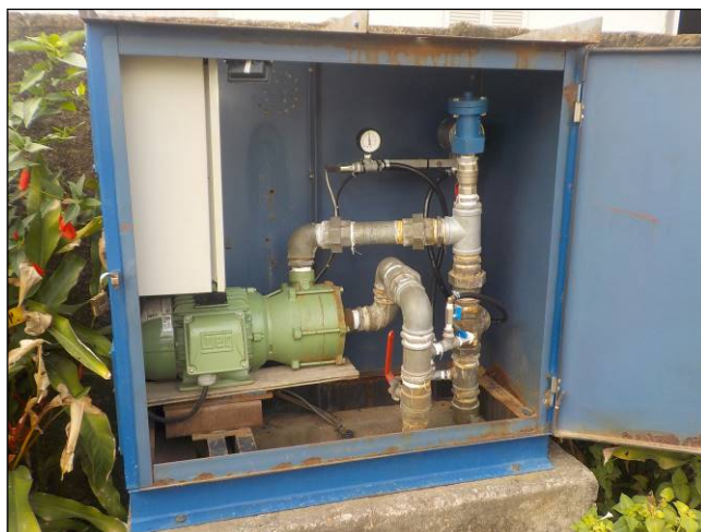
Figura 22: Bomba de recalque disponível no booster Santa Lúcia, estrutura em boa condição. Há bomba reserva no almoxarifado.
