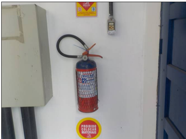
Figura 29: Equipamento para extinção de incêndio disponível no local adequadamente.
