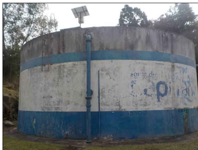
Figura 38: Pintura precária e possíveis pontos de vazamento na unidade que não passou por limpeza interna no último ano por ter estrutura frágil, segundo informação coletada na visita.
