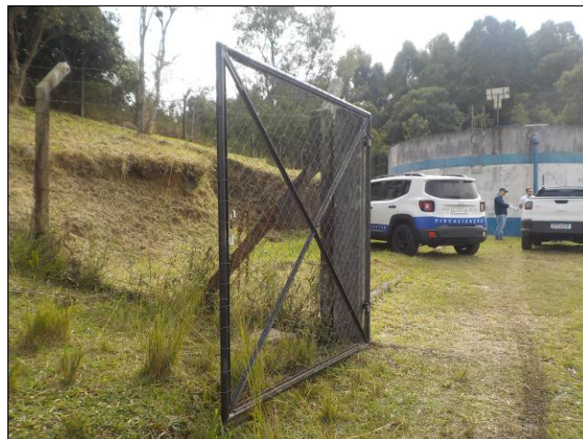
Figura 36: Portão e cercamento de entrada em condições satisfatórias, embora o local seja utilizado como passagem de populares. Sem placas de advertência e deficiência proteção física por cercas.
