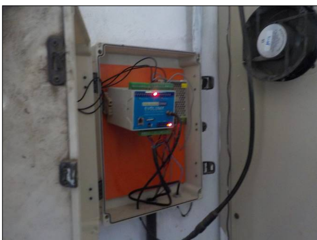
Figura 19: Equipamento que permite o acompanhamento remoto da ERAT FUCAP, em funcionamento adequado.
