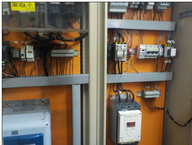
Figura 18: Vista interna do painel de controle da ERAT FUCAP, adequado
