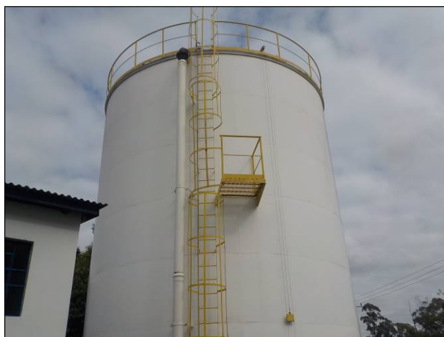
Figura 34: Reservatório R2 (500 m 3 ) com escada, nível e pintura adequadas. Sem informação sobre as limpezas internas. Existe monitoramento remoto.
