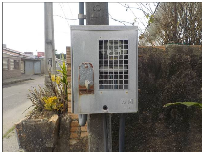
Figura 24: Quadro elétrico disponível para o booster Santa Lúcia.
