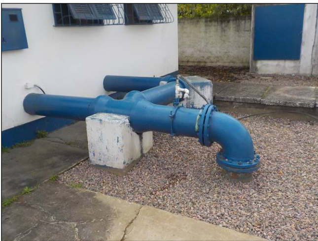
Figura 15: Vista da adutora de água tratada no local.
