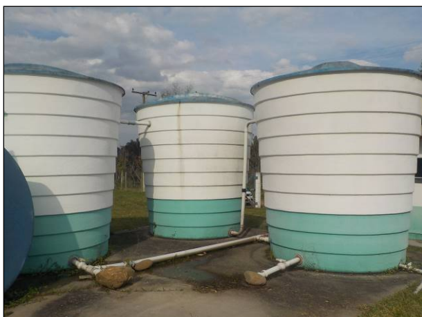
Figura 35: Reservatório R-02 contendo 3 unidades de reservação de 20 m 3 cada, uma quarta unidade está em conserto.
