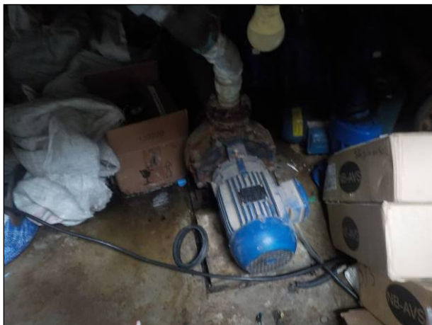
Figura 19: Vista da ERAT, localizada em piso inferior da ETA. No momento, a unidade estava cercada por equipamentos do almoxarifado e por água, próximo de submergir. Local inadequado para o equipamento.
