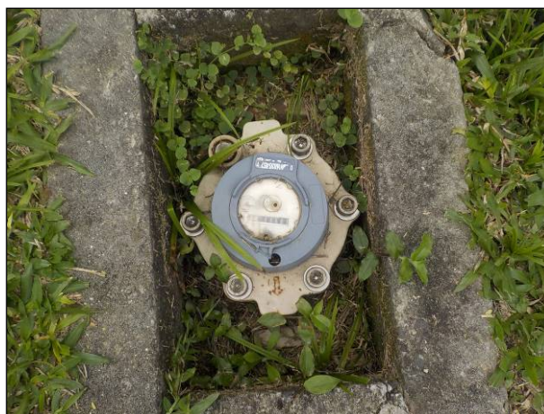
Figura 18: Vista do macromedidor de vazão disponível na entrada do reservatório, boa condição. A unidade possui sistema supervisorio online (telemetria).
