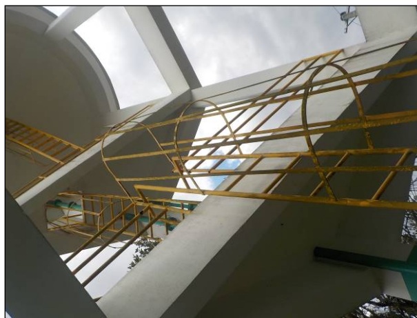
Figura 22 Vista da escada de acesso ao Reservatório R-01, estrutura adequada para o acesso de trabalhador.
