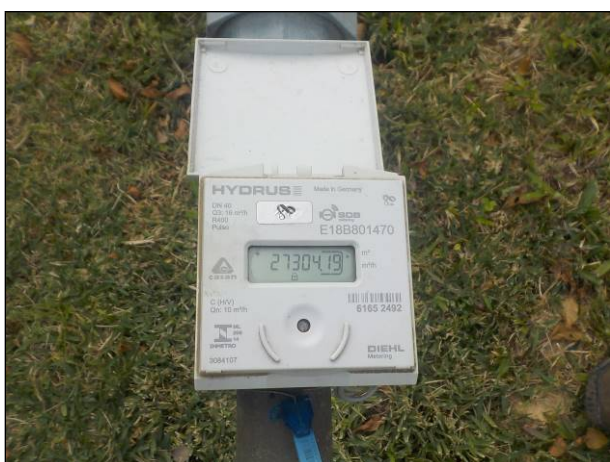
Figura 29: Macromedidor de vazão indicando 27,3 m 3 /h na saída do poço. Há acompanhamento pelo sistema supervisorio (telemetria).
