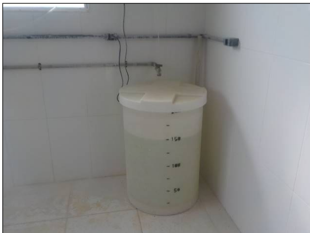
Figura 31: Vista de recipiente contendo a mistura de produtos químicos para o tratamento da água na ETA Vila Santa Catarina.
