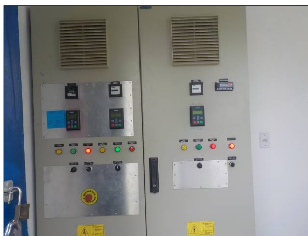
Figura 34: Painel de controle disponível, em funcionamento e satisfatório.
