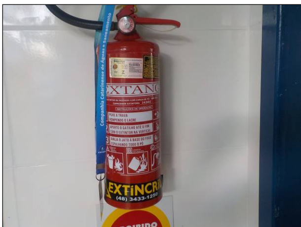
Figura 17: Cilindro contendo pó químico extintor de incêndio em boas condições de uso (pressão, lacre e casco) na ETA São João do Sul.
