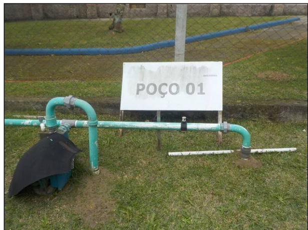
Figura 10: Captação denominada Poço 01, sendo uma das ponteiros de captação de água subterrânea disponível no local.
