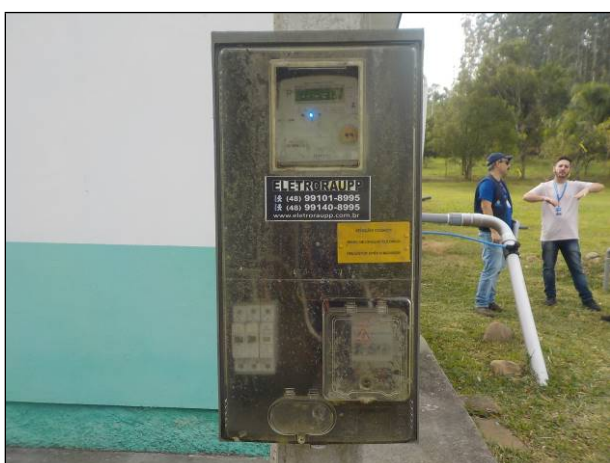
Figura 27: Vista do medidor de energia elétrica, condição satisfatória de funcionamento, sendo necessária colocação de lacre de proteção no local.
