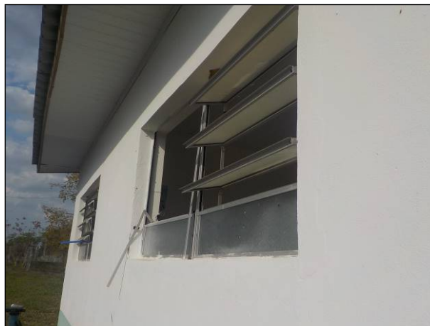
Figura 26: Vista da janela danificada nos fundos da edificação, o que pode ocasionar problemas na unidade. Condição insatisfatória de segurança.
