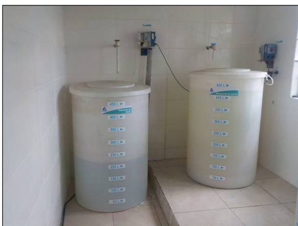
Figura 15: Dosadores e equipamentos para o tratamento da água disponíveis na ETA Central de São João do Sul.
