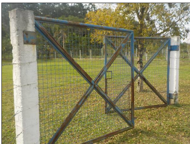
Figura 23: Portão de acesso a unidade do SAA São João do Sul em Vila Santa Catarina, não há placa indicativa do funcionamento da unidade.
