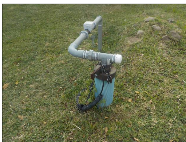
Figura 28: Poço 1, disponível para captura de água subterrânea no local, satisfatório.
