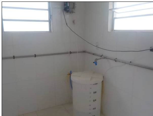
Figura 32: Vista de recipiente com mistura de produtos químicos para tratamento da água na ETA Vila Santa Catarina (UTS).
