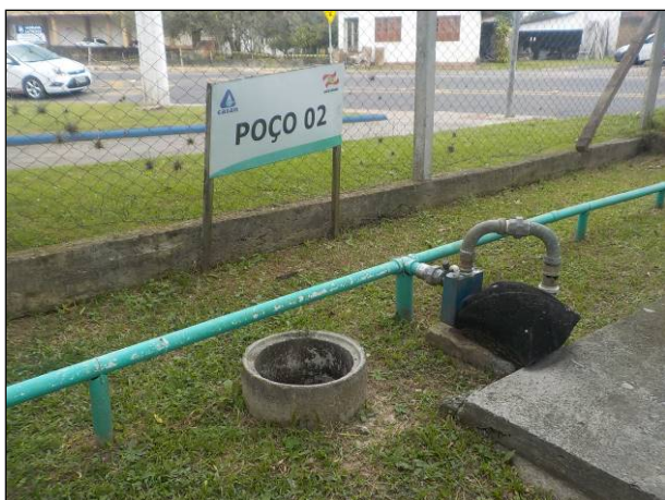
Figura 11: Captação denominada Poço 02, ponteira de captação de água subterrânea.
