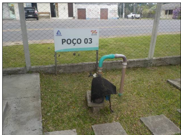
Figura 12: Captação denominada Poço 03, ponteira de captação de água subterrânea.
