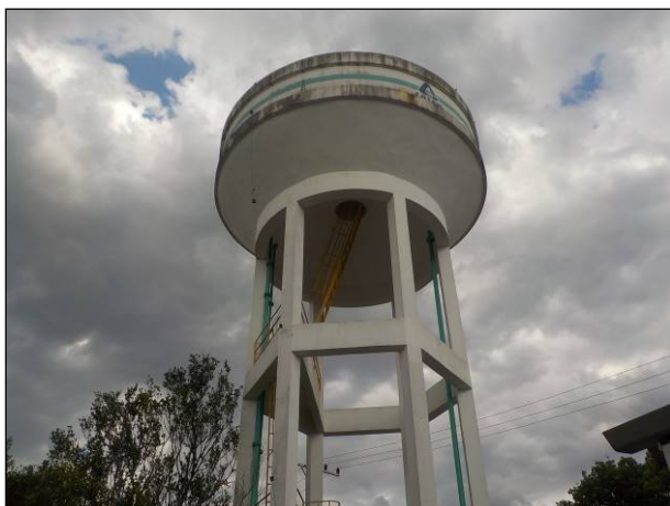
Figura 21: Reservatório R-01, capacidade de reserva de 100.000 litros de água tratada. Placa informativa esmaecida, impossibilitando a leitura, além pintura descascando ou umedecida. Condição pouco satisfatória.
