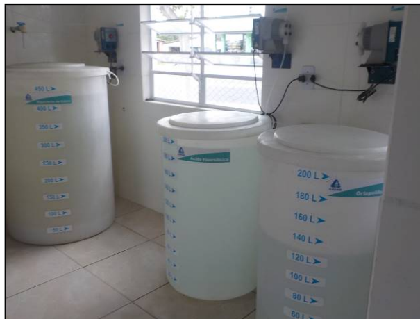
Figura 14: Dosadores e equipamentos para o tratamento da água disponíveis na ETA Central de São João do Sul.
