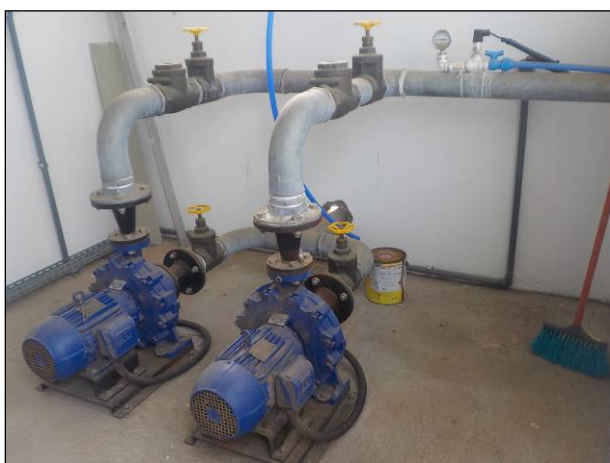
Figura 33: Bombas disponíveis para recalque da água tratada, uma das bombas instaladas é reserva. Satisfatório.
