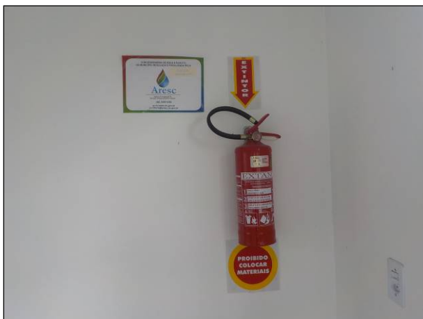
Figura 5: Vista de um dos equipamentos para extinção de incêndio disponível no Escritório. Ao lado, cartaz indicativo da reguladora.
