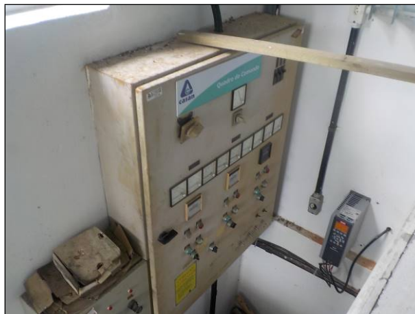
Figura 20: Painel de controle da bomba de recalque de água tratada, em local junto à ETA São João do Sul, o equipamento está com sua estrutura externa com ferrugem e insegura. Condição pouco satisfatória.
