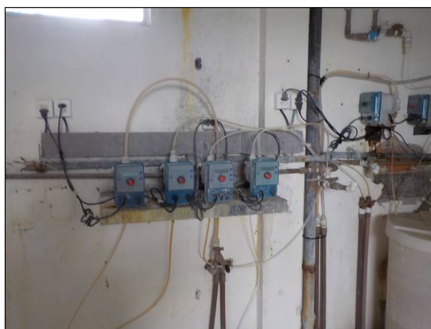
Figura 34: Aparelhos dosadores de produtos químicos que funcionam com programação prévia, sendo suficiente rápida supervisão dos operadores.
