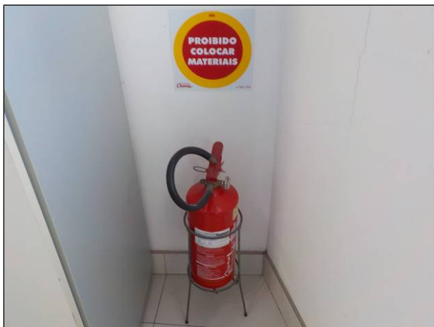
Figura 9: Vista de um dos equipamentos para extinção de incêndio disponível no escritório de atendimento, pressurizado, em local adequado e contendo placa indicativa.
