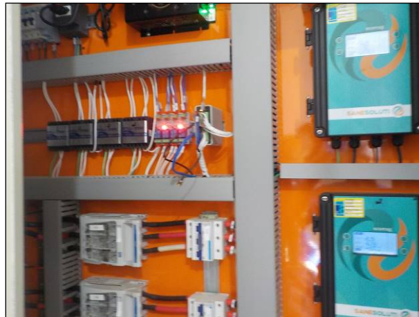
Figura 48: Parte do painel de controle disponível junto à ERAT 02.
