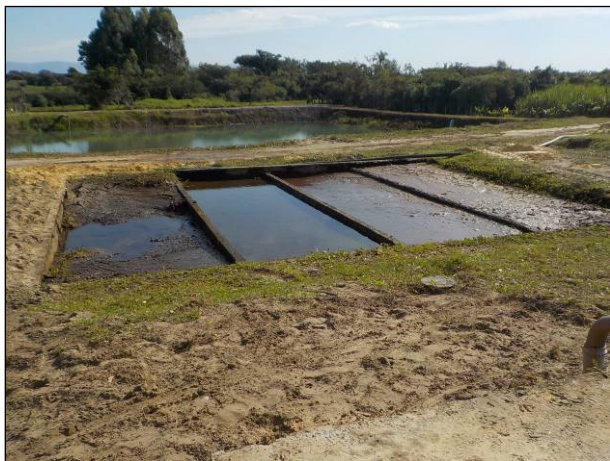
Figura 23: Vista do leito de secagem, boa estrutura, localizado junto à lagoa de estabilização.
