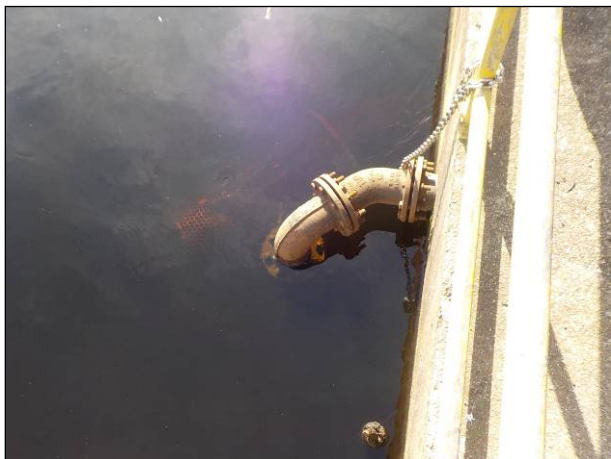
Figura 17: Ponto de captura da água bruta no manancial superficial, adequado.
