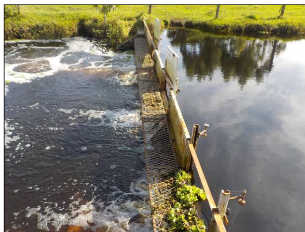
Figura 16: Vista do barramento para manutenção de volume de água para captura no córrego Estiva dos Rodrigues, estrutura adequada e conservada. Novo aerador instalado.
