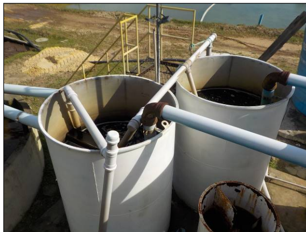
Figura 30: Vista superior das unidades de filtração pertencentes ao processo de tratamento da água bruta no módulo I da ETA Passo de Torres.
