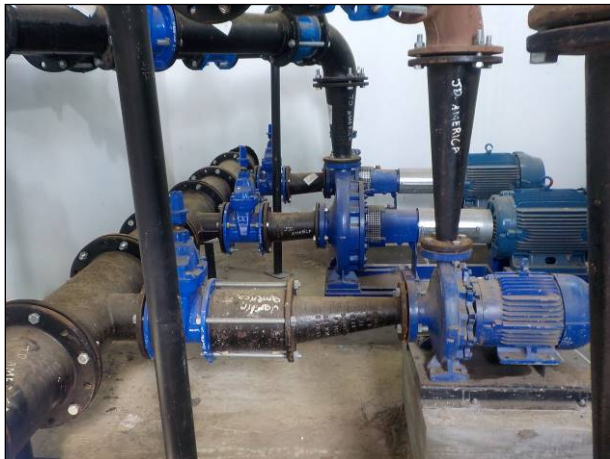
Figura 47: Vista geral da ERAT 02, equipamentos adequados e em operação.
