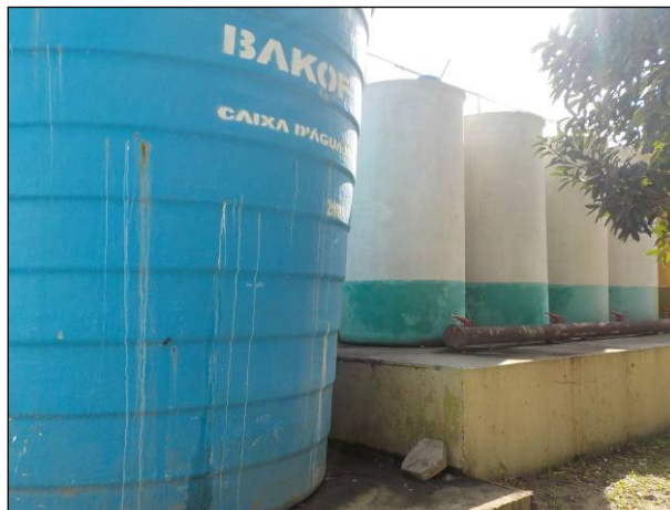
Figura 24: Vista do lado oposto de parte da ETA Passo de Torres, estrutura adequada, sem comprometimento da estrutura.
