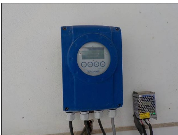
Figura 33: Aparelho medidor de vazão de saída da água tratada disponível no local. Há acompanhamento remoto da unidade. A vazão de entrada é feita por Calha Parshall.
