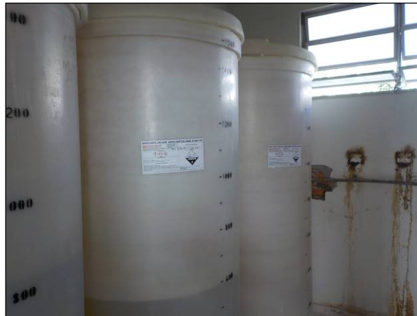
Figura 36: Local adequado para o armazenamento dos produtos químicos misturados para uso no tratamento da água bruta na ETA Passo de Torres.
