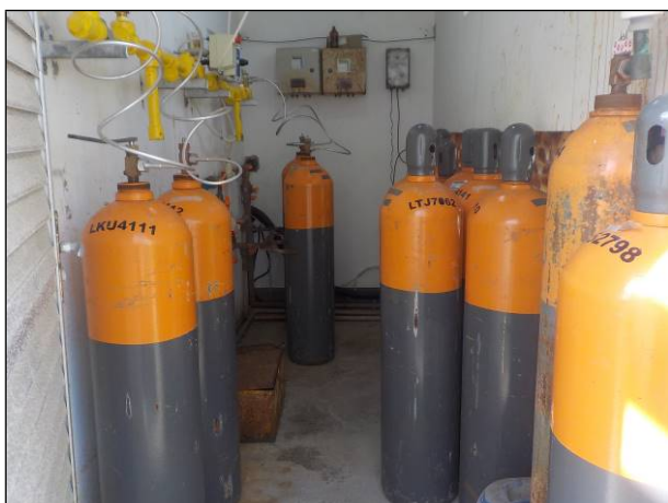
Figura 37: Cilindros contendo produto para desinfecção utilizado no tratamento da água na ETA Passo de Torres. Satisfatório.
