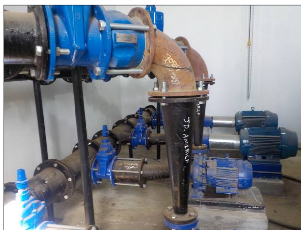
Figura 46: Vista da ERAT 02, nas dependências da ETA, contendo três bombas, uma reserva.
