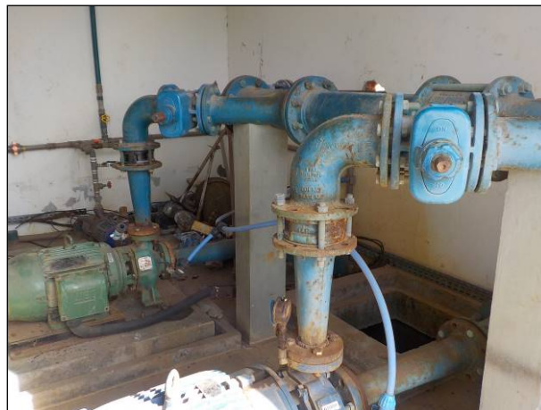
Figura 44: ERAT 01 e suas bombas instaladas, incluindo a reserva. O recalque desta é para o Reservatório 04.
