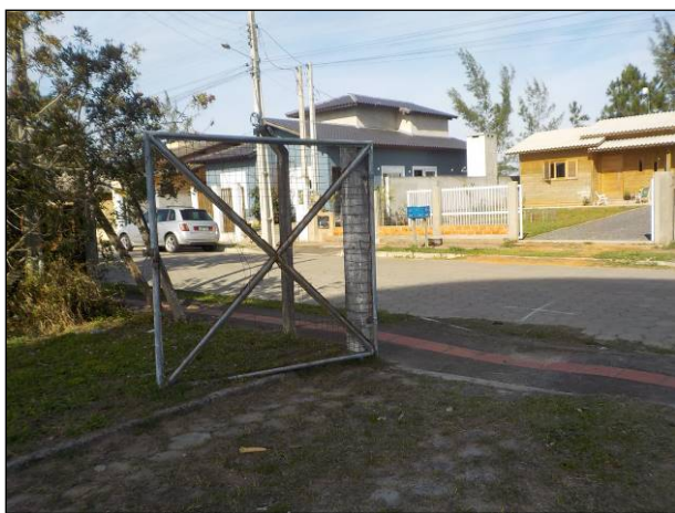
Figura 49: Portão de entrada do reservatório 01, sem placa de identificação e restrição de acesso.
