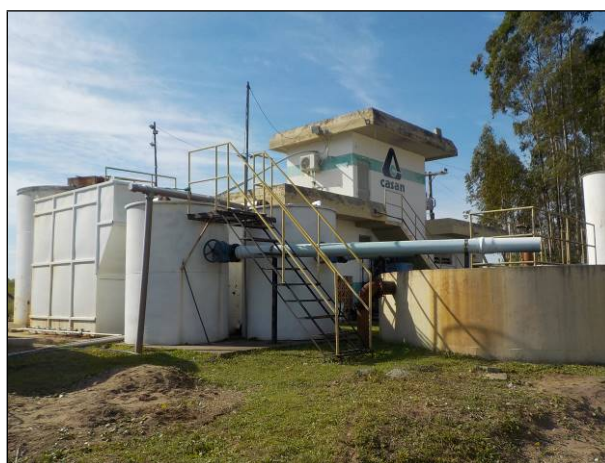
Figura 20: Vista de um dos módulos (módulo I) disponíveis na ETA Passo de Torres, capacidade máxima de tratamento de 8 L/s, em funcionamento e estrutura em condição satisfatória.
