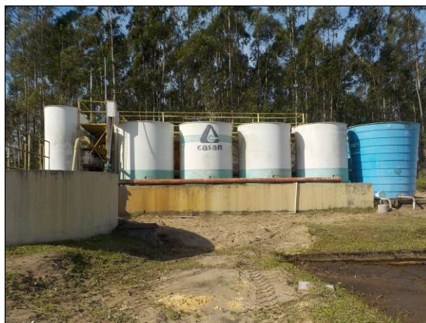
Figura 22: Vista do leito de secagem, em primeiro plano e à direita, junto ao módulo maior de tratamento na ETA Passo de Torres. Estrutura adequada.
