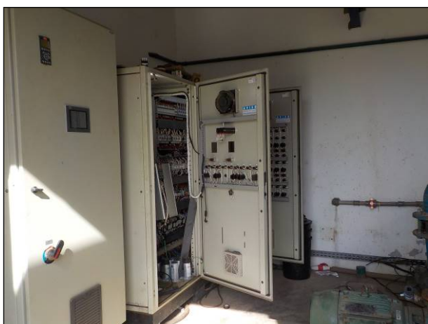
Figura 45: Quadro de comando da ERAT 01, adequado.
