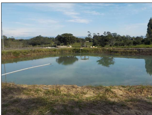
Figura 19: Vista geral da lagoa de estabilização de 5.000 m 3 , no momento da visita em período de teste de estanqueidade e estabilidade, isto após um de seus taludes desmoronar em momento anterior. Previsão de entrada em operação em novembro/23.
