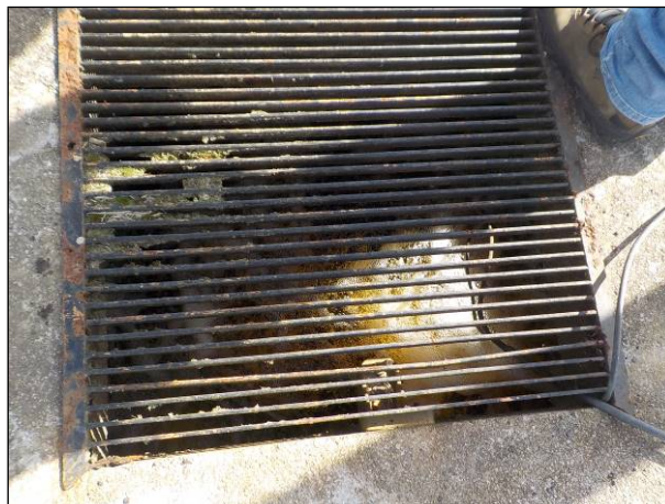
Figura 18: Vista do local onde é recalçada a água bruta para a ETA passo de Torres, adequado. Há uma bomba reserva no almoxarifado.
