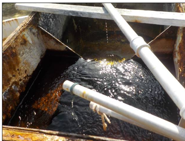
Figura 28: Local, na ETA Passo de Torres, onde são dosados os produtos químicos para posterior coagulação e floculação.
