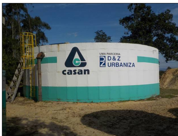
Figura 56: Vista parcial do Reservatório 04, com capacidade para armazenar 300 m 3 de água tratada, estrutura adequada.
