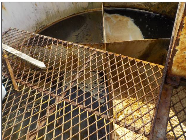
Figura 29: Estrutura para a floculação no tratamento da água no módulo I, adequada.
