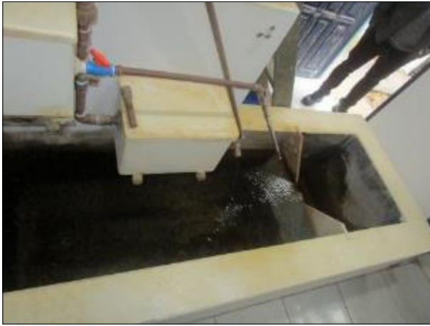
Figura 7: Vista detalhada do tratamento na ETA de São Martinho.
