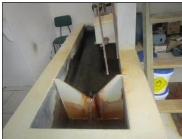
Figura 6: Vista da calha onde a água bruta recebe os produtos químicos para o tratamento.
