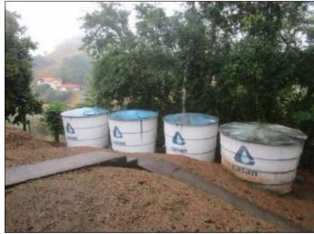
Figura 8: Vista da parte externa da ETA de São Martinho onde estão os reservatórios de água tratada.
