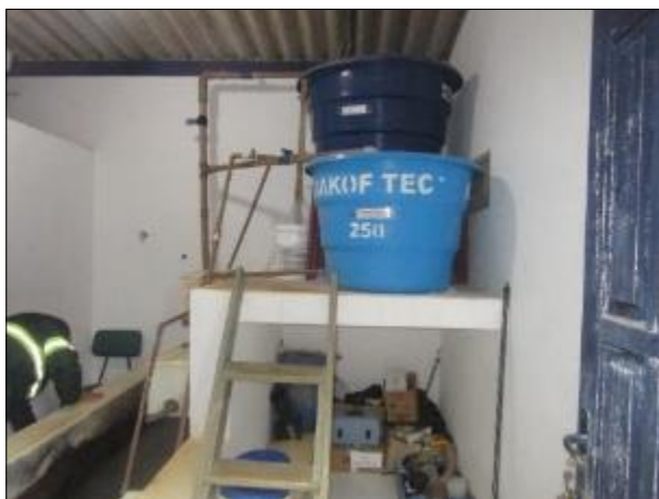
Figura 5: Unidade de tratamento do SAA São Martinho
