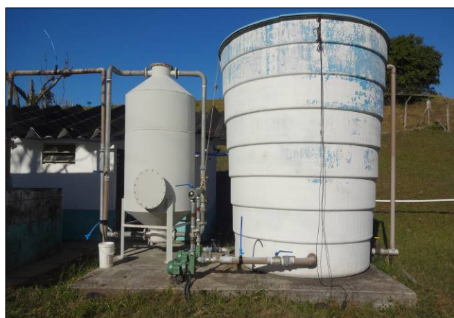
Figura 21: A esquerda, unidade de filtração.
