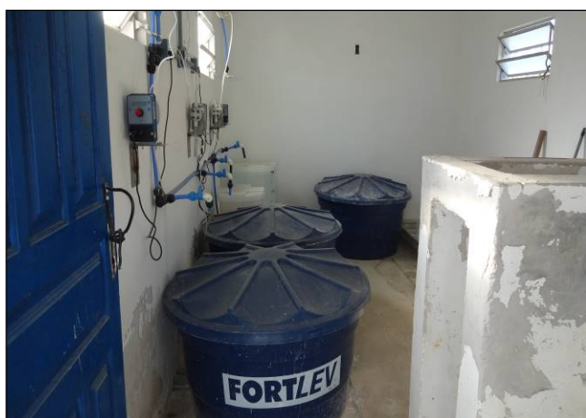
Figura 20: Bombas dosadoras de produtos químicos.
