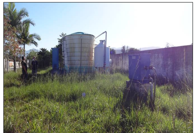
Figura 13: Vista da ETA Areias.
