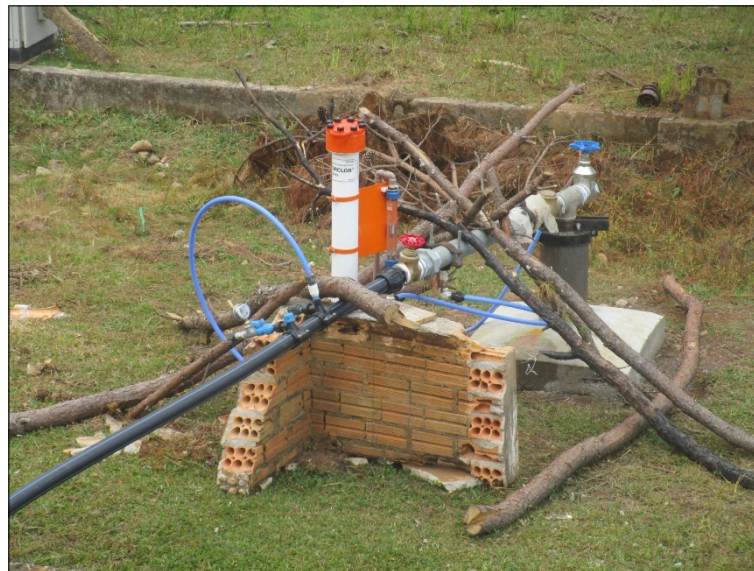
Figura 9: Equipamentos instalados no poço particular, utilizado para abastecimento público, para captura da água bruta e tratamento desta antes de envio para a rede pública de distribuição. Poço sem proteção adequada, colocando em risco o abastecimento.
