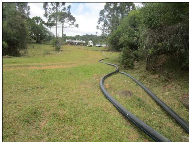
Figura 13: Tubulação ligando o local de captação e a estrutura de enchimento dos reservatórios dos caminhões-pipa.
