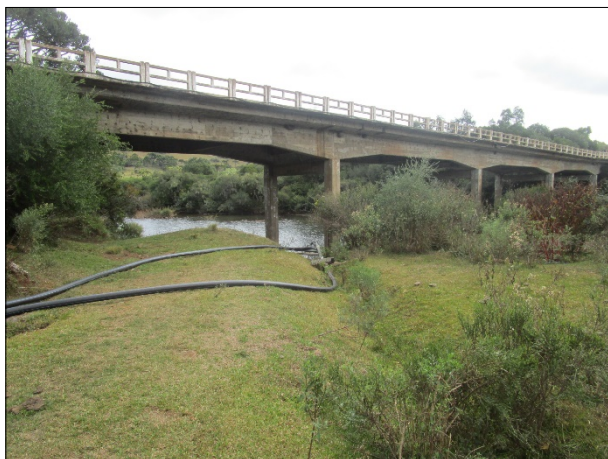
Figura 12: Parte da tubulação próxima ao rio Lava-Tudo e a ponte sobre a SC-114.
