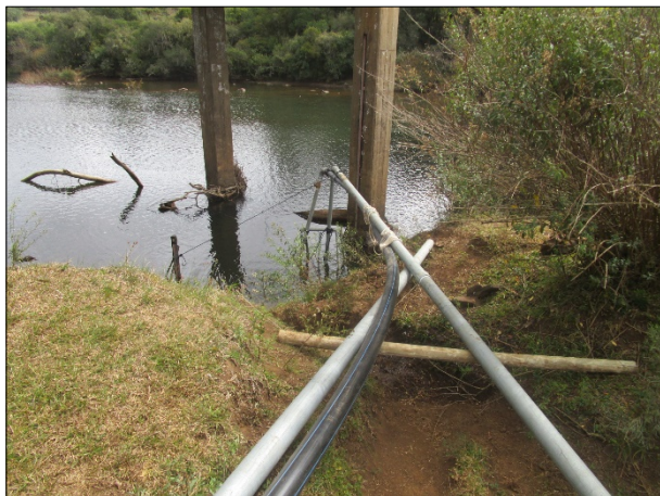
Figura 10: Ponto onde a estrutura externa se liga às bombas de captação de água bruta submersas no rio Lava-Tudo.
