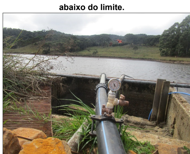
Figura 5: Estrutura ainda mantida, com os instrumentos de medição e tubulação.
