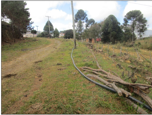
Figura 7: Estrutura instalada para levar a água tratada do poço até a rede de distribuição.
