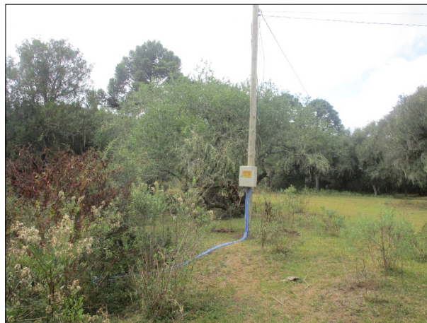
Figura 11: Instalação elétrica exclusiva para as bombas de captação imersas no rio Lava-Tudo.
