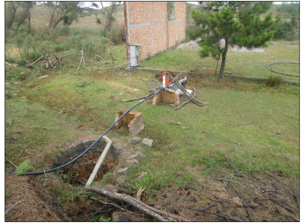
Figura 8: Área do poço e sua estrutura, incluindo nova instalação elétrica, ao fundo, sem proteção adequada, colocando em risco o abastecimento e o indivíduo que se aproximar.
